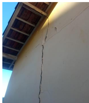
Fissura de cisalhamento
