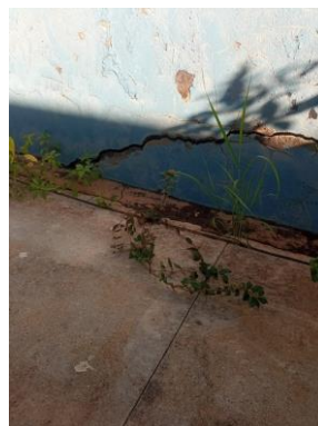
Fissura de cisalhamento em fundações e deslocamento
