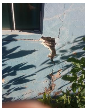
Fissura de cisalhamento
