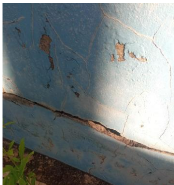
Fissura de cisalhamento em fundações e deslocamento
