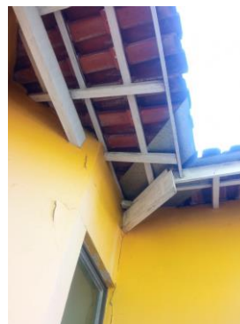
Fissura em aberturas
