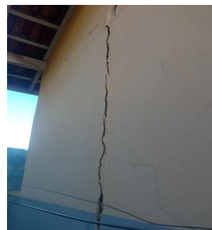
Fissura de cisalhamento
