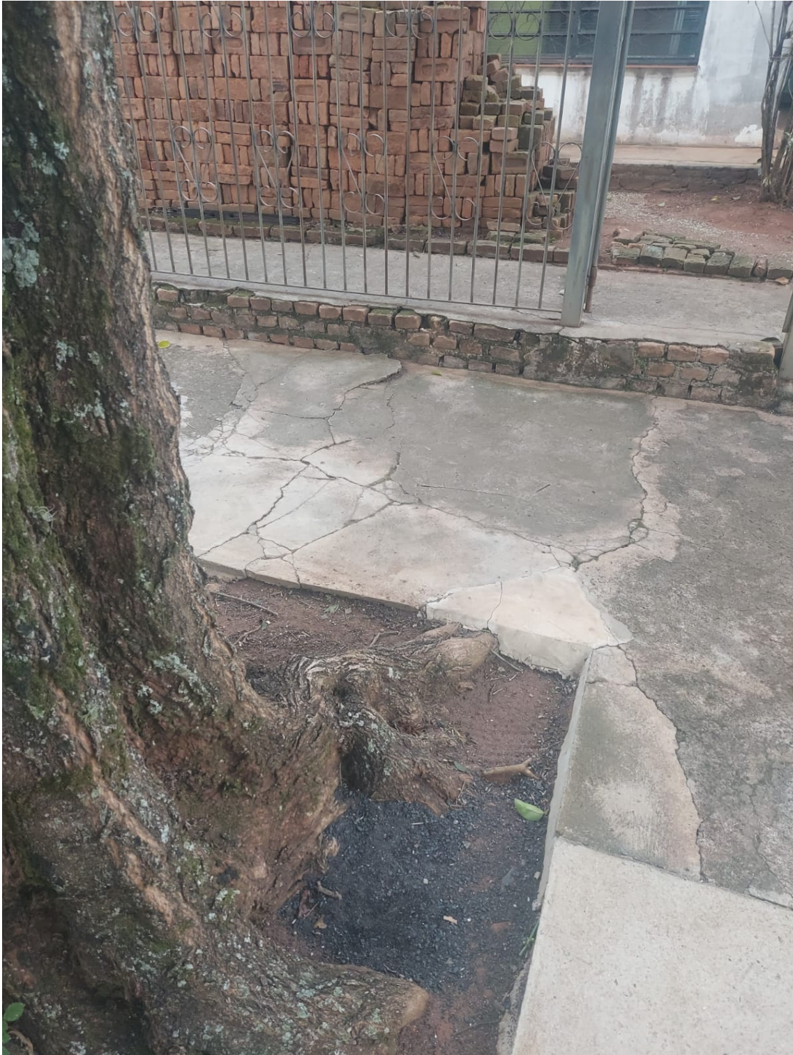
FOTOGRAFIA COMPROVA O ROMPIMENTO DO PASSEIO PÚBLICO EM RAZÃO DAS RAÍZES DA PLANTA
