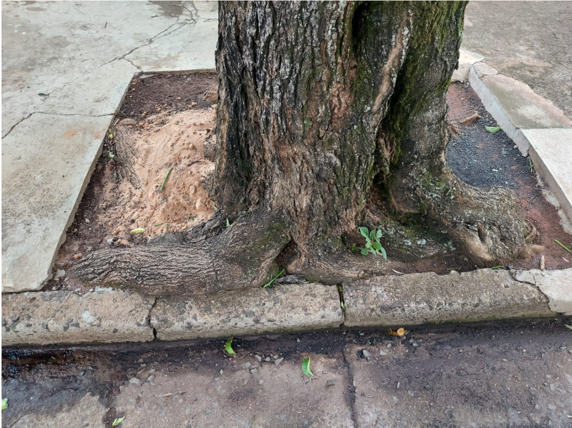
FOTOGRAFIA ÁRVORE OBJETO DO PEDIDO DE REMOÇÃO – PASSEIO PÚBLICO DANIFICADO EM RAZÃO DAS RAÍZES DA PLANTA
