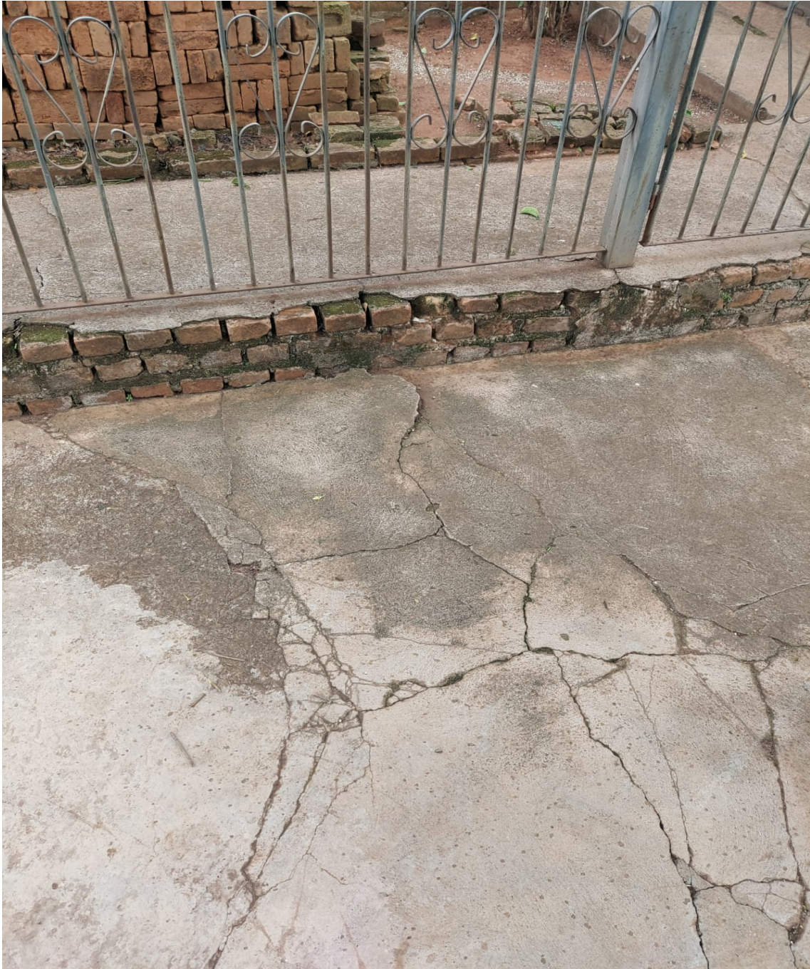
FOTOGRAFIA COMPROVA QUE RAÍZES DA PLANTA ROMPERAM O CALÇAMENTO PÚBLICO
