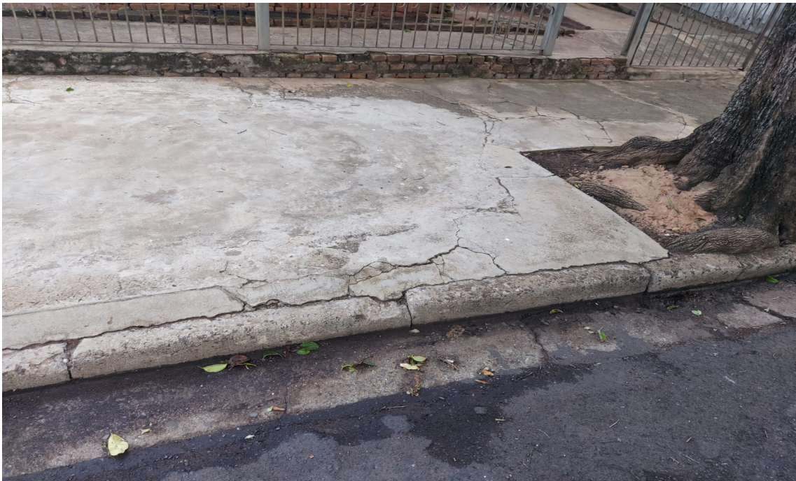
FOTOGRAFIA ÁRVORE OBJETO DO PEDIDO DE REMOÇÃO – PASSEIO PÚBLICO DANIFICADO EM RAZÃO DAS RAÍZES DA PLANTA
