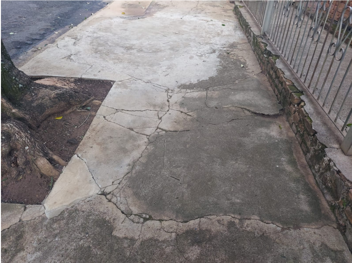
FOTOGRAFIA COMPROVA QUE RAÍZES DA PLANTA ROMPERAM O CALÇAMENTO PÚBLICO
