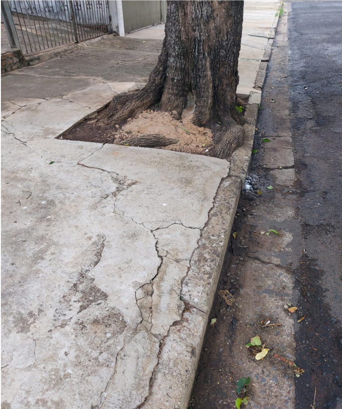
FOTOGRAFIA ÁRVORE OBJETO DO PEDIDO DE REMOÇÃO – PASSEIO PÚBLICO DANIFICADO EM RAZÃO DAS RAÍZES DA PLANTA
