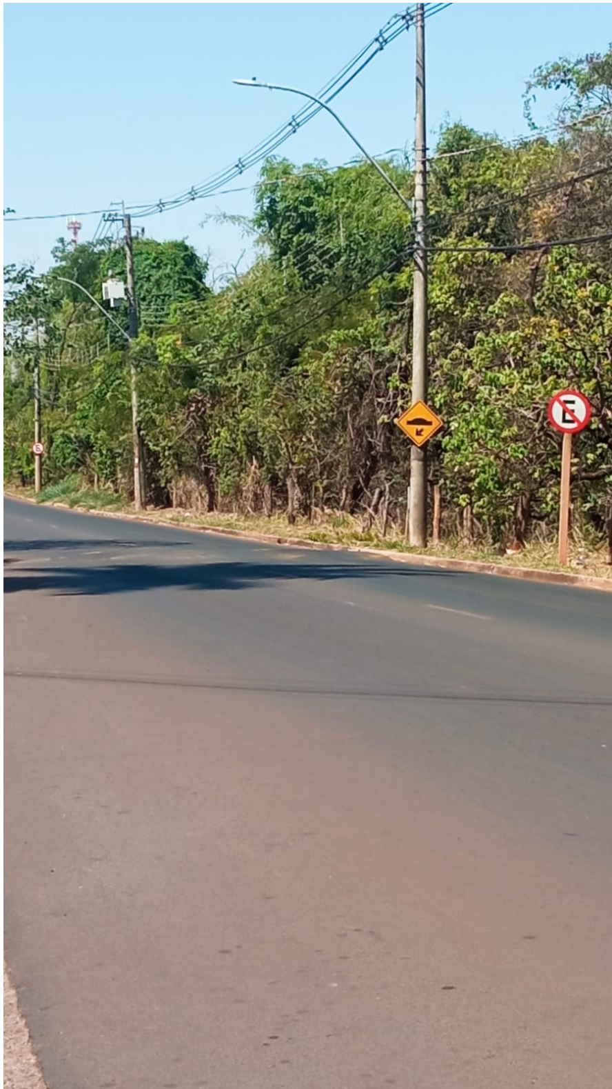
Lombada com pintura desgastada
