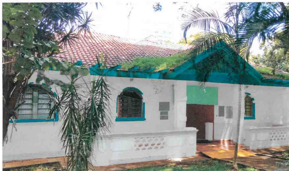
Fachada Leste. Realizar pintura da viga e pérgolas, beiral, frontão e borda das janelas na cor SW 6768.
