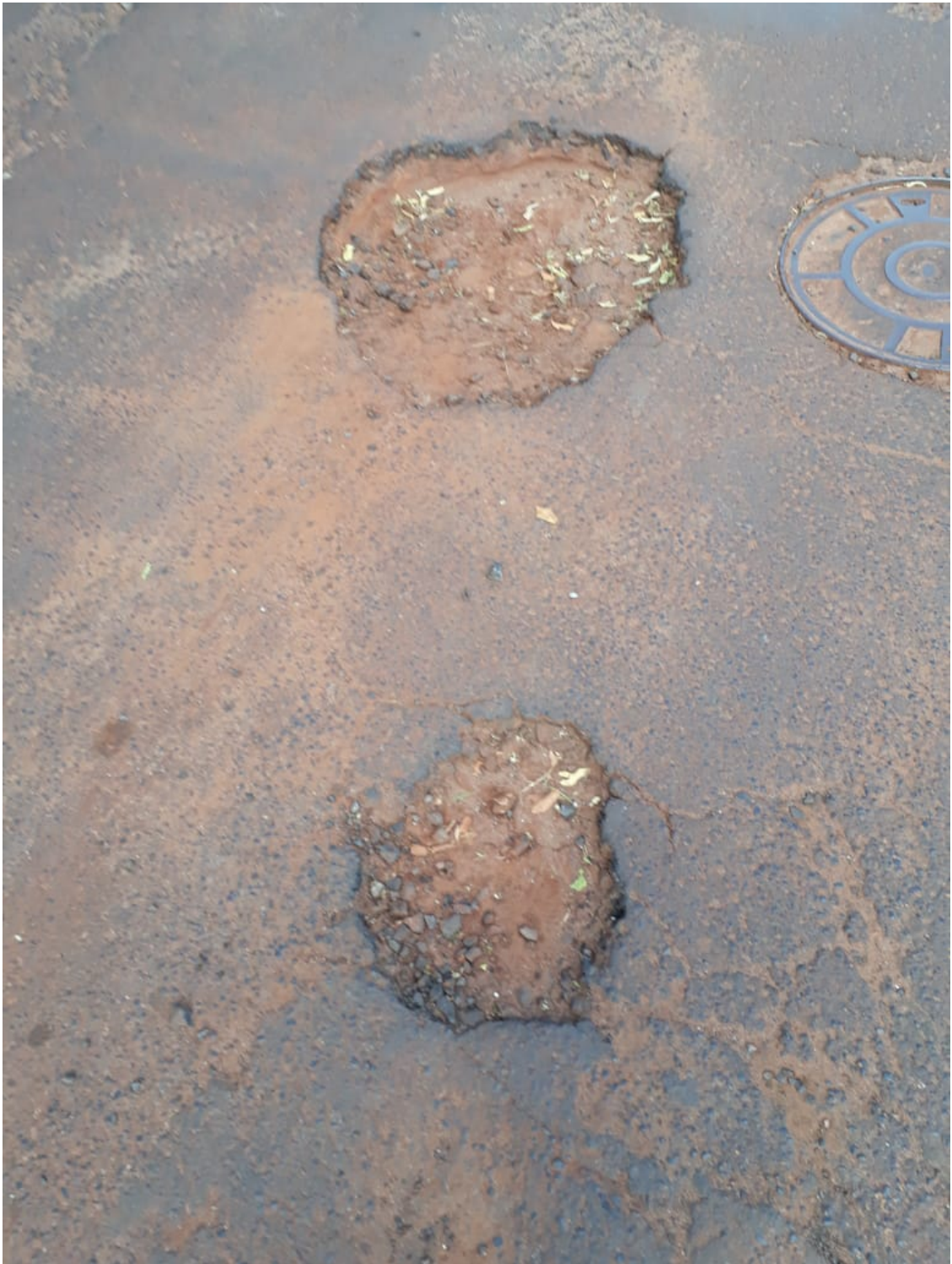
(Diversos buracos espalhados pela rua)
