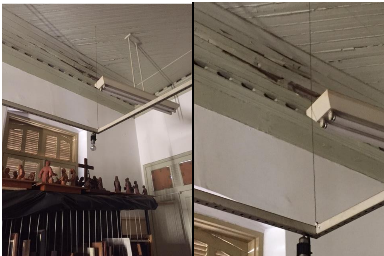
■ Fotos 57 e 58 – Sala 01. As fotos revelam a necessidade de retirada e substituição das janelas, forro. Fonte: Alessandra de Lima, 2017.
