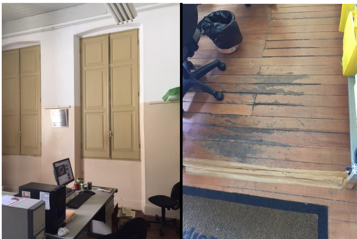
Fotos 29 e 30 - do Arquivo Histórico. As janelas serão recuperadas por meio de pintura e substituição da cremona em 02 janelas. Piso deverá ser retirado e substituído conforme padrão já mencionado. Fonte: Alessandra de Lima, 2017.
