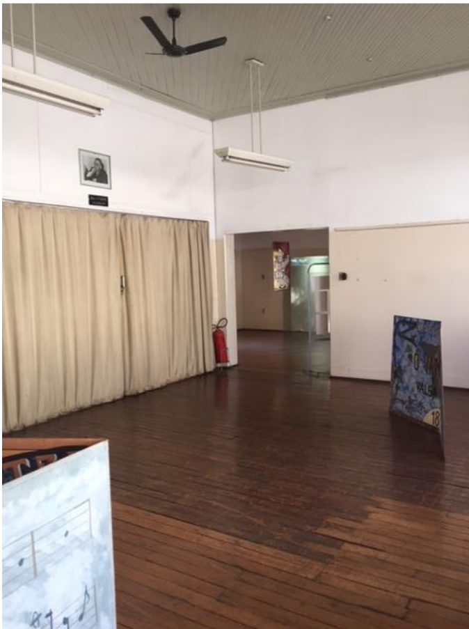
Foto 40 – Sala exposição 3 – Em relação ao piso, as ripas deterioradas serão removidas pois estão condenadas, e além do reforço dos vigamentos de madeira, será instalado de piso de madeira, conforme padrão e paginação no projeto arquitetônico de reforma e manutenção de madeira equivalente a Peroba Rosa ou de qualidade equivalente. O forro será removido e substituído por forro de madeira na mesma paginação; As paredes seguirão a pintura: serão amaciadas com massa acrílica e pintura com tinta látex acrílica ou esmalte a base de água, marca Suvinil ou de qualidade equivalente em um tom de tinta. As janelas de madeira serão restauradas ou substituídas no mesmo padrão e os vidros quebrados (craquelado ou martelado) serão substituídos.
