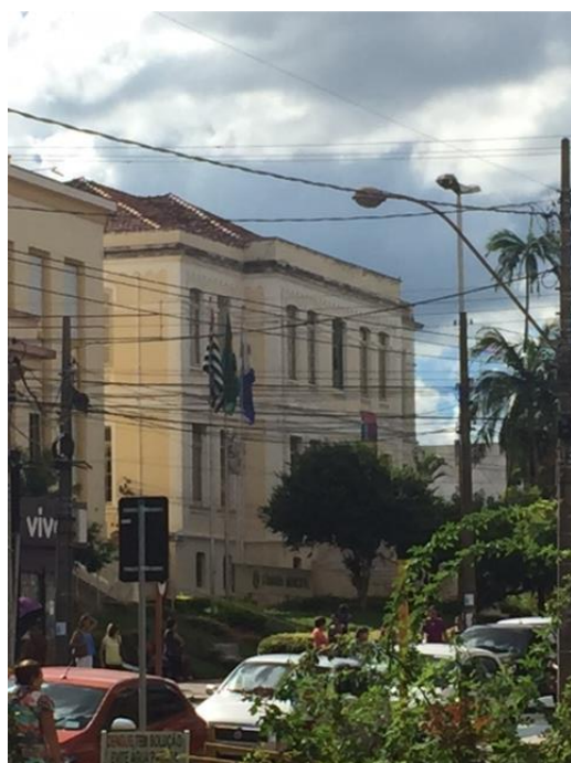
Foto 2 - Fachada da Casa da Cultura, junto com Palacete São Bento e Praça Santos Dumont, na qual percebe-se a necessidade de reparo na platibanda e pintura nas paredes. Fonte: Alessandra de Lima, 2017
