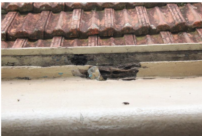
Foto 5 – Telhado – Detalhe do beiral que deverá ser recuperado. Fonte: Alessandra de Lima, 2017.
