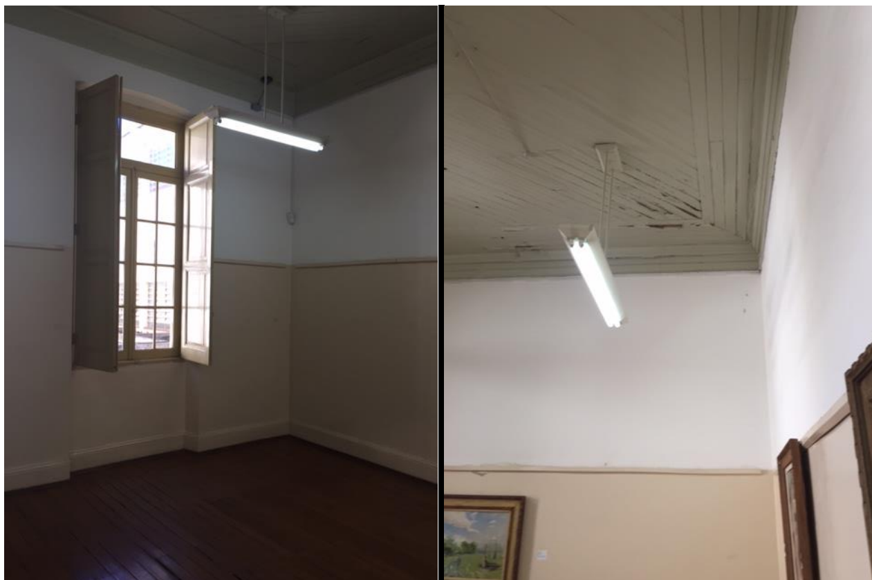
Fotos 25 e 26 - da Sala de Exposição 2. Nestas fotos verifica-se a necessidade de manutenção conforme supracitado, tanto no forro, parede, piso, janela, porta e iluminação. Obs. As paredes terão um único tom. Fonte: Alessandra de Lima, 2017.
