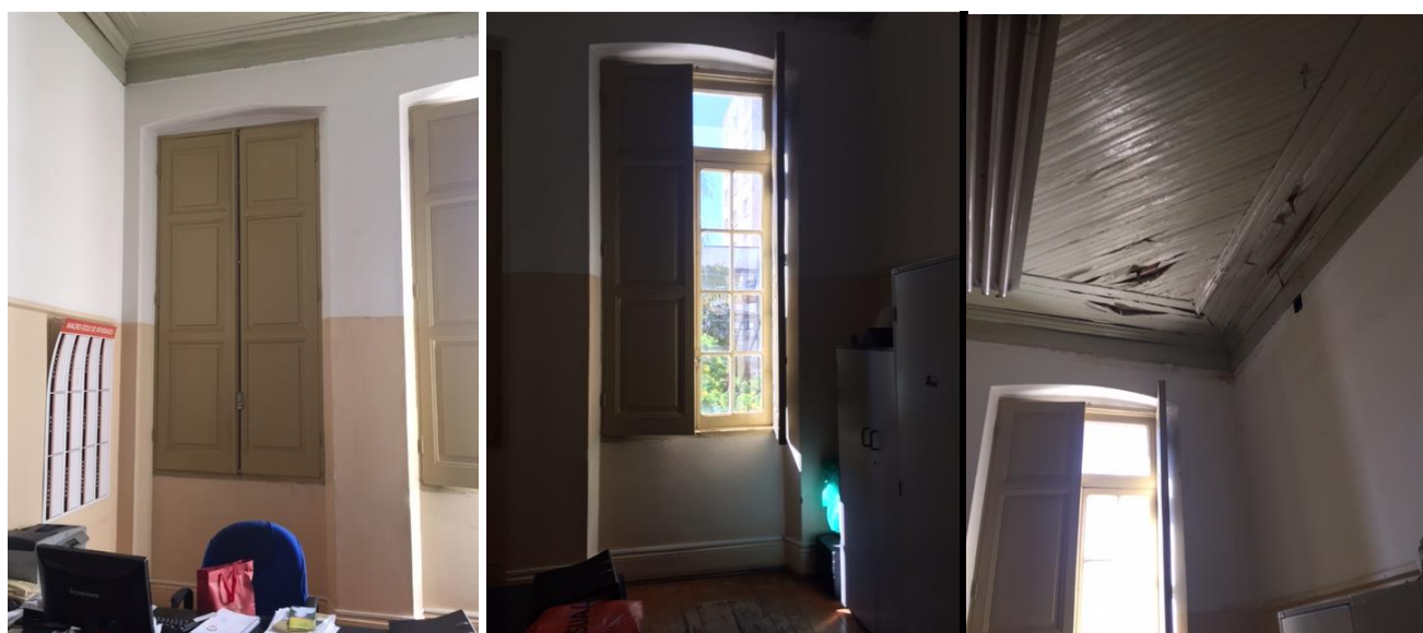
Fotos 31, 32 e 33 - Sala Admin. 1. Nestas fotos verifica-se que o piso e forro deverão ser retirados e substituídos conforme supracitado e projeto apresentado. As paredes seguirão a pintura: serão amaciadas com massa acrílica e pintura com tinta látex acrílica ou esmalte a base de água, marca Suvinil ou de qualidade equivalente em um tom de tinta. As janelas e porta serão repintadas. Fonte: Alessandra de Lima, 2017.
