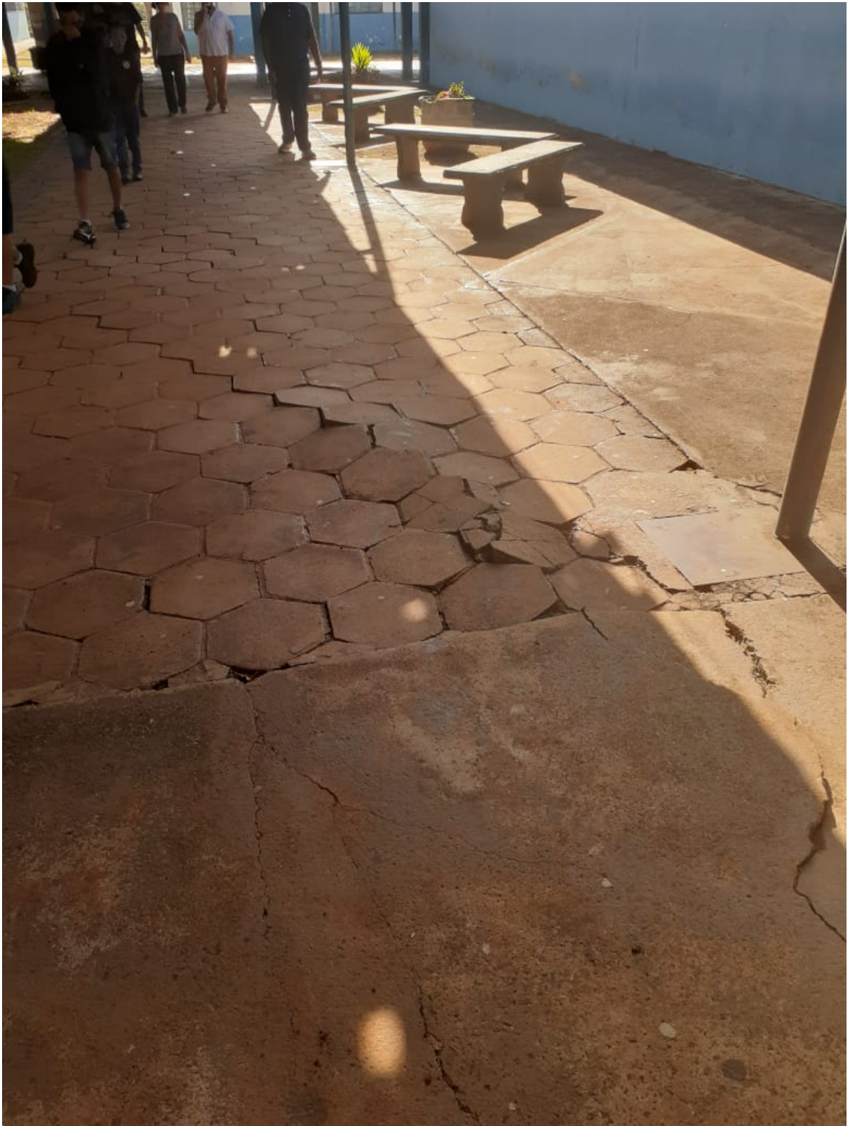
(raiz de árvore destruindo o chão)
