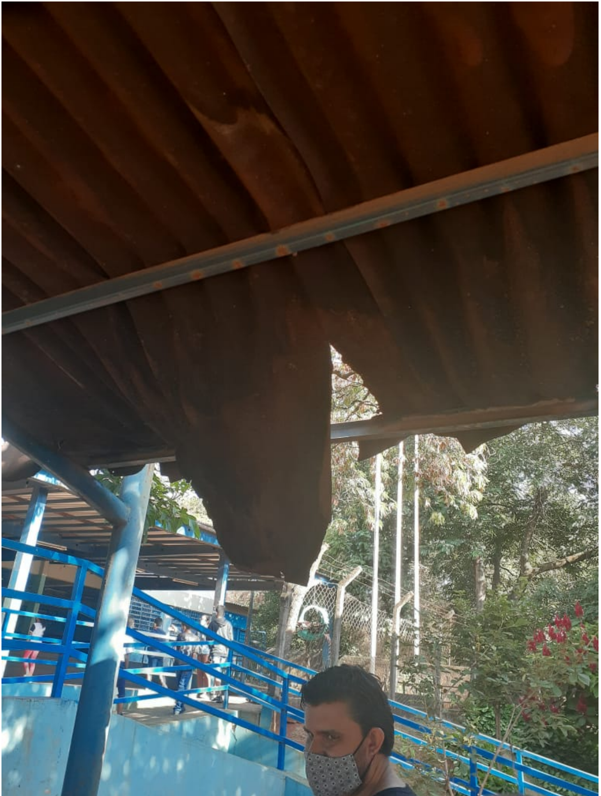
(telhado cedendo do túnel que faz a ligação entre os prédios)
