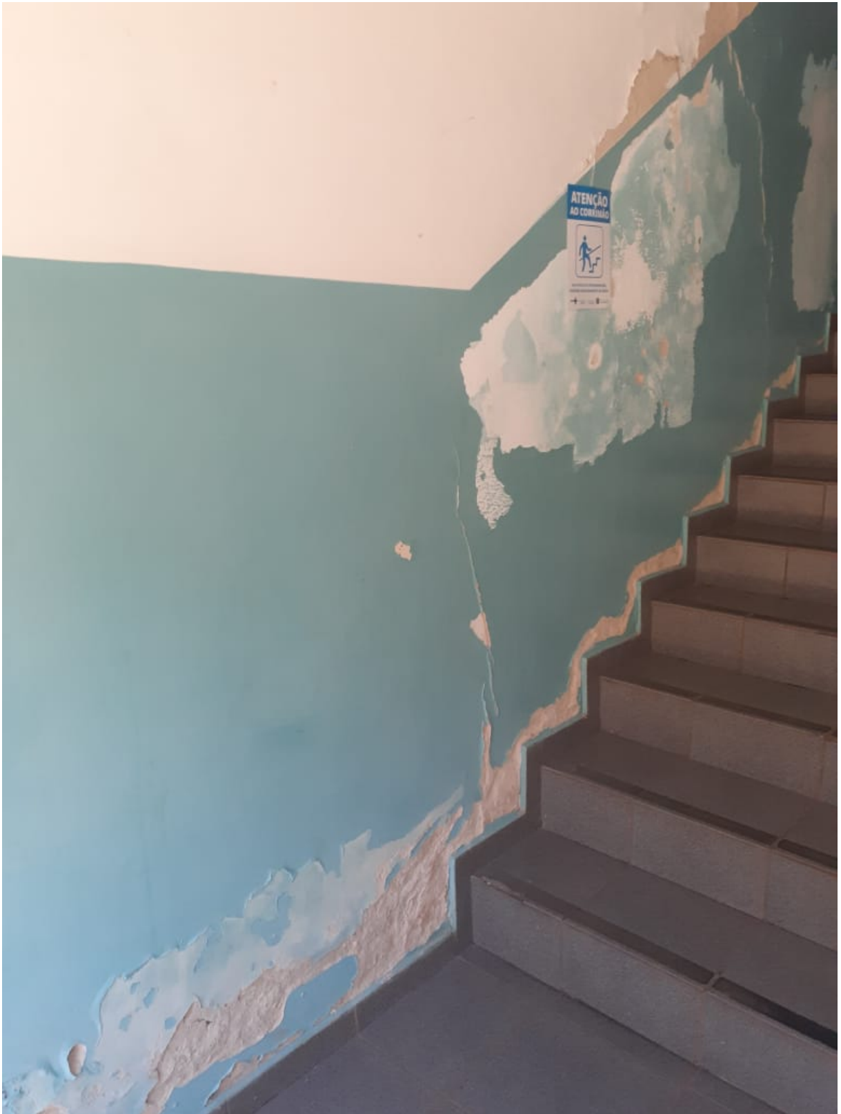
(pintura interna na EMEF, vários remendos de cimento e pintura desgastada)
