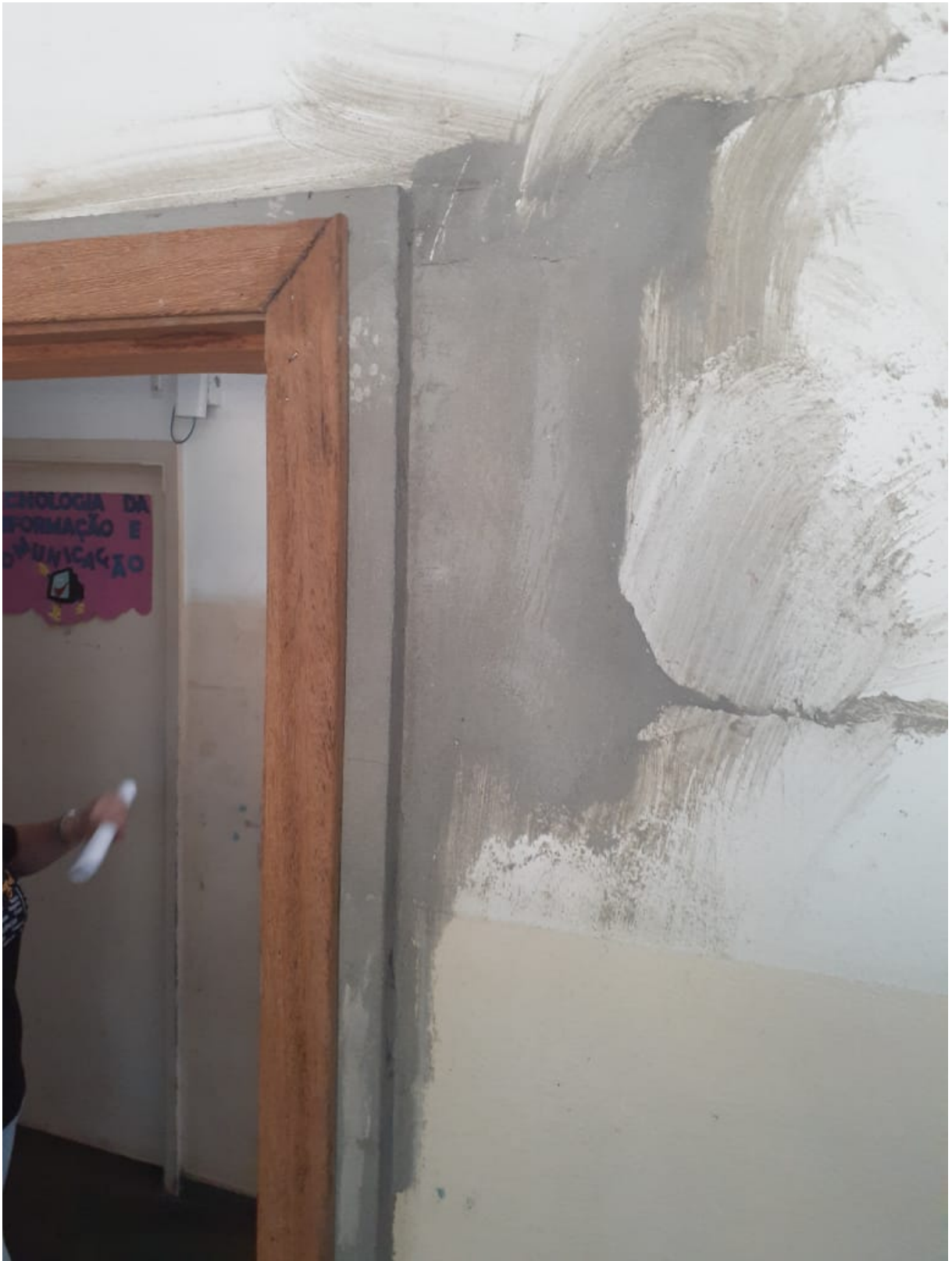
(falta de pinturas em torno dos batentes recém-trocados)
