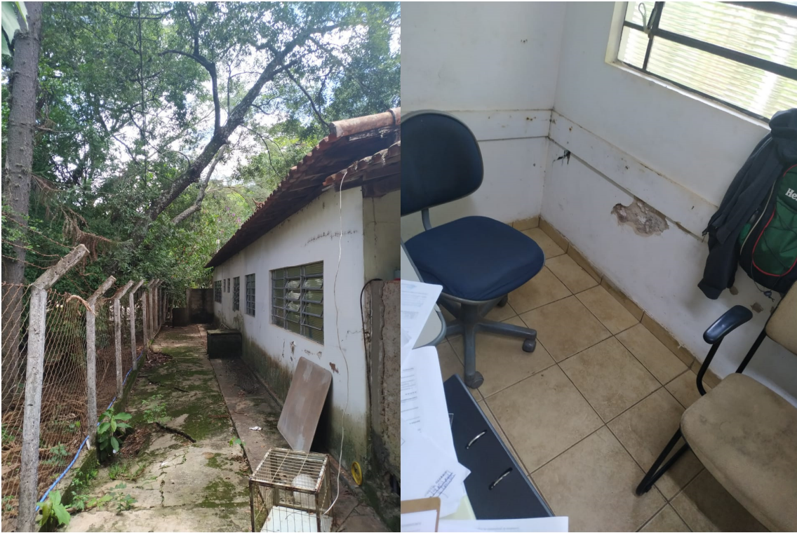
Árvore prestes a desabar. / Móveis sujos, paredes esburacadas.
