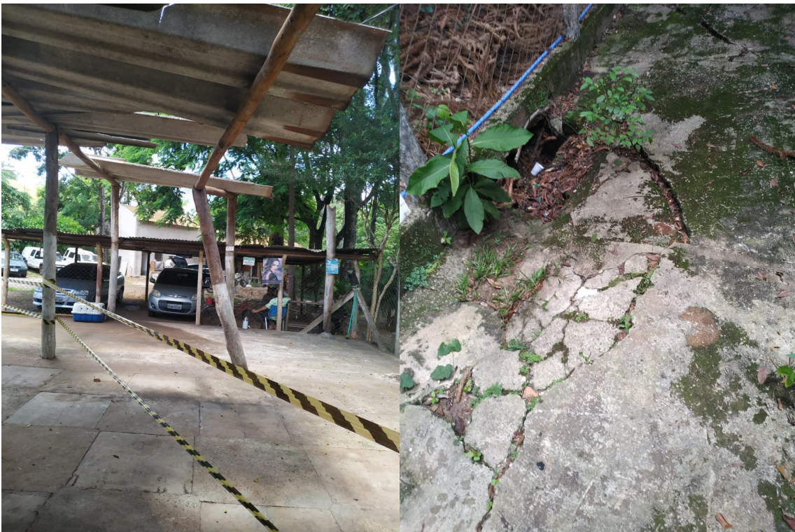
TELHADO DA GARAGEM PRESTES A DESABAR / PISO EXTERNO TOTALMENTE DERIORADO
