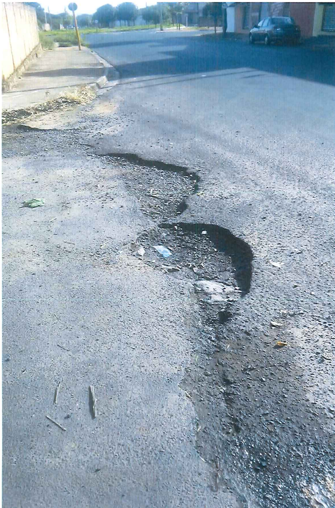
ANEXO 130 31032016 Tapa buraco Rua José Geraldo Veloce com Avenida Orlando Jayme- Jardim Esplanada
