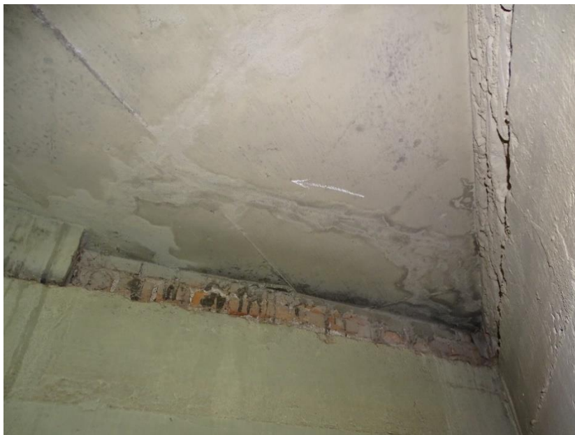
Figura C.109 – Fachada Leste – Fissura com manchas de umidade em laje, na região entre os pilares P110, P112 e P114.
