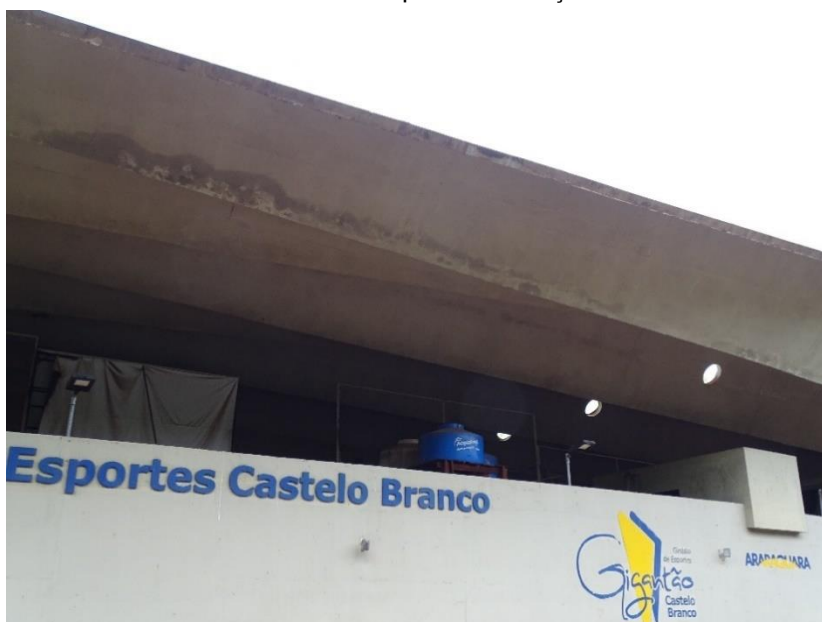
Figura C.142 – Elemento 22 - Face 3 – Manchas de umidade no vértice devido a deficiência da impermeabilização.
