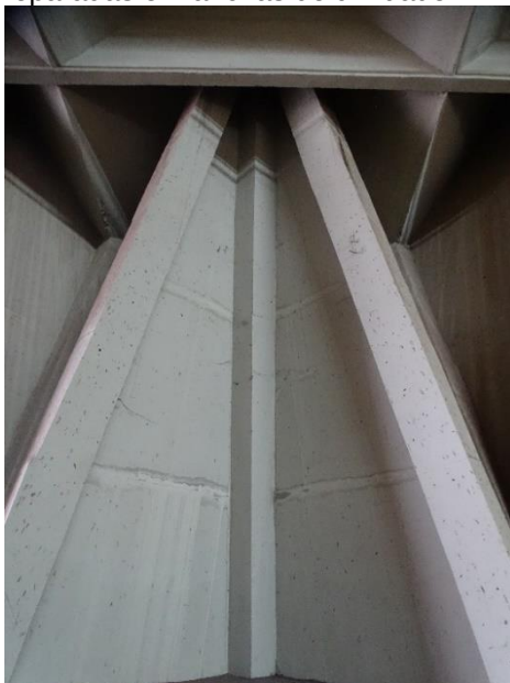
Figura C.16 – Face interna da fachada oeste na região entre os Elementos 7 e 8 – Junta de concretagem com fissuras reparadas e manchas de umidade.
