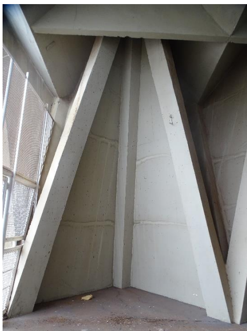
Figura 24 – Face interna da fachada oeste na região entre os Elemento 1 e 2 – Junta de concretagem com fissuras reparadas e manchas de umidade.
