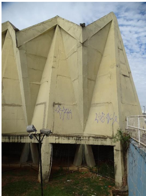
Figura 23 – Face externa da fachada oeste na região do Elemento 1 – Junta de concretagem com fissuras reparadas e manchas de umidade.
