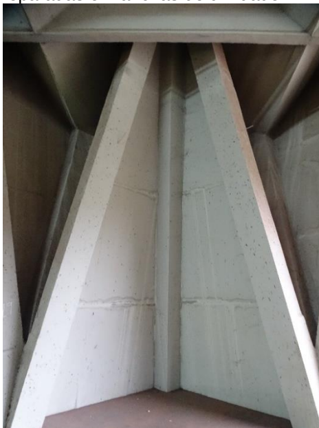
Figura C.39 – Face interna da fachada oeste na região entre os Elementos 19 e 20 – Junta de concretagem com fissuras reparadas e manchas de umidade.
