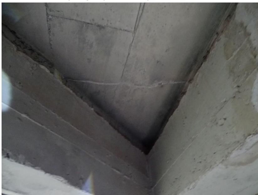
Figura C.116 – Fachada Leste – Fissura não reparada com manchas de umidade em laje região próxima ao pilar P142.
