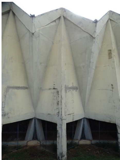
Figura C.64 – Face externa da fachada Leste na região do Elemento 9 – Junta de concretagem com fissuras reparadas e manchas de umidade.
