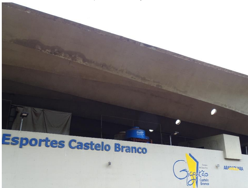
Figura 35 – Elemento 22 - Face 3 – Manchas de umidade no vértice devido a deficiência da impermeabilização.
