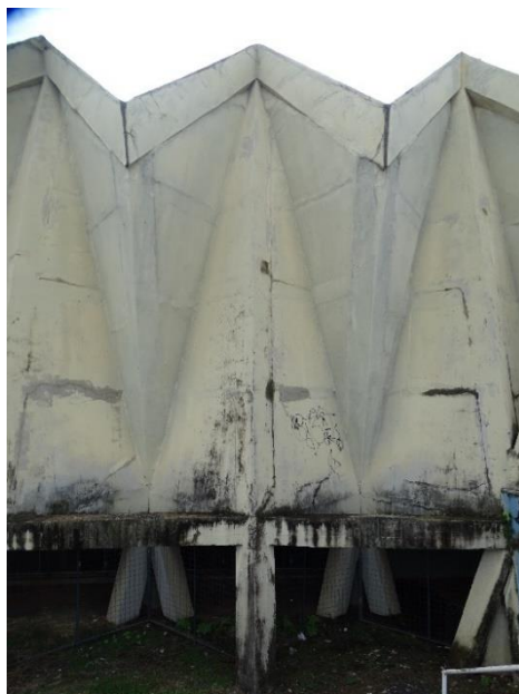
Figura C.88 – Face externa da fachada Leste na região do Elemento 21 – Junta de concretagem com fissuras reparadas e manchas de umidade.
