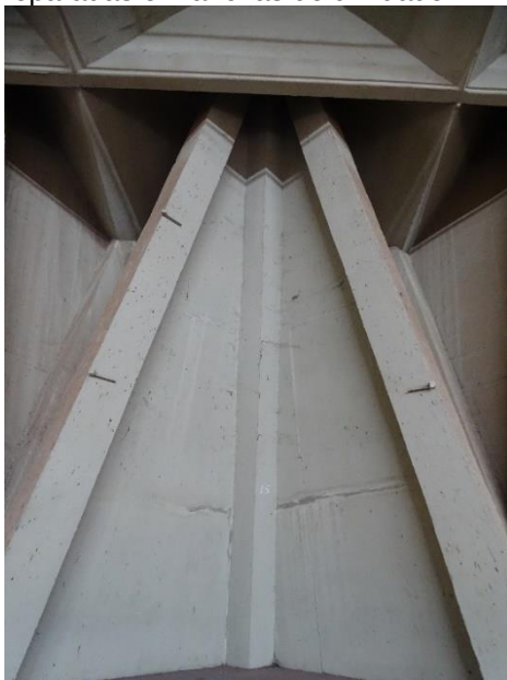
Figura C.77 – Face interna da fachada Leste na região do Elemento 15 – Junta de concretagem com fissuras reparadas e manchas de umidade.
