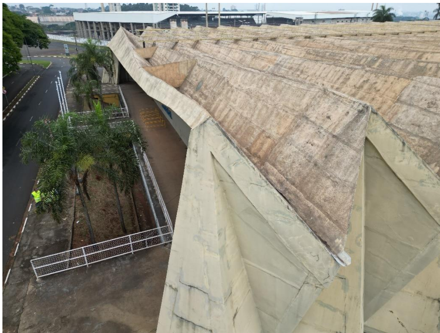
Figura B.10 – Vista da deformação acentuada construtiva do elemento 22.
