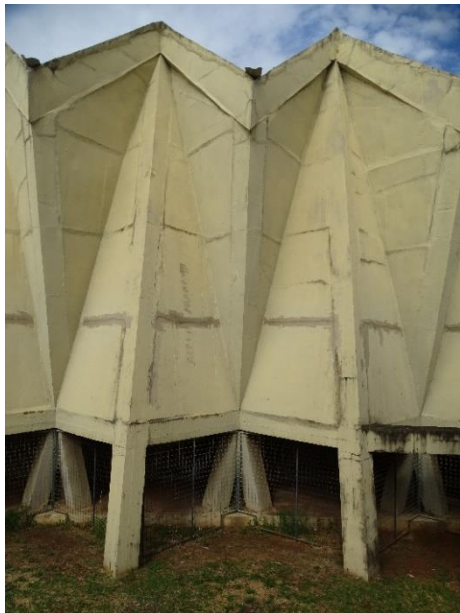
Figura C.9 – Face externa da fachada Oeste na região do Elemento 4 – Junta de concretagem com fissuras reparadas e manchas de umidade.
