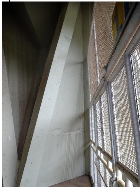
Figura C.43 – Face interna da fachada oeste na região entre os Elementos 21 e 22 – Junta de concretagem com fissuras reparadas e manchas de umidade.
