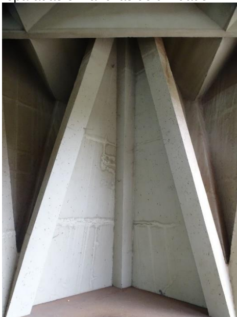
Figura C.41 – Face interna da fachada oeste na região entre os Elementos 20 e 21 – Junta de concretagem com fissuras reparadas e manchas de umidade.
