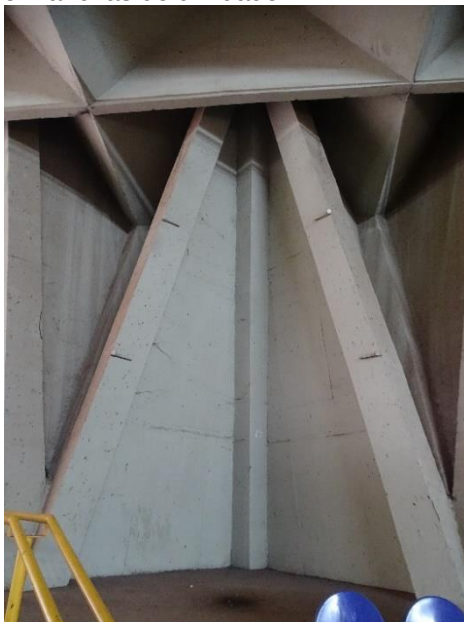
Figura C.85 – Face interna da fachada Leste na região do Elemento 19 – Junta de concretagem com fissuras reparadas e manchas de umidade.
