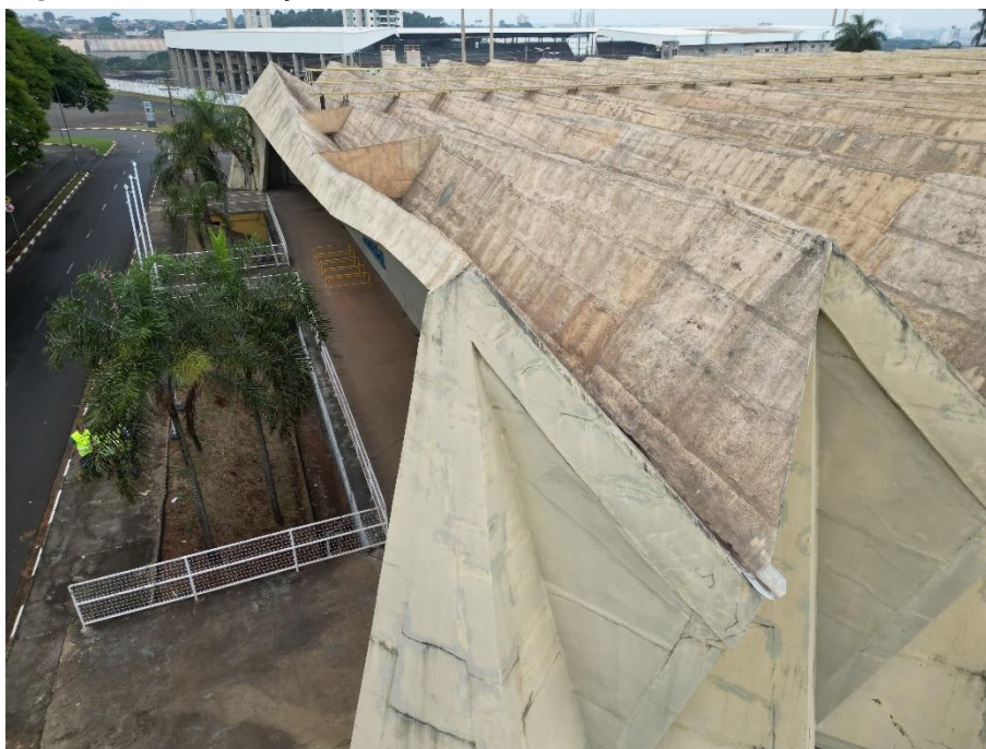
Figura 22 – Deformação construtiva do elemento 22.
