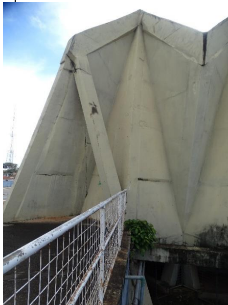
Figura C.46 – Face externa da fachada Leste na região extrema do Elemento 1 – Junta de concretagem com fissuras reparadas e manchas de umidade.
