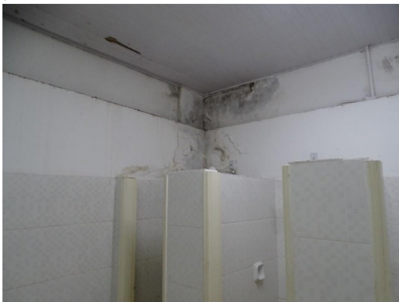
Figura C.170 – Vestiário 5 – Manchas de umidade junto a ligação dos painéis de alvenaria.
