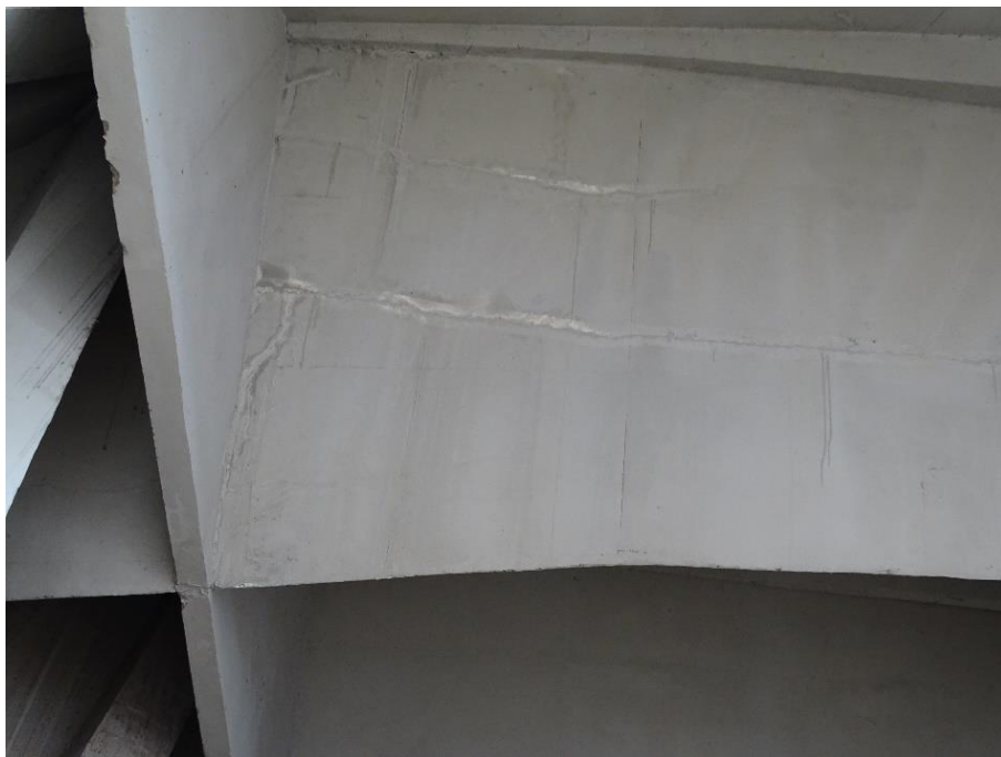
Figura 33 – Elemento 2 – Fissura com mancha de umidade devido à deficiência na impermeabilização.
