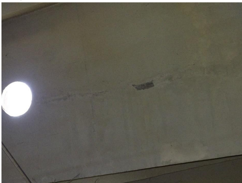
Figura C.130 – Elemento 10 - Face 4 – Fissura em junta de concretagem com mancha de umidade e destacamento da argamassa de reparo.
