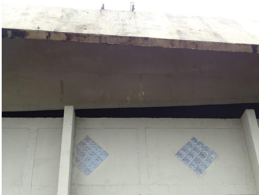
Figura 32 – Elemento 1 – Fissura com mancha de umidade devido à deficiência na impermeabilização.
