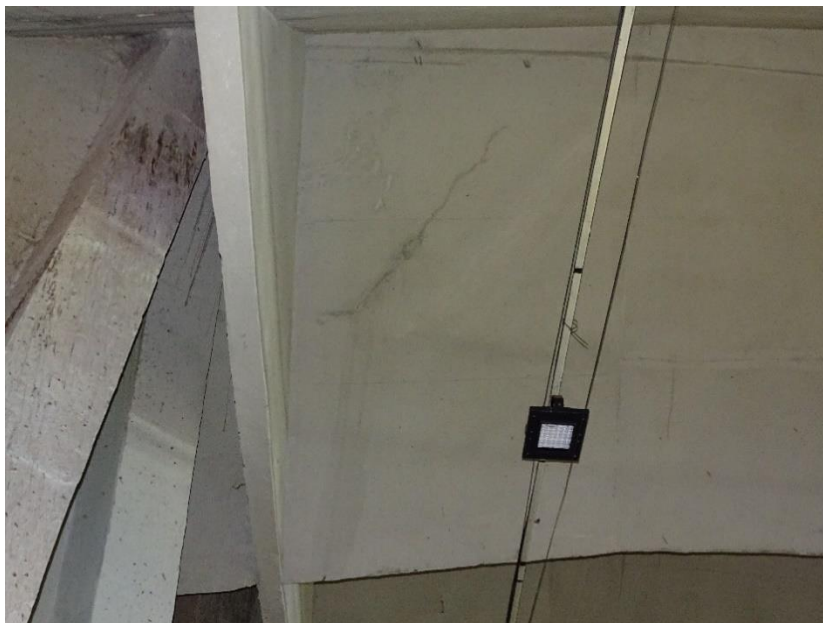
Figura C.131 – Elemento 11 - Face 2 – Fissura com mancha de umidade devido à deficiência na impermeabilização.
