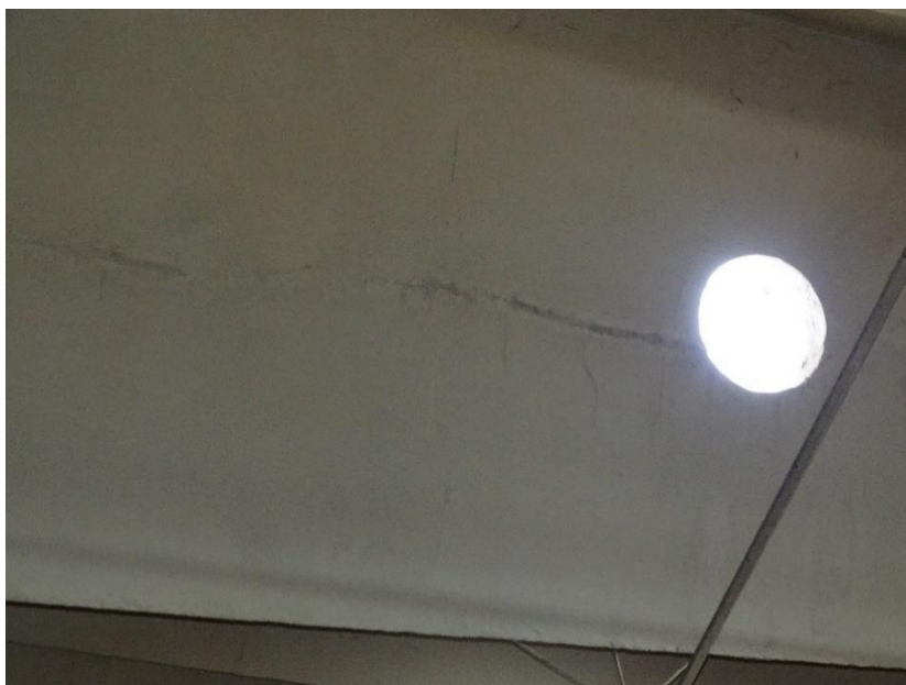
Figura C.128 – Elemento 9 Face 1 – Fissura em junta de concretagem com mancha de umidade.
