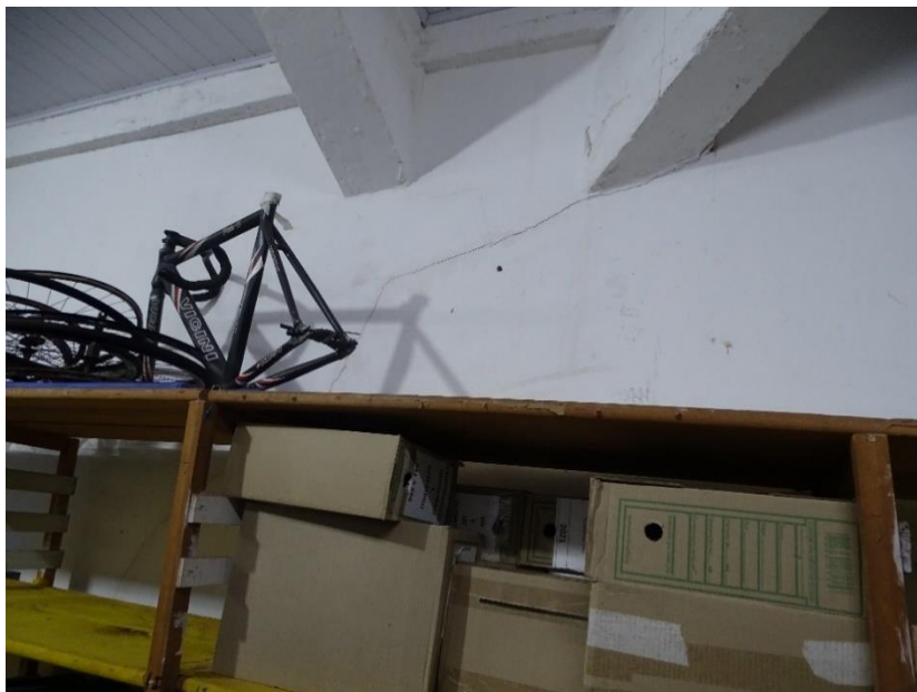
Figura C.174 – Almoxarifado – Outro trecho da trinca no painel de alvenaria mostrada na Figura C.173.
