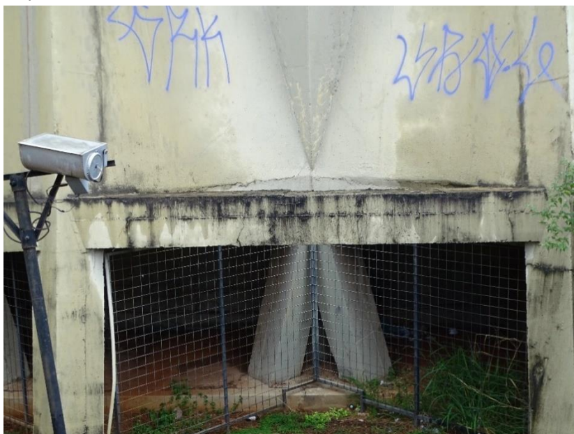
Figura C.104 – Fachada Oeste – Trinca na viga de travamento entre os pilares P2 e P6.
