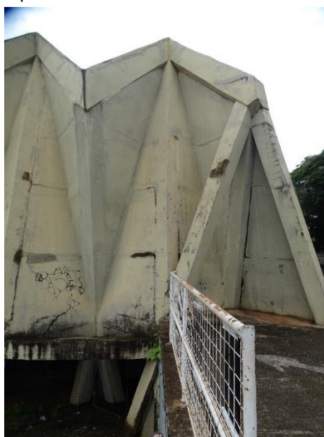
Figura C.90 – Face externa da fachada Leste na região do Elemento 22 – Junta de concretagem com fissuras reparadas e manchas de umidade.
