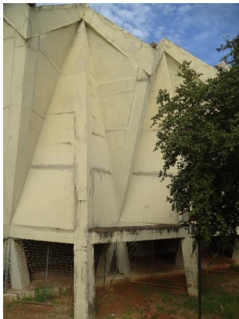
Figura C.13 – Face externa da fachada Oeste na região do Elemento 6 – Junta de concretagem com fissuras reparadas e manchas de umidade.
