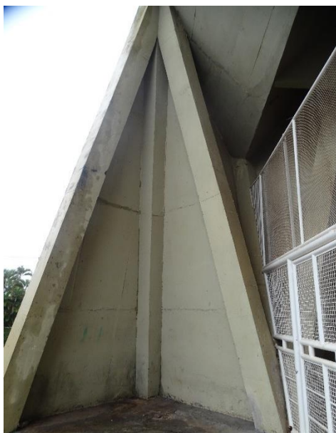
Figura C.2 – Face interna da fachada oeste na região extrema do Elemento 1 – Junta de concretagem com fissuras reparadas e manchas de umidade.
