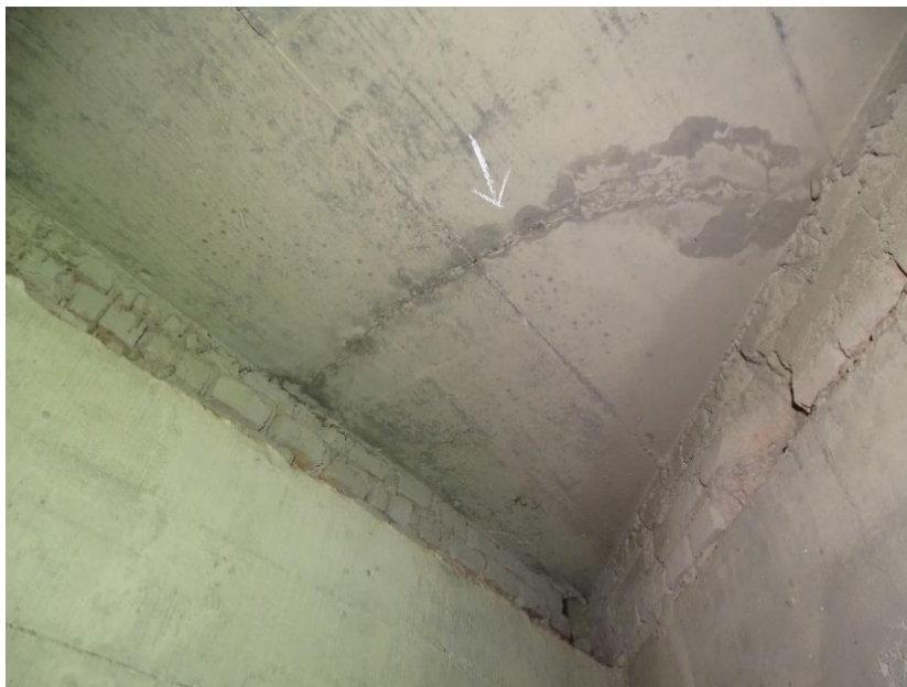
Figura C.107 – Fachada Leste – Fissura com manchas de umidade em laje, na região entre os pilares P102, P104 e P106.
