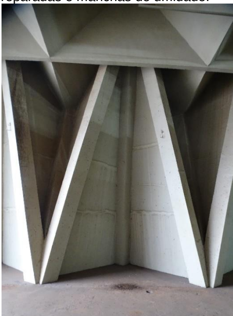
Figura C.8 – Face interna da fachada oeste na região entre os Elemento 3 e 4 – Junta de concretagem com fissuras reparadas e manchas de umidade.
