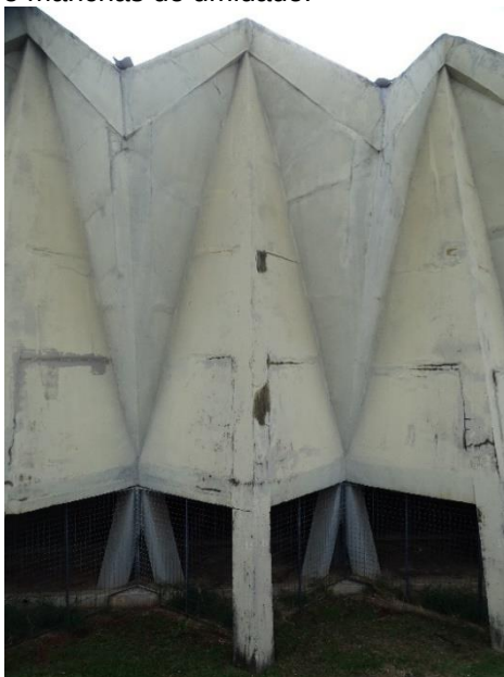
Figura C.72 – Face externa da fachada Leste na região do Elemento 13 – Junta de concretagem com fissuras reparadas e manchas de umidade.
