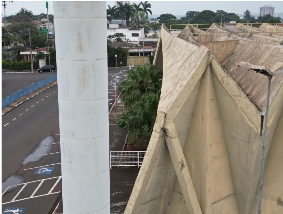
Figura B.9 – Vista da deformação acentuada construtiva do elemento 1.
