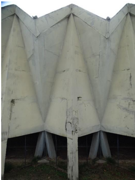
Figura C.76 – Face externa da fachada Leste na região do Elemento 15 – Junta de concretagem com fissuras reparadas e manchas de umidade.
