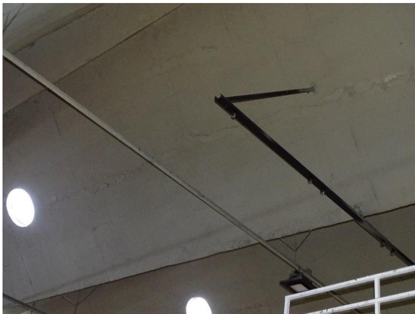
Figura C.133 – Elemento 13 - Face 3 – Fissura em junta de concretagem com destacamento da argamassa de reparo.
