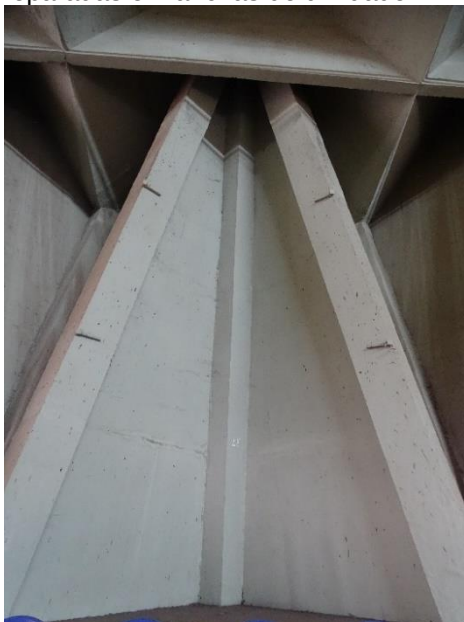
Figura C.83 – Face interna da fachada Leste na região do Elemento 18 – Junta de concretagem com fissuras reparadas e manchas de umidade.
