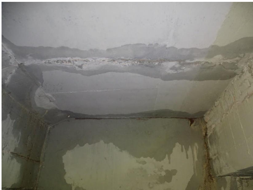
Figura C.120 – Fachada Leste – Fissura com manchas de umidade em laje e no muro de contenção do terreno, região próxima ao pilar P182.
