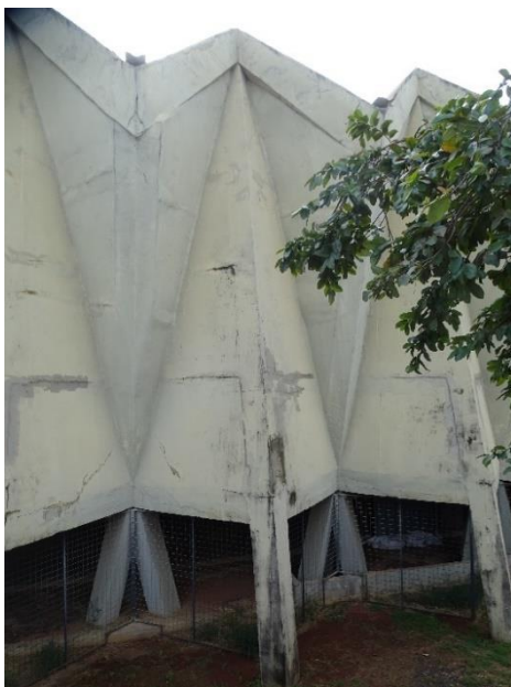
Figura C.80 – Face externa da fachada Leste na região do Elemento 17 – Junta de concretagem com fissuras reparadas e manchas de umidade.
