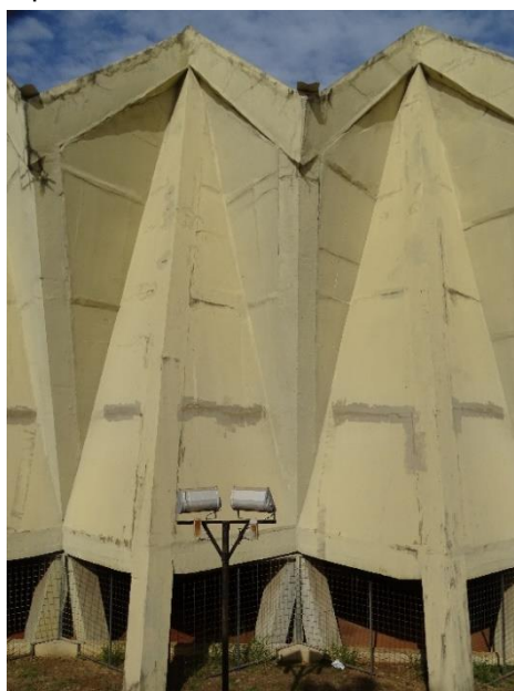
Figura C.28 – Face externa da fachada Oeste na região do Elemento 15 – Junta de concretagem com fissuras reparadas e manchas de umidade.
