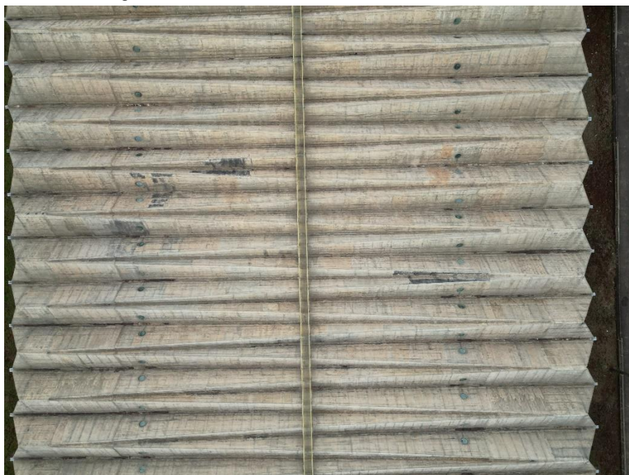
Figura B.7 – Vista superior da cobertura do ginásio entre os elementos 6 e 15. Nota-se algumas manchas escuras entre os elementos 8 e 12.
