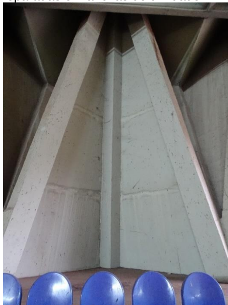
Figura C.37 – Face interna da fachada oeste na região entre os Elementos 18 e 19 – Junta de concretagem com fissuras reparadas e manchas de umidade.
