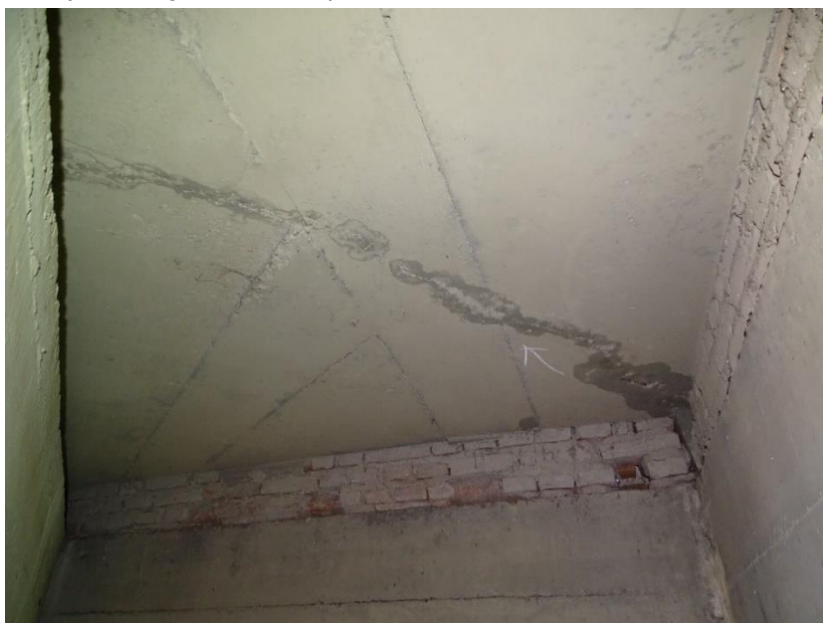
Figura C.108 – Fachada Leste – Fissura com manchas de umidade em laje, na região entre os pilares P106, P108 e P110.
