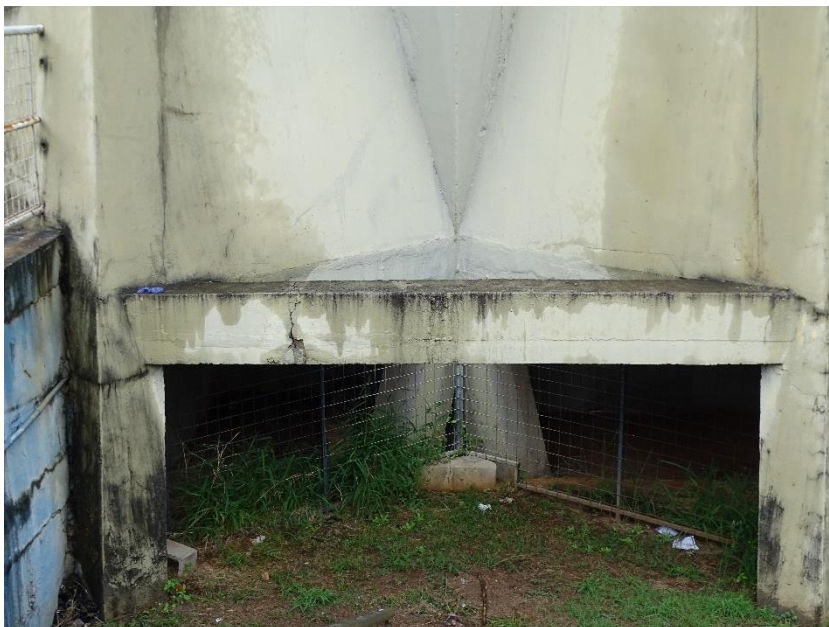
Figura 29 – Fachada Oeste – Trinca na viga de travamento entre os pilares P86 e P90.
