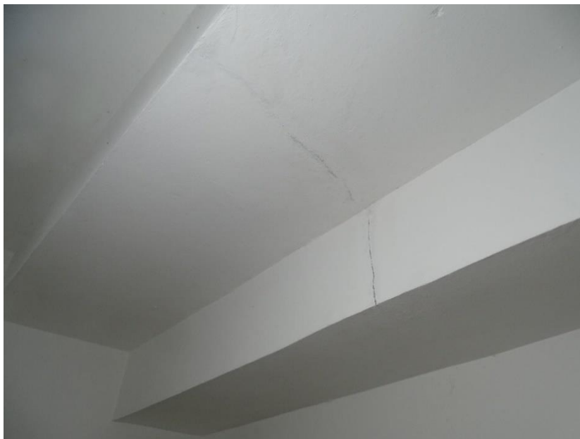
Figura C.157 – Vista inferior do módulo de arquibancada C “Setor 33”. Note a fissura no reparo executado.
