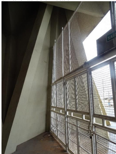
Figura C.49 – Face interna da fachada Leste na região do Elemento 1 – Junta de concretagem com fissuras reparadas e manchas de umidade.
