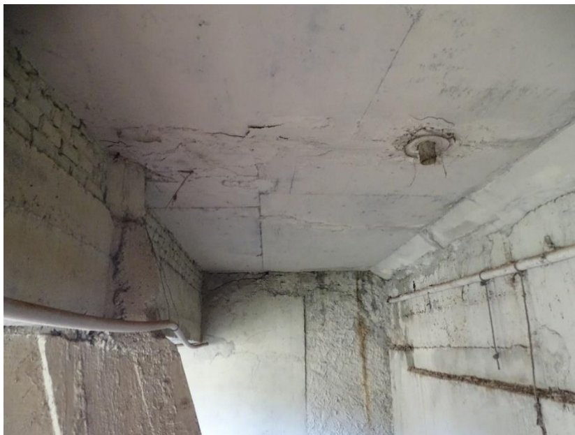
Figura C.101 – Vigas de travamento na fachada Oeste – Concreto disgregado e armaduras expostas no topo do pilar P4.
