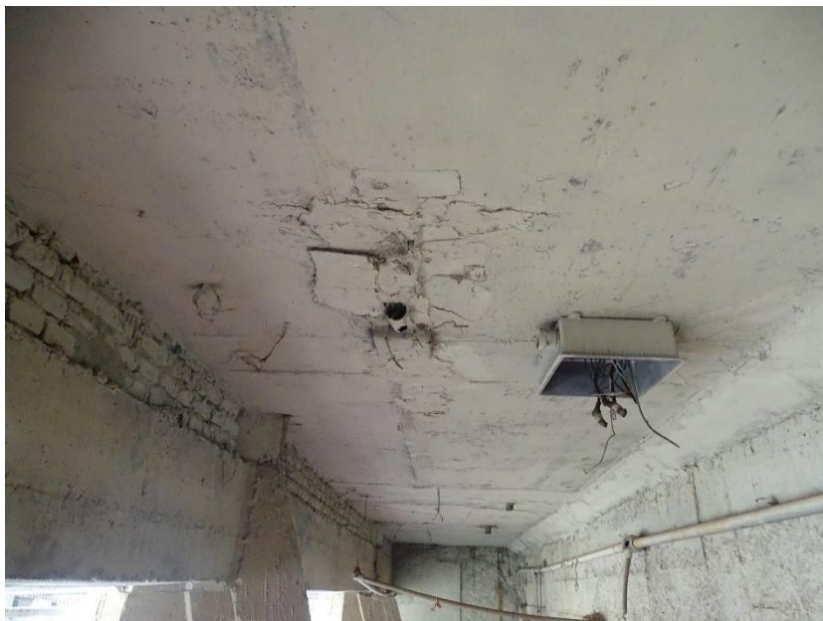
Figura C.100 – Vigas de travamento na fachada Oeste – Concreto disgregado e armaduras expostas no topo do pilar P4.
