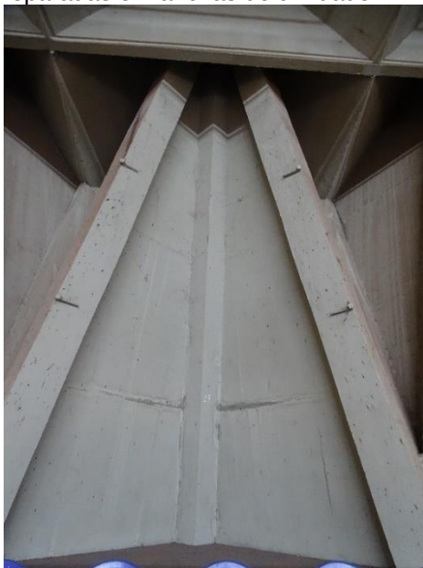
Figura C.75 – Face interna da fachada Leste na região do Elemento 14 – Junta de concretagem com fissuras reparadas e manchas de umidade.
