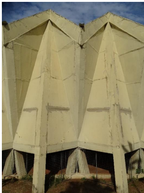
Figura C.25 – Face externa da fachada Oeste na região do Elemento 12 – Junta de concretagem com fissuras reparadas e manchas de umidade.
