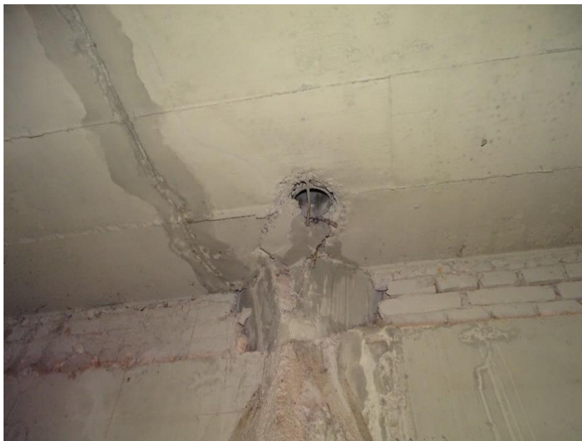
Figura C.119 – Fachada Leste – Fissura com manchas de umidade em laje região próxima ao pilar P178.
