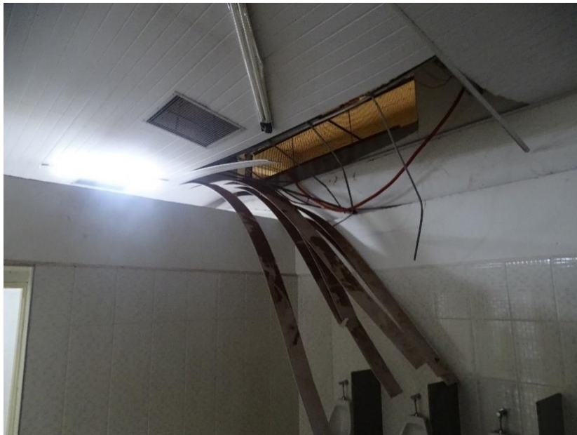
Figura C.167 – Vestiário 1 – Outra vista dos danos no forro de PVC.
