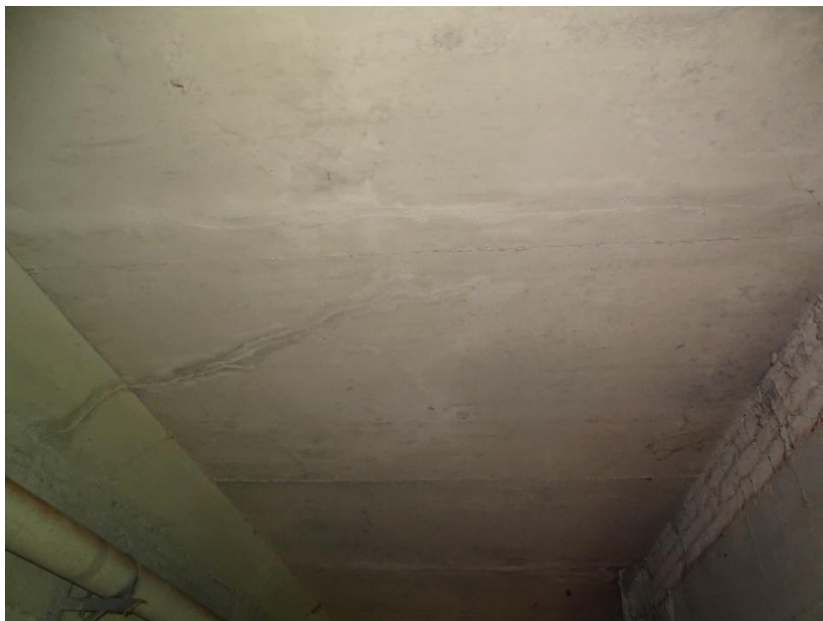
Figura C.112 – Fachada Leste – Fissura com manchas de umidade em laje região próxima ao pilar P122.
