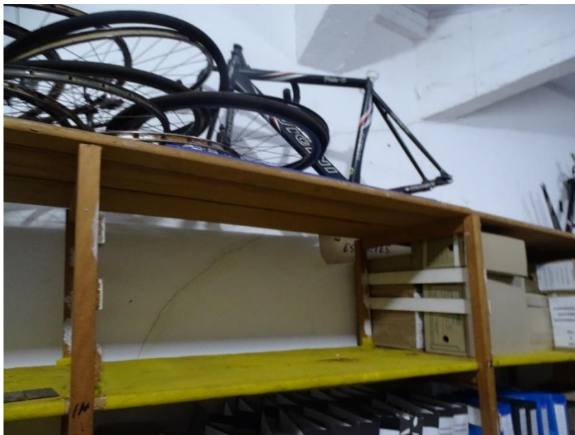
Figura C.173 – Almoxarifado – Trinca no painel de alvenaria sob a arquibancada.
