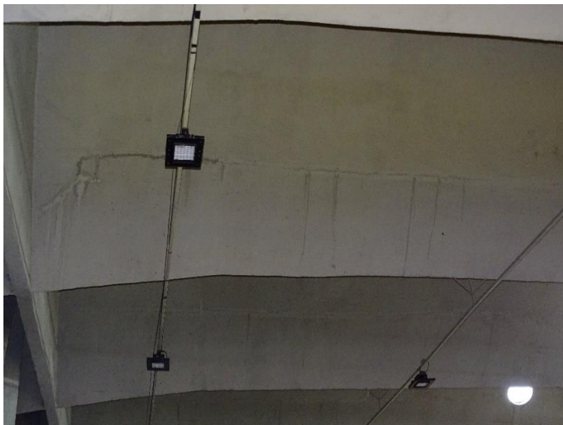
Figura C.129 – Elemento 9 – Face 2 – Fissura em junta de concretagem com mancha de umidade devido à deficiência na impermeabilização.
