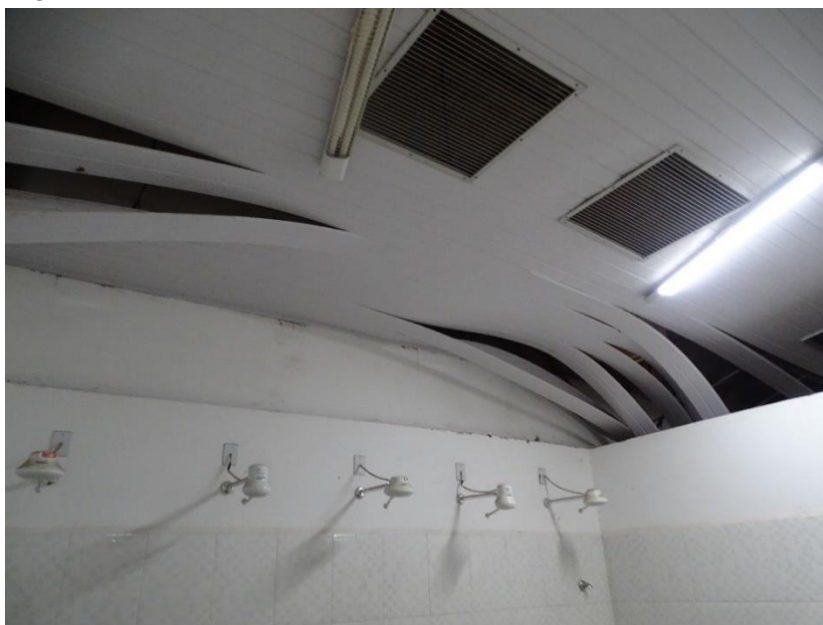
Figura C.166 – Vestiário 1 – Danos no forro de PVC.
