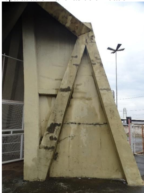
Figura C.45 – Face interna da fachada oeste na região extrema do Elemento 22 – Junta de concretagem com fissuras reparadas e manchas de umidade.
