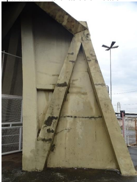
Figura C.47 – Face interna da fachada Leste na região extrema do Elemento 1 – Junta de concretagem com fissuras reparadas e manchas de umidade.
