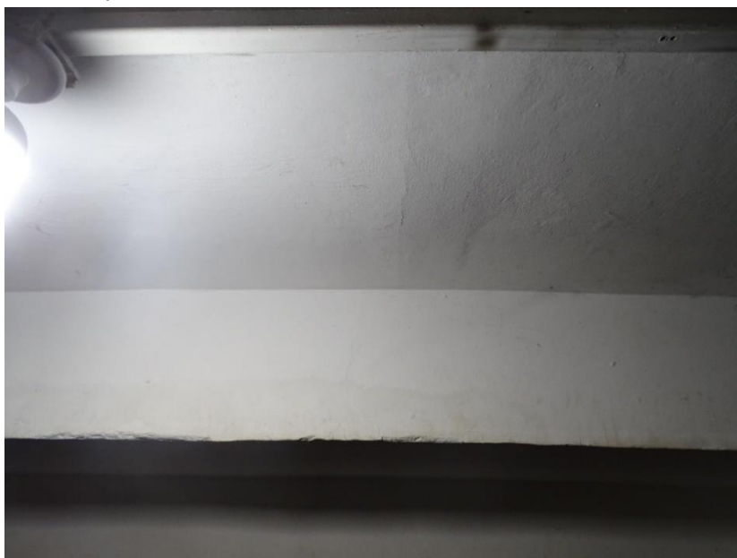
Figura C.156 – Vista inferior do módulo de arquibancada C “Setor 32”. Note o reparo executado na fissura.
