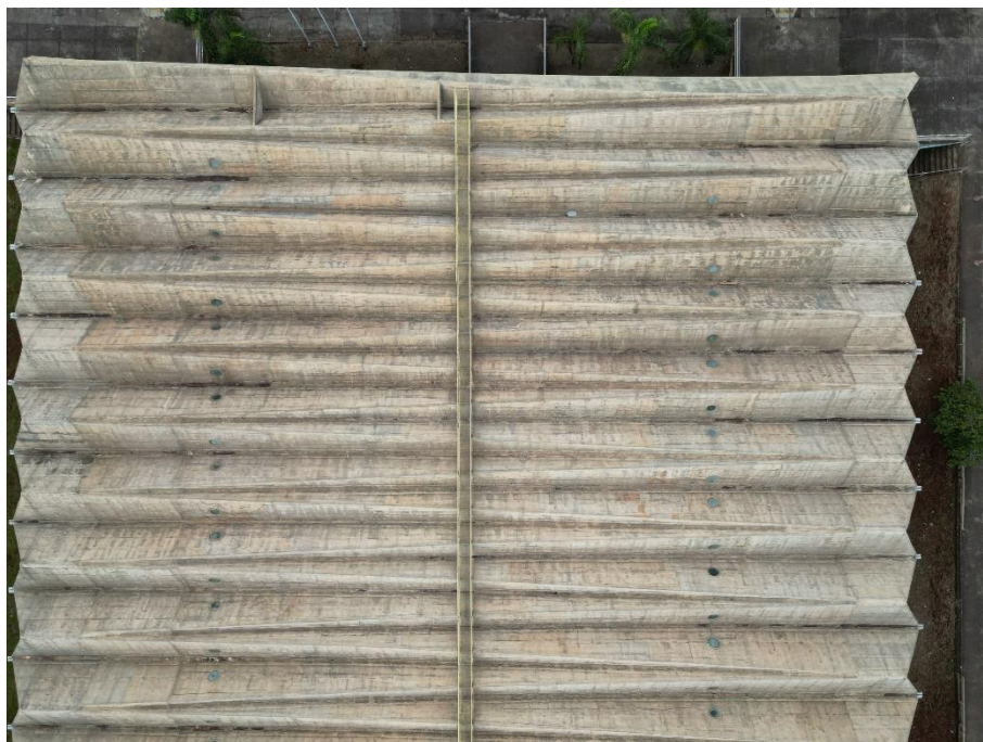
Figura B.8 – Vista superior da cobertura do ginásio entre os elementos 14 a 22 sem evidências de manchas escuras.
