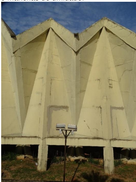
Figura C.40 – Face externa da fachada Oeste na região do Elemento 21 – Junta de concretagem com fissuras reparadas e manchas de umidade.
