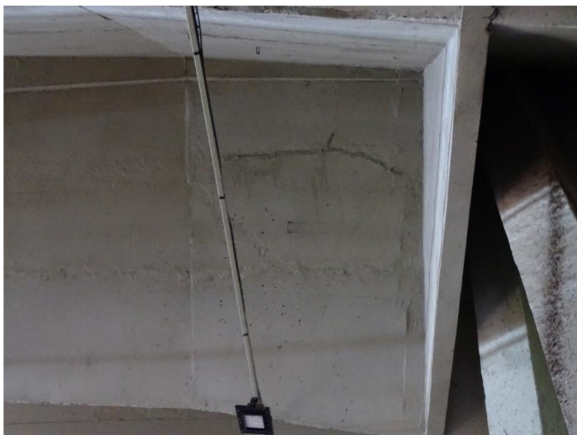
Figura C.136 – Elemento 14 - Face 3 – Fissura com mancha de umidade.
