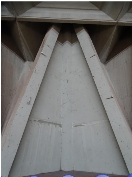
Figura C.71 – Face interna da fachada Leste na região do Elemento 12 – Junta de concretagem com fissuras reparadas e manchas de umidade.
