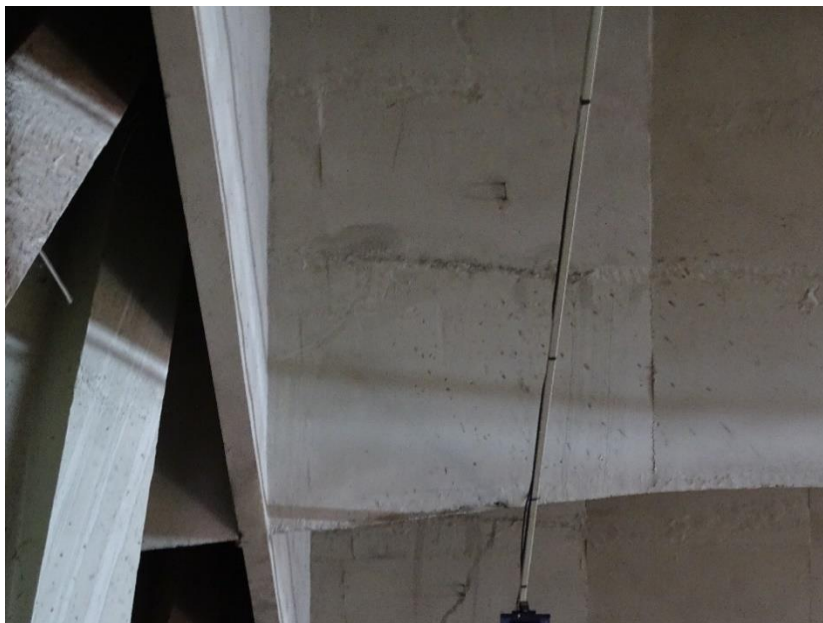
Figura C.137 – Elemento 15 - Face 2 – Fissura em junta de concretagem com mancha de umidade.
