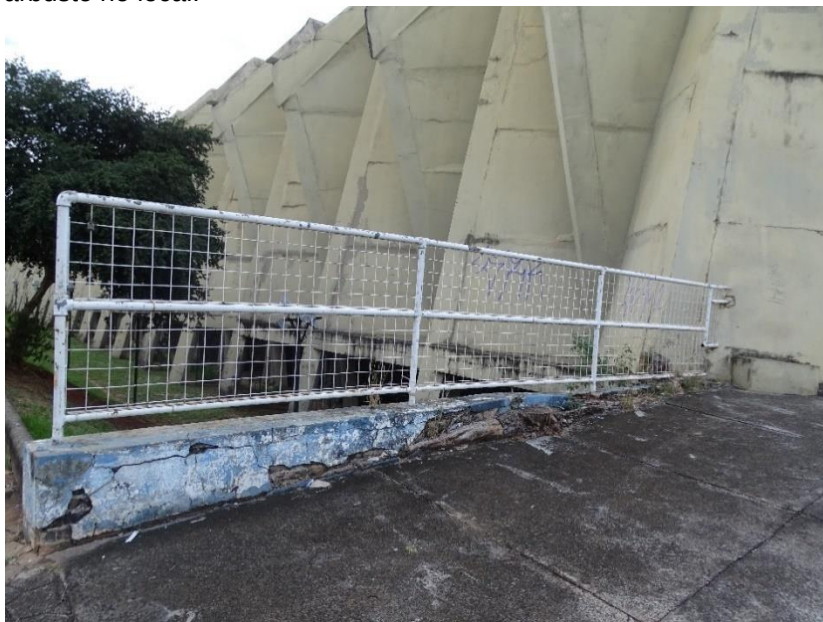
Figura C.97 – Fachada Oeste – Outra vista do trecho do muro de contenção mostrado na Figura C.96. Note a presença de raízes de arbusto no local.
