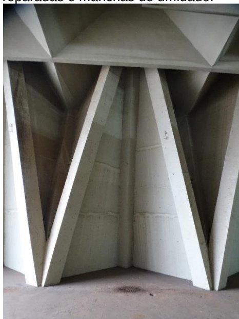
Figura C.22 – Face interna da fachada oeste na região entre os Elementos 10 e 11 – Junta de concretagem com fissuras reparadas e manchas de umidade.
