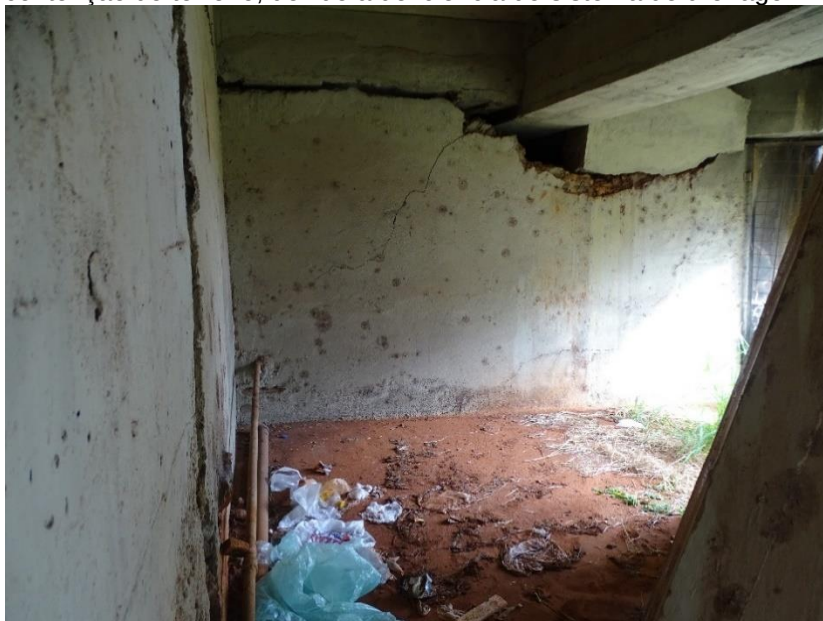
Figura C.92 – Fachada Oeste – Detritos na base do muro de contenção do terreno, devido a deficiência do sistema de drenagem.
