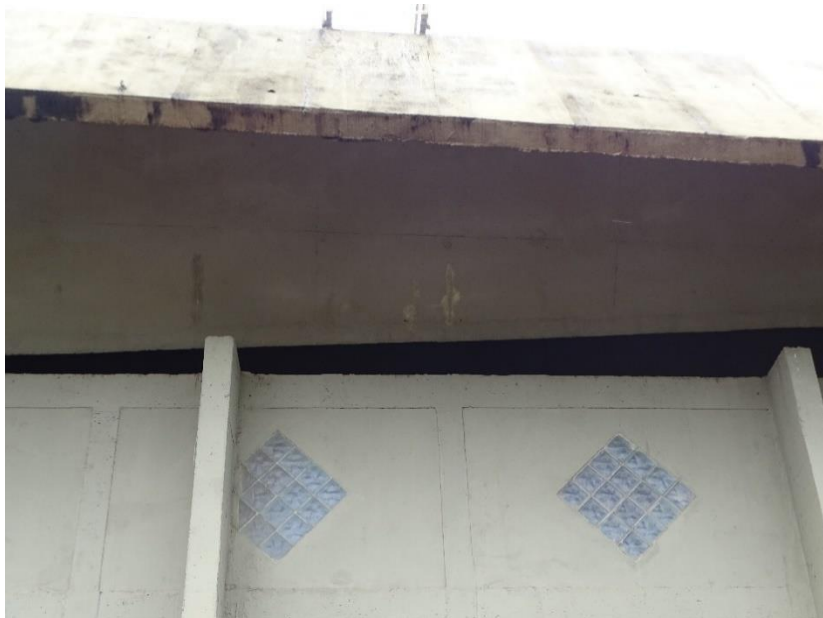
Figura C.122 – Elemento 1 – Fissura com mancha de umidade devido à deficiência na impermeabilização.
