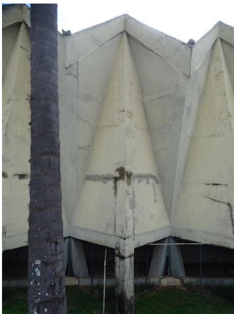
Figura C.54 – Face externa da fachada Leste na região do Elemento 4 – Junta de concretagem com fissuras reparadas e manchas de umidade.
