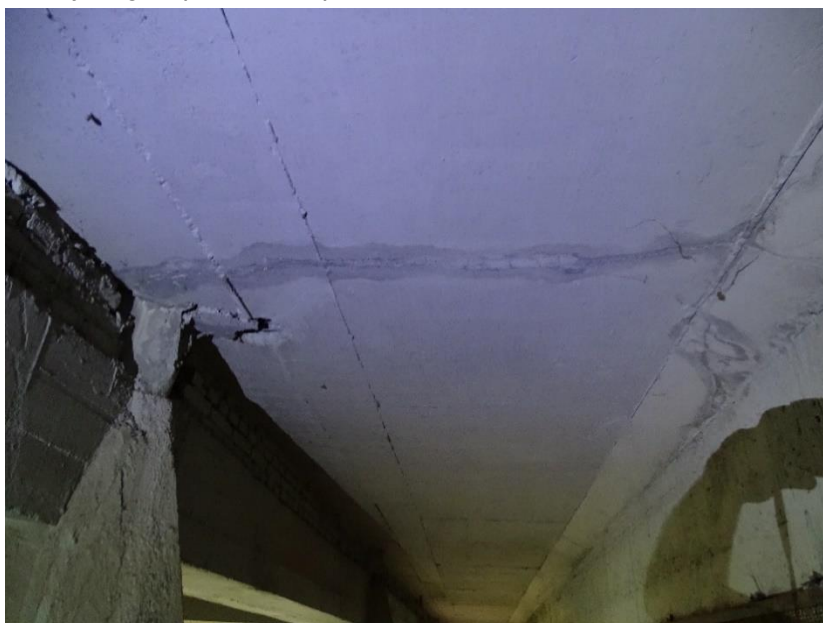
Figura C.118 – Fachada Leste – Fissura com manchas de umidade em laje região próxima ao pilar P178.
