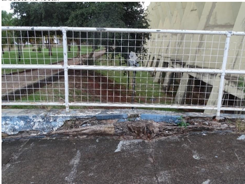
Figura C.98 – Fachada Oeste – Detalhe da Figura C.97. Raízes de arbusto no local.
