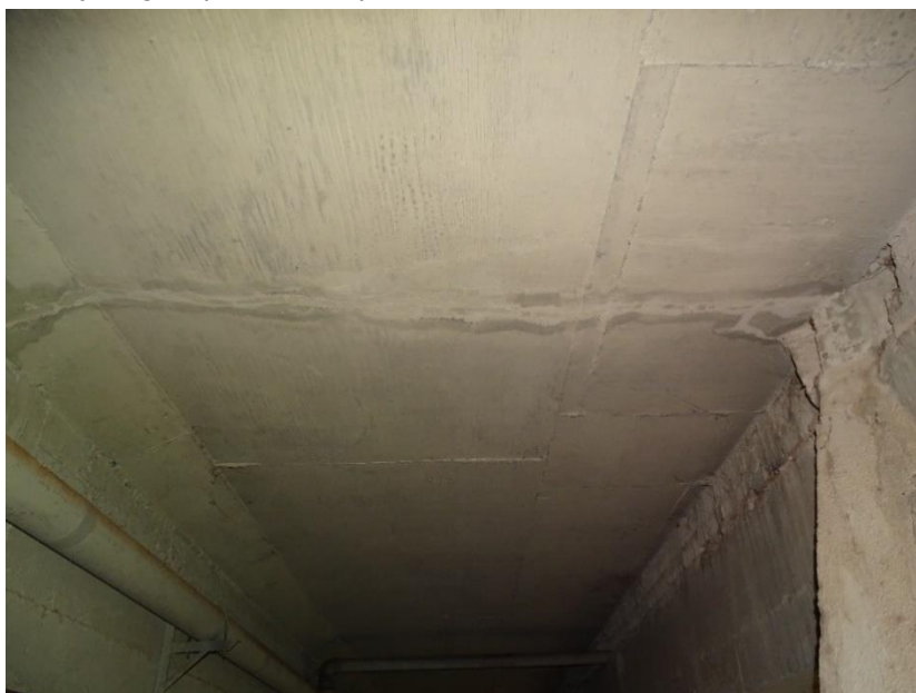
Figura C.114 – Fachada Leste – Fissura com manchas de umidade em laje região próxima ao pilar P130.
