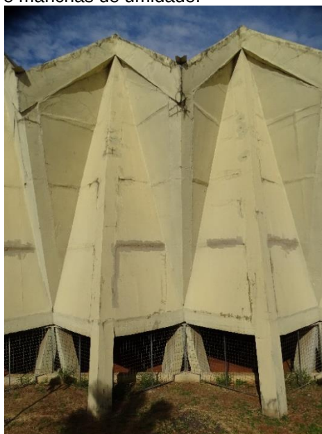
Figura C.36 – Face externa da fachada Oeste na região do Elemento 19 – Junta de concretagem com fissuras reparadas e manchas de umidade.
