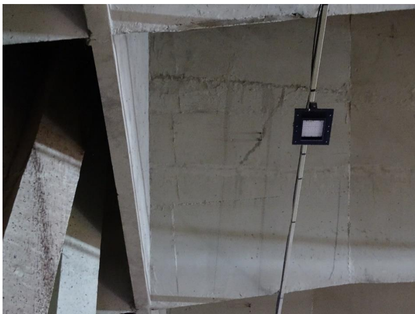
Figura C.138 – Elemento 16 - Face 2 – Fissura com mancha de umidade.
