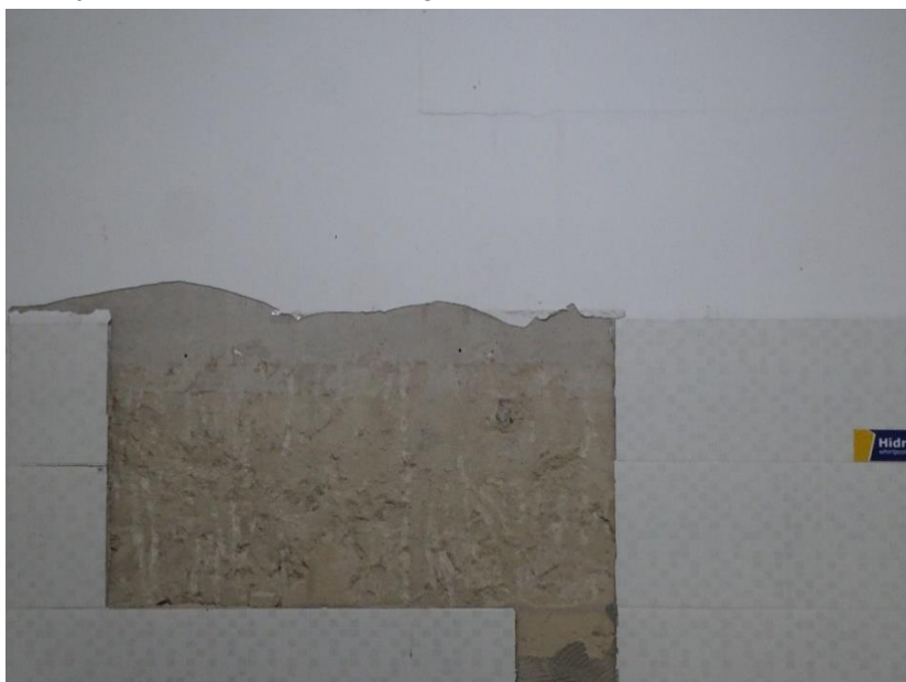
Figura C.172 – Vestiário 5 – Destacamento do revestimento de azulejos na sala da hidromassagem.
