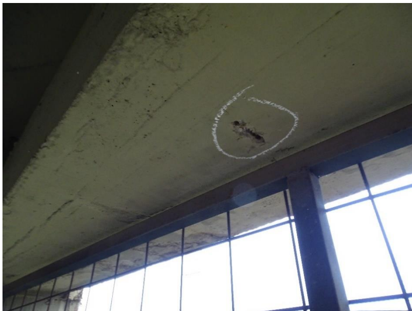
Figura C.113 – Fachada Leste – Armadura exposta em viga de travamento região entre os pilares P126 e P128.
