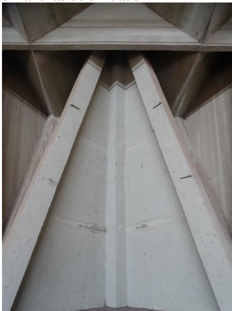
Figura C.67 – Face interna da fachada Leste na região do Elemento 10 – Junta de concretagem com fissuras reparadas e manchas de umidade.
