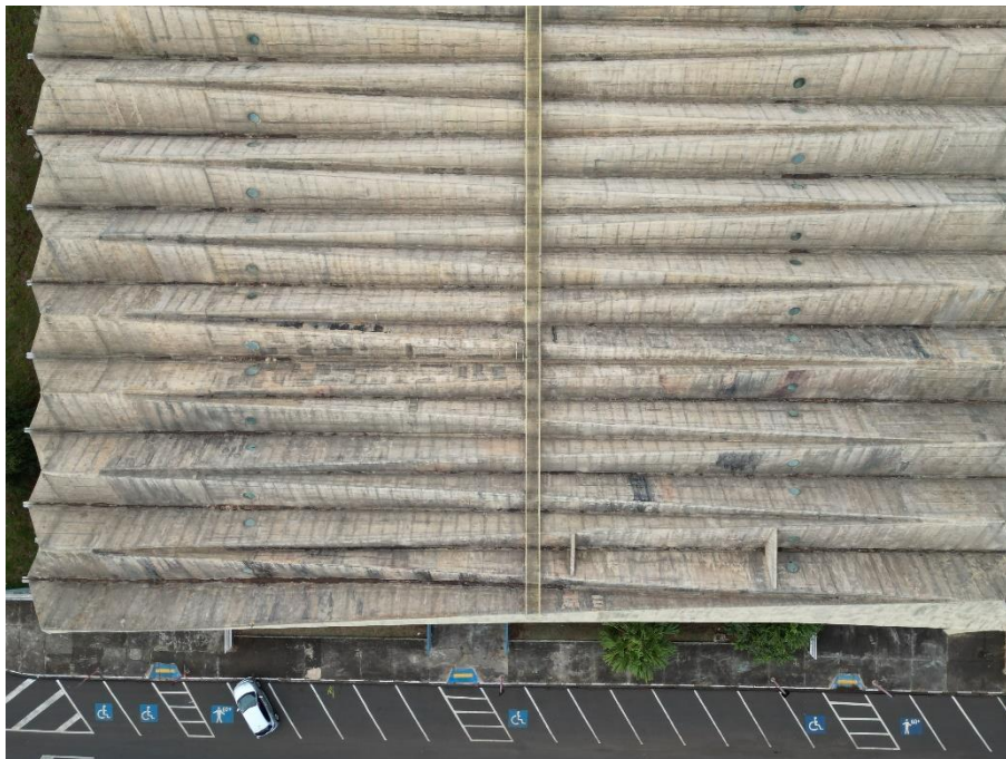
Figura B.6 – Vista superior da cobertura do ginásio entre os elementos 1 e 8. Nota-se maior concentração manchas escuras entre os elementos 1 a 4.
