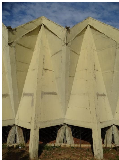
Figura C.27 – Face externa da fachada Oeste na região do Elemento 14 – Junta de concretagem com fissuras reparadas e manchas de umidade.
