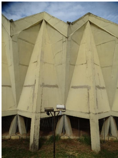
Figura C.11 – Face externa da fachada Oeste na região do Elemento 5 – Junta de concretagem com fissuras reparadas e manchas de umidade.
