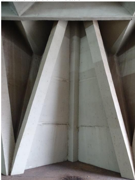
Figura C.55 – Face interna da fachada Leste na região do Elemento 4 – Junta de concretagem com fissuras reparadas e manchas de umidade.
