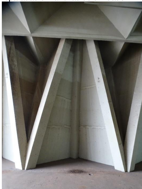
Figura C.20 – Face interna da fachada oeste na região entre os Elementos 9 e 10 – Junta de concretagem com fissuras reparadas e manchas de umidade.
