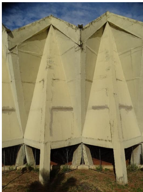
Figura C.30 – Face externa da fachada Oeste na região do Elemento 16 – Junta de concretagem com fissuras reparadas e manchas de umidade.
