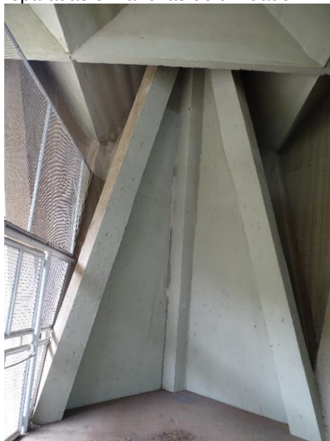
Figura C.89 – Face interna da fachada Leste na região do Elemento 21 – Junta de concretagem com fissuras reparadas e manchas de umidade.
