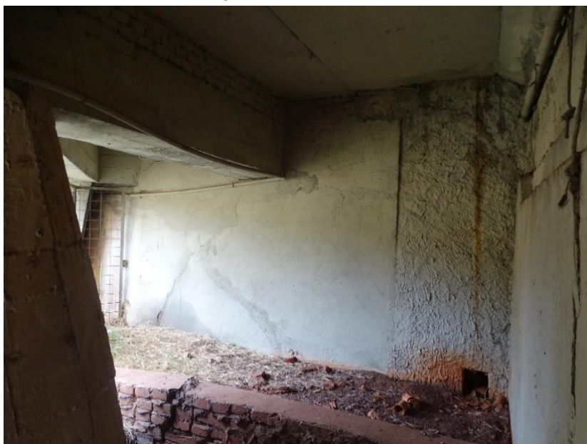
Figura C.102 – Fachada Oeste – Muro de contenção do terreno com manchas de umidade e algumas trincas.
