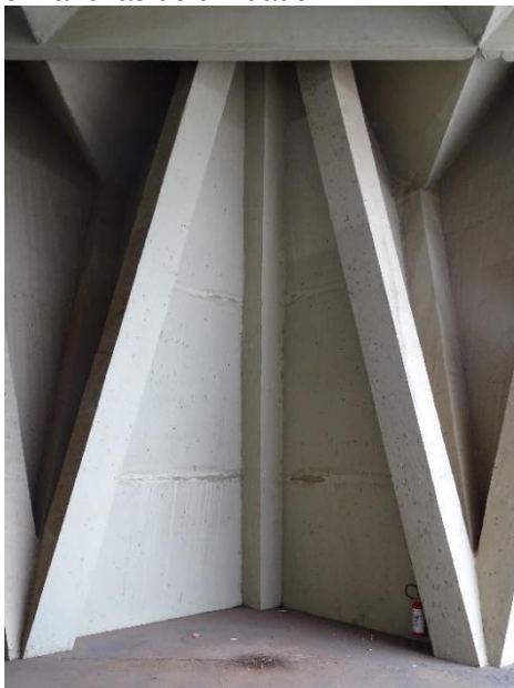
Figura C.51 – Face interna da fachada Leste na região do Elemento 2 – Junta de concretagem com fissuras reparadas e manchas de umidade.
