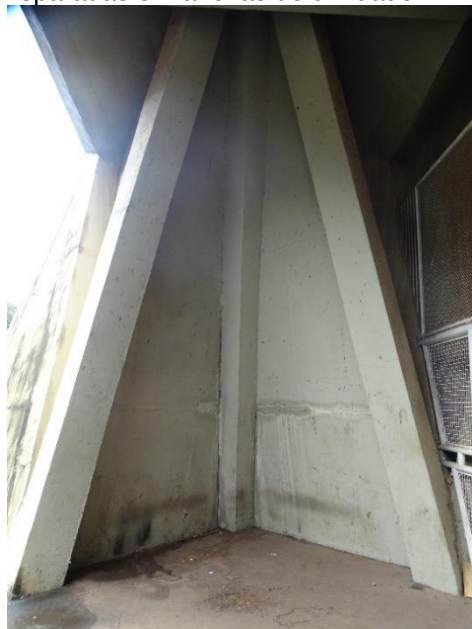
Figura C.91 – Face interna da fachada Leste na região do Elemento 22 – Junta de concretagem com fissuras reparadas e manchas de umidade.
