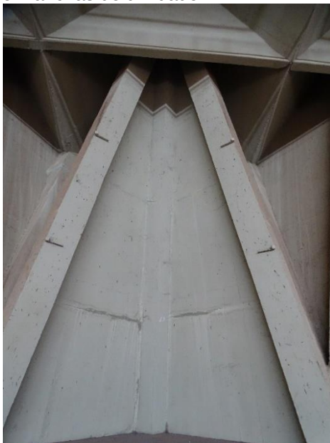
Figura C.73 – Face interna da fachada Leste na região do Elemento 13 – Junta de concretagem com fissuras reparadas e manchas de umidade.
