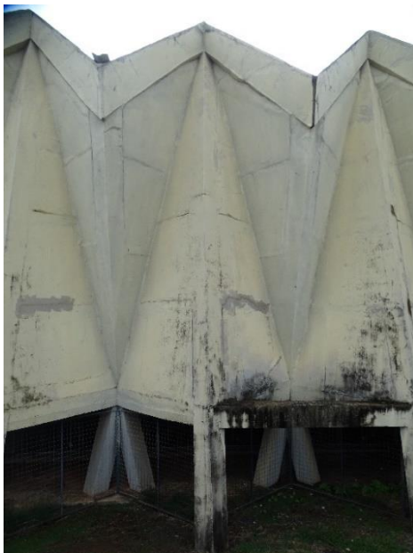
Figura C.86 – Face externa da fachada Leste na região do Elemento 20 – Junta de concretagem com fissuras reparadas e manchas de umidade.
