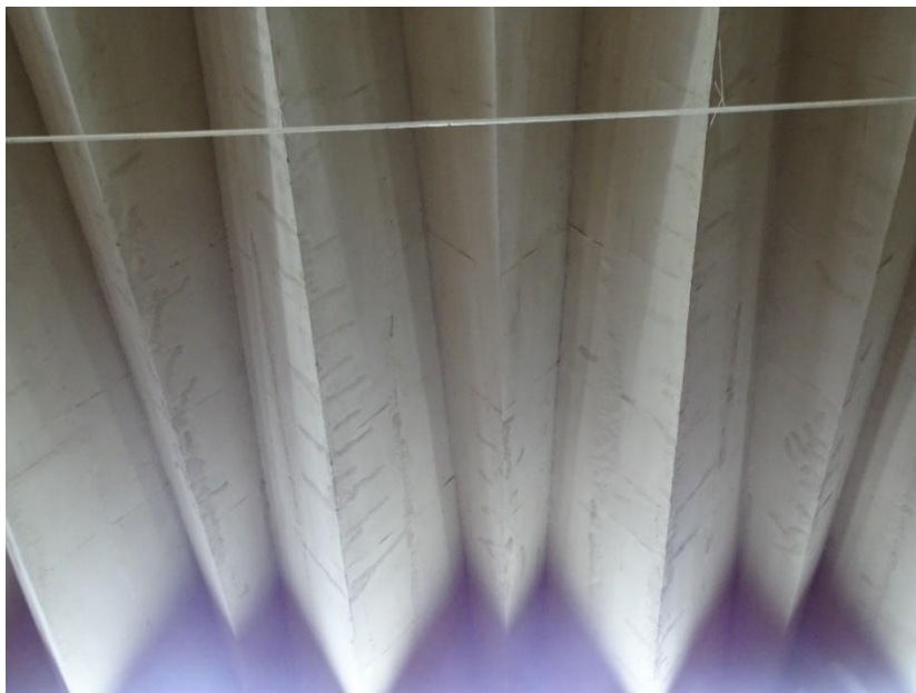
Figura C.145 – Outro das fissuras da reparadas, sem manchas de umidade nem de evolução das aberturas.
