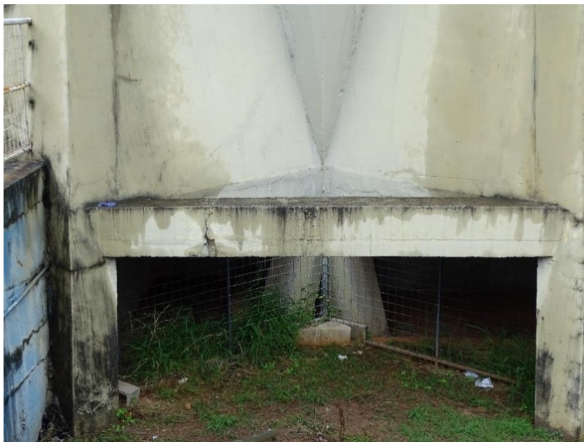
Figura C.105 – Fachada Oeste – Trinca na viga de travamento entre os pilares P86 e P90.
