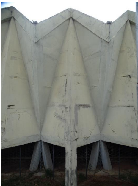
Figura C.78 – Face externa da fachada Leste na região do Elemento 16 – Junta de concretagem com fissuras reparadas e manchas de umidade.
