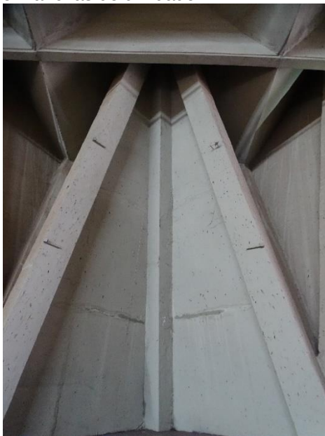
Figura C.61 – Face interna da fachada Leste na região do Elemento 7 – Junta de concretagem com fissuras reparadas e manchas de umidade.
