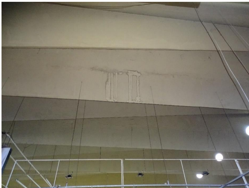
Figura C.125 – Elemento 5 – Fissura em junta de concretagem com mancha de umidade devido à deficiência na impermeabilização.
