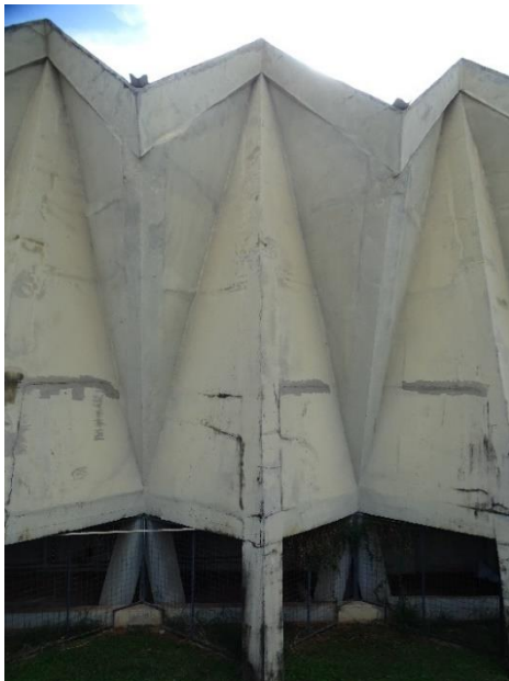
Figura C.56 – Face externa da fachada Leste na região do Elemento 5 – Junta de concretagem com fissuras reparadas e manchas de umidade.
