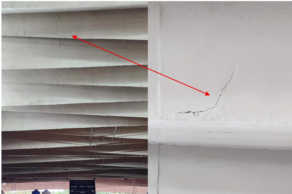
Figura 31 – Elemento 14 com fissura superior a 0,3 mm.
