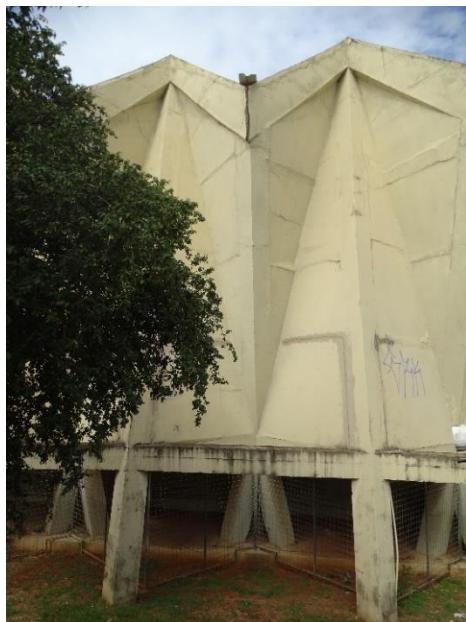
Figura C.5 – Face externa da fachada Oeste na região do Elemento 2 – Junta de concretagem com fissuras reparadas e manchas de umidade.
