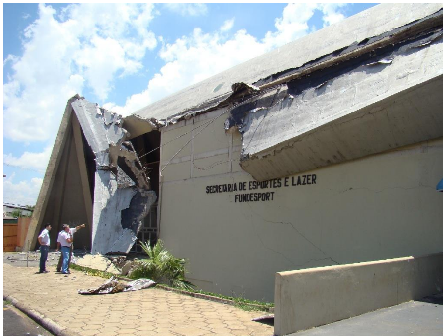
Figura 4 – Vista da viga elemento 1 rompida em 2010.
