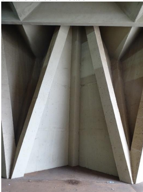
Figura C.53 – Face interna da fachada Leste na região do Elemento 3 – Junta de concretagem com fissuras reparadas e manchas de umidade.
