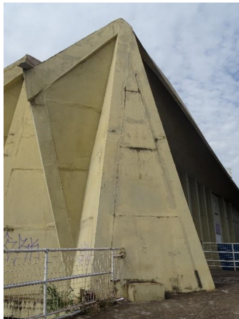
Figura C.1 – Face externa da fachada oeste na região extrema do Elemento 1 – Junta de concretagem com fissuras reparadas e manchas de umidade.
