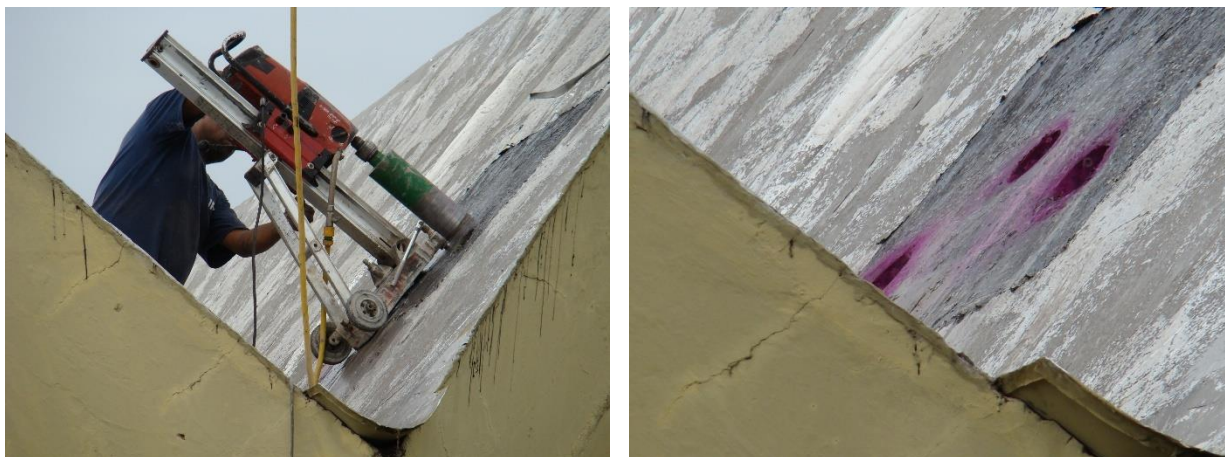
Figura 6 – Extração de testemunhos e avaliação da profundidade de carbonatação.
