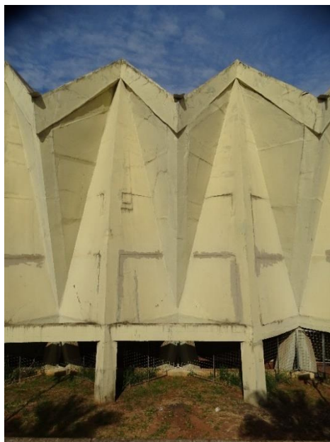
Figura C.38 – Face externa da fachada Oeste na região do Elemento 20 – Junta de concretagem com fissuras reparadas e manchas de umidade.
