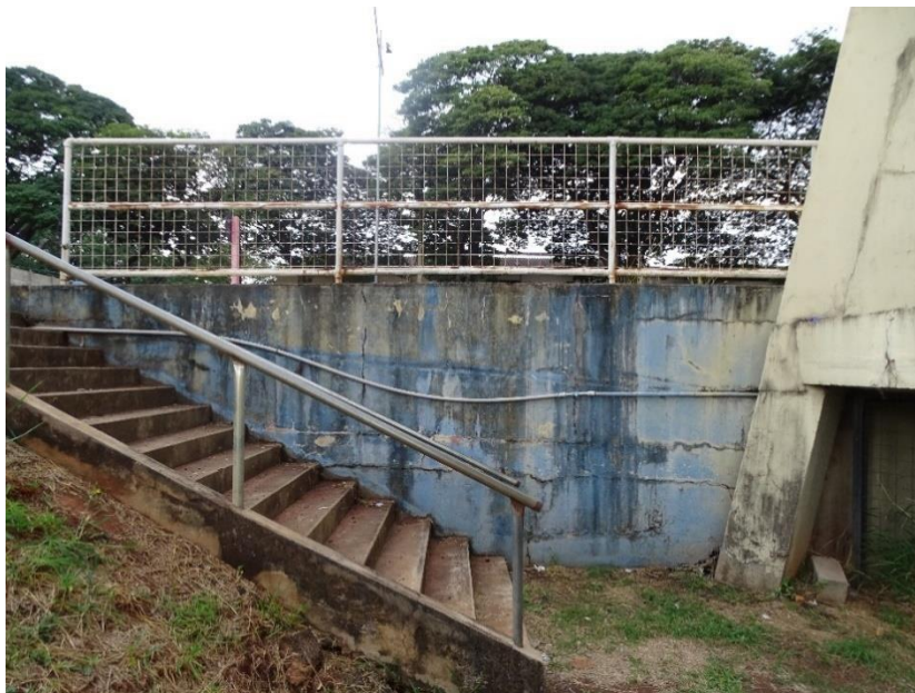
Figura C.103 – Fachada Oeste – Outro trecho do muro de contenção do terreno apresentando manchas de umidade e algumas trincas.
