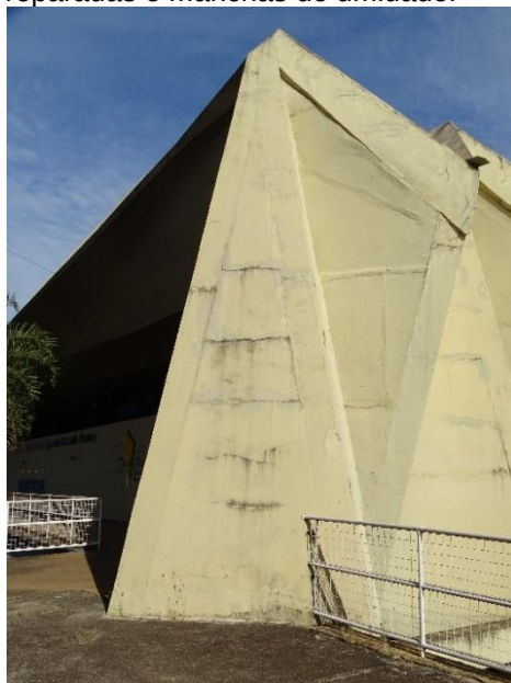
Figura C.44 – Face externa da fachada Oeste na região extrema do Elemento 22 – Junta de concretagem com fissuras reparadas e manchas de umidade.
