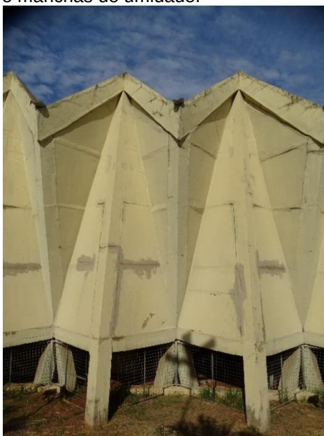
Figura C.34 – Face externa da fachada Oeste na região do Elemento 18 – Junta de concretagem com fissuras reparadas e manchas de umidade.
