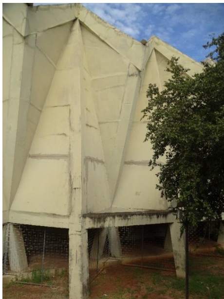
Figura C.7 – Face externa da fachada Oeste na região do Elemento 3 – Junta de concretagem com fissuras reparadas e manchas de umidade.
