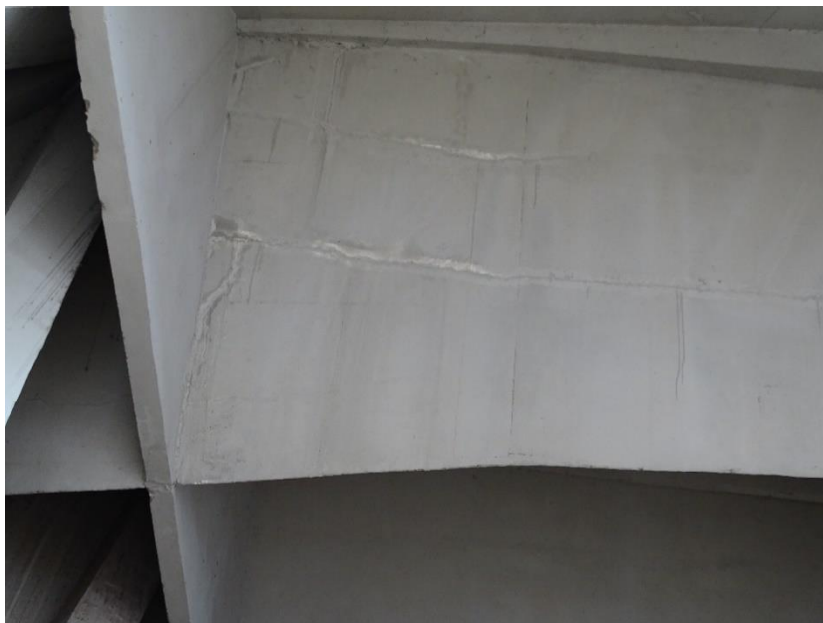
Figura C.123 – Elemento 2 – Fissura com mancha de umidade devido à deficiência na impermeabilização.
