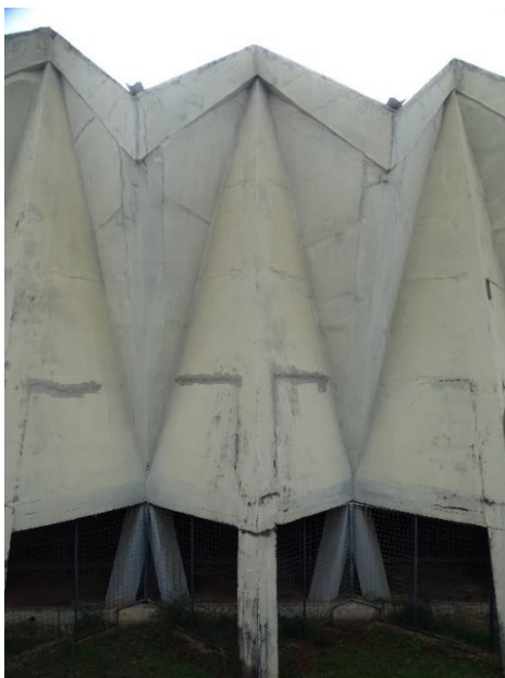
Figura C.70 – Face externa da fachada Leste na região do Elemento 12 – Junta de concretagem com fissuras reparadas e manchas de umidade.
