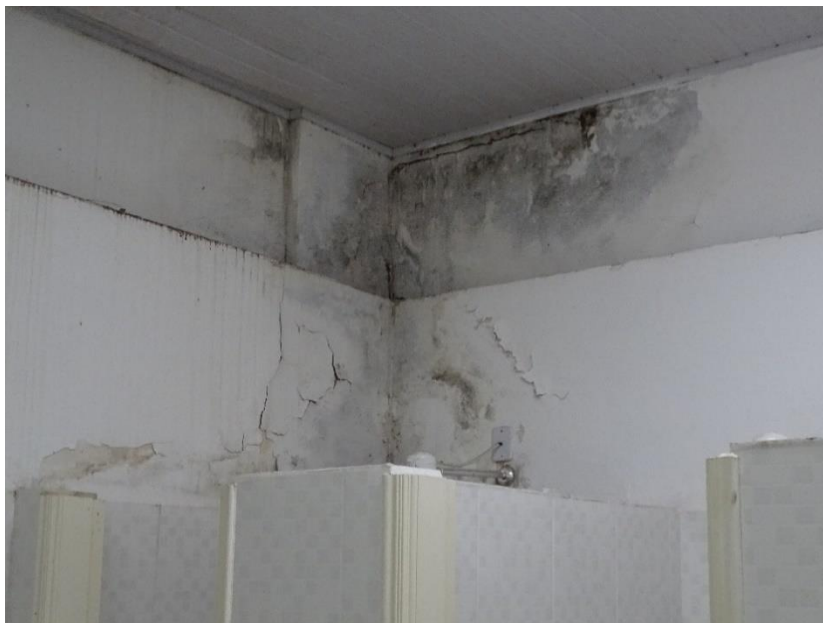
Figura C.171 – Vestiário 5 – Outra vista da mancha de umidade junto a ligação dos painéis de alvenaria.
