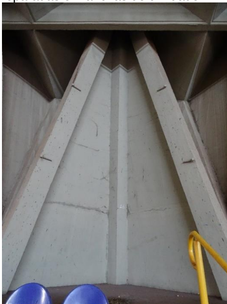
Figura C.79 – Face interna da fachada Leste na região do Elemento 16 – Junta de concretagem com fissuras reparadas e manchas de umidade.
