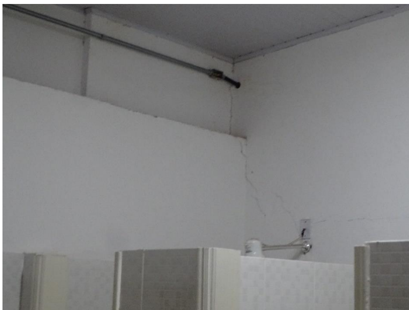
Figura C.168 – Vestiário 4 – Fissura junto a ligação dos painéis de alvenaria.
