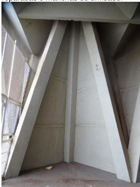
Figura C.4 – Face interna da fachada oeste na região entre os Elemento 1 e 2 – Junta de concretagem com fissuras reparadas e manchas de umidade.
