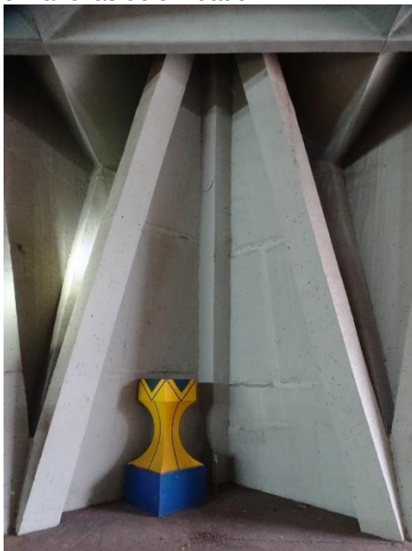
Figura C.57 – Face interna da fachada Leste na região do Elemento 5 – Junta de concretagem com fissuras reparadas e manchas de umidade.
