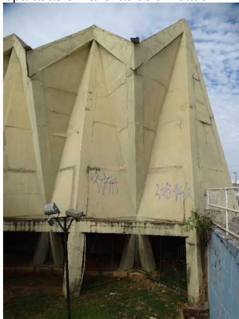
Figura C.3 – Face externa da fachada oeste na região do Elemento 1 – Junta de concretagem com fissuras reparadas e manchas de umidade.
