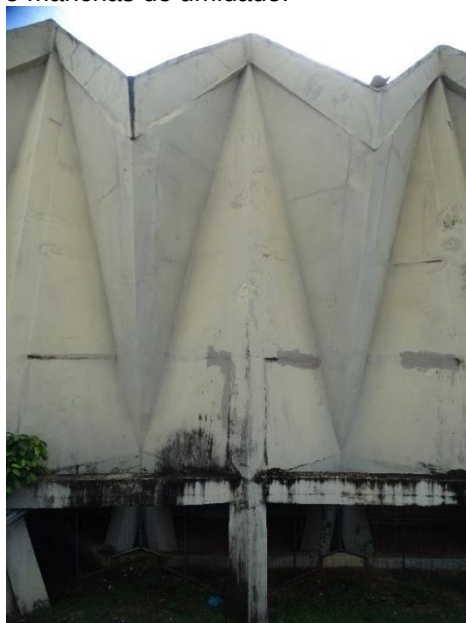
Figura C.50 – Face externa da fachada Leste na região do Elemento 2 – Junta de concretagem com fissuras reparadas e manchas de umidade.
