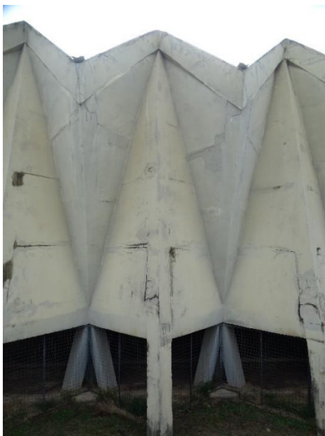
Figura C.74 – Face externa da fachada Leste na região do Elemento 14 – Junta de concretagem com fissuras reparadas e manchas de umidade.
