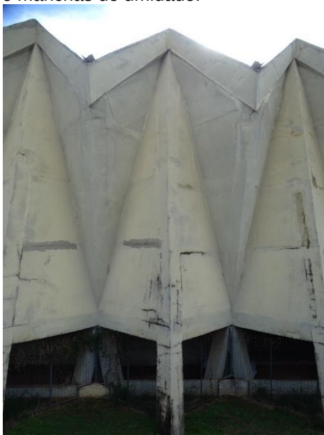
Figura C.58 – Face externa da fachada Leste na região do Elemento 6 – Junta de concretagem com fissuras reparadas e manchas de umidade.
