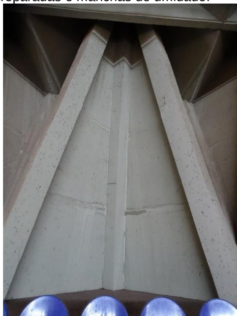
Figura C.24 – Face interna da fachada oeste na região entre os Elemento 11 e 12 – Junta de concretagem com fissuras reparadas e manchas de umidade.
