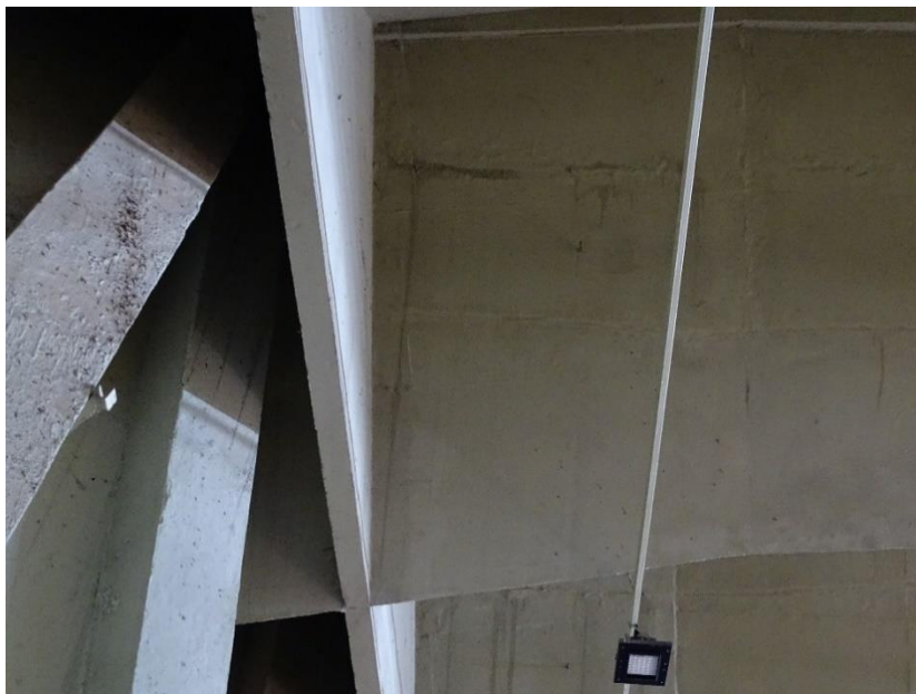
Figura C.139 – Elemento 17 - Face 1 – Fissura em junta de concretagem com mancha de umidade.
