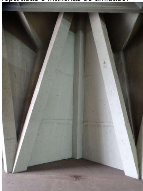
Figura C.12 – Face interna da fachada oeste na região entre os Elemento 5 e 6 – Junta de concretagem com fissuras reparadas e manchas de umidade.
