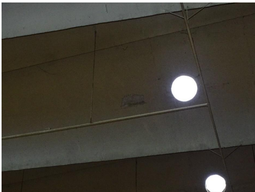
Figura C.140 – Elemento 18 - Face 4 – Fissura com mancha de umidade.
