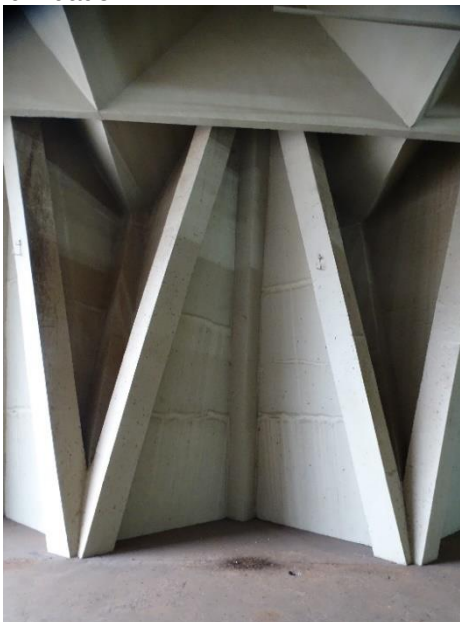
Figura C.10 – Face interna da fachada oeste na região entre os Elemento 4 e 5 – Junta de concretagem com fissuras reparadas e manchas de umidade.
