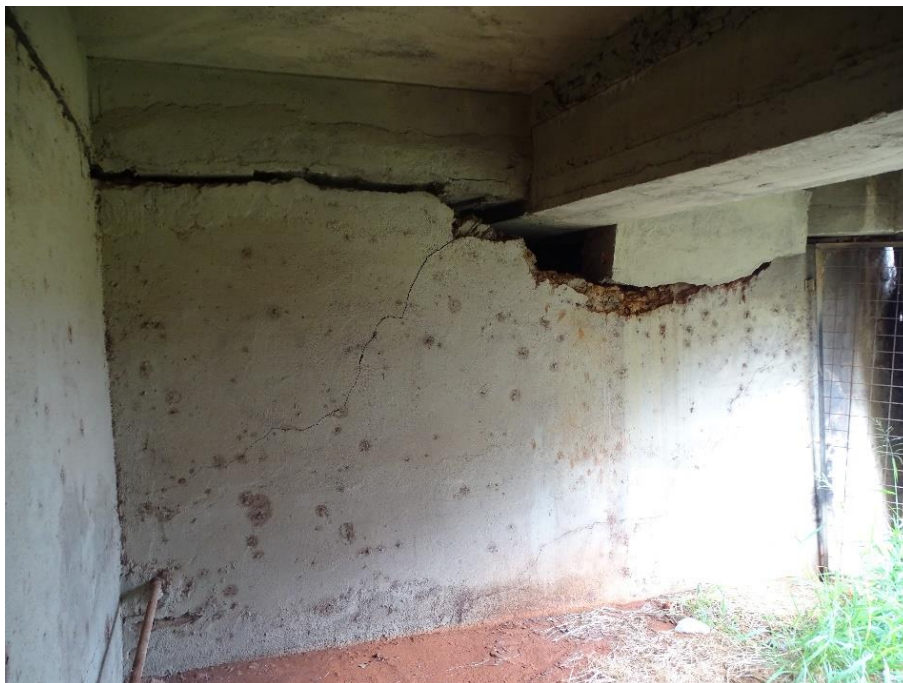
Figura 27 – Fachada Oeste – Muro de contenção do terreno com indício de recalque, parcialmente desmoronado e apresentando trincas.
