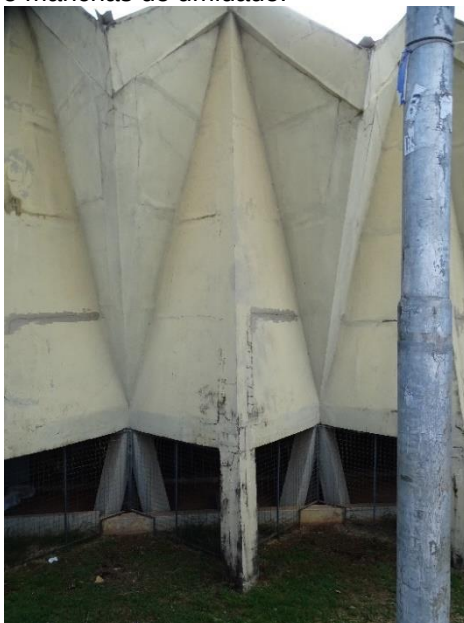
Figura C.62 – Face externa da fachada Leste na região do Elemento 8 – Junta de concretagem com fissuras reparadas e manchas de umidade.
