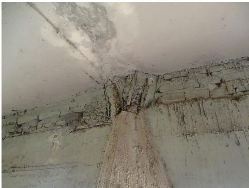
Figura C.99 – Vigas de travamento na fachada Oeste – Concreto disgregado e armaduras expostas no topo do pilar P4.
