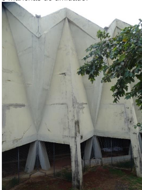
Figura C.60 – Face externa da fachada Leste na região do Elemento 7 – Junta de concretagem com fissuras reparadas e manchas de umidade.
