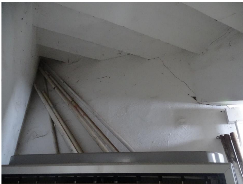
Figura C.159 – Vista inferior do módulo de arquibancada C “Escada”. Fissura no contato da alvenaria com a estrutura de da arquibancada
