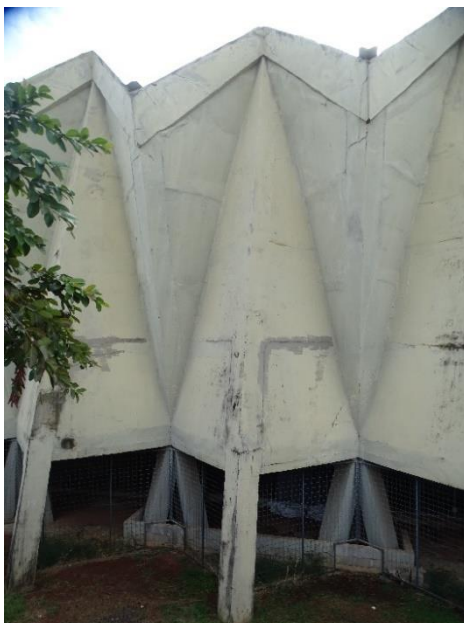
Figura C.82 – Face externa da fachada Leste na região do Elemento 18 – Junta de concretagem com fissuras reparadas e manchas de umidade.
