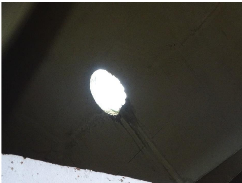
Figura C.124 – Elemento 2 – Fissura em junta de concretagem e mancha de umidade no entorno da claraboia.
