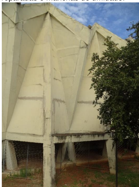
Figura C.26 – Face externa da fachada Oeste na região do Elemento 13 – Junta de concretagem com fissuras reparadas e manchas de umidade.
