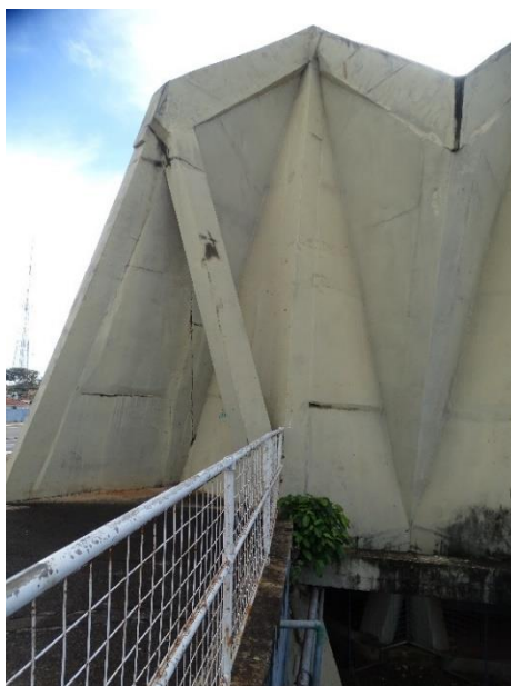
Figura C.48 – Face externa da fachada Leste na região do Elemento 1 – Junta de concretagem com fissuras reparadas e manchas de umidade.
