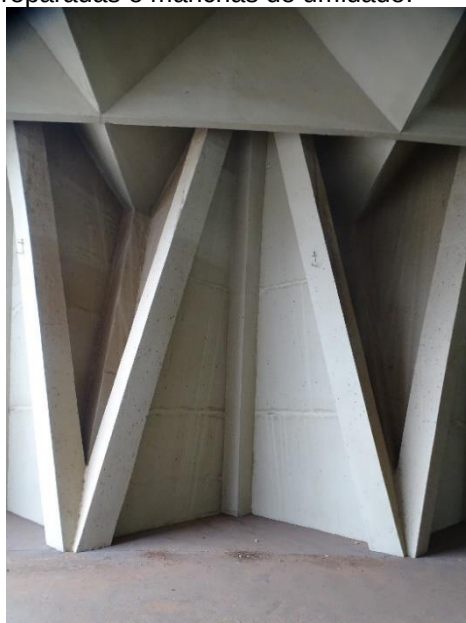
Figura C.6 – Face interna da fachada oeste na região entre os Elemento 2 e 3 – Junta de concretagem com fissuras reparadas e manchas de umidade.
