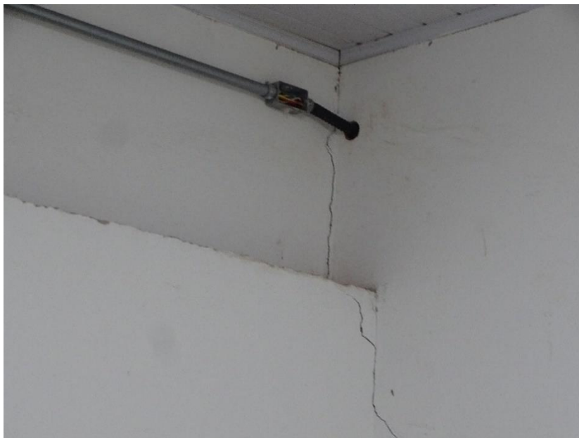
Figura C.169 – Vestiário 4 – Outra vista da fissura junto a ligação dos painéis de alvenaria.
