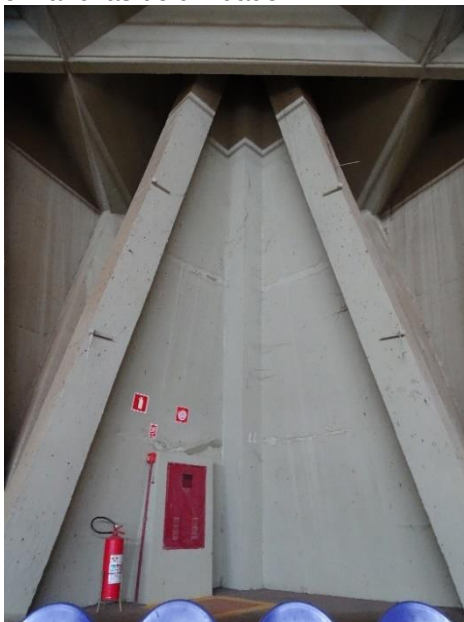
Figura C.69 – Face interna da fachada Leste na região do Elemento 11 – Junta de concretagem com fissuras reparadas e manchas de umidade.
