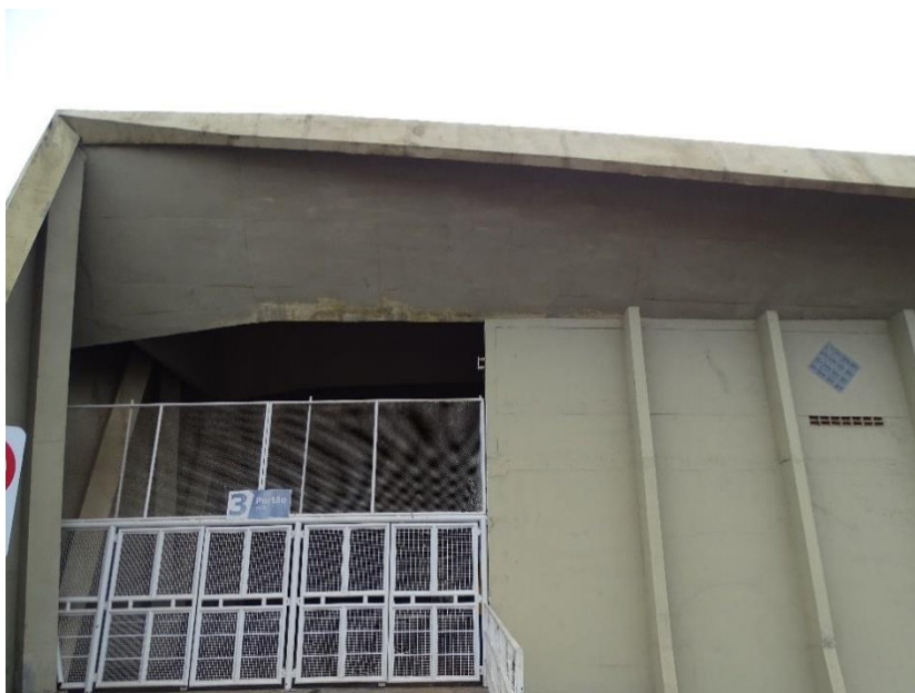
Figura C.121 – Elemento 1 – Manchas de umidade no vértice devido à deficiência na impermeabilização, na extremidade junto a fachada Oeste.
