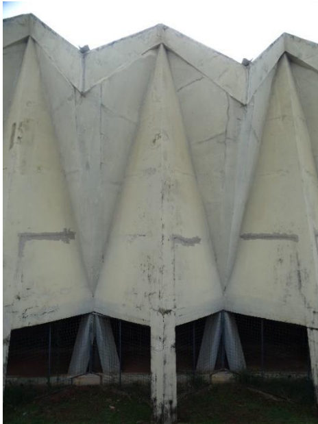
Figura C.68 – Face externa da fachada Leste na região do Elemento 11 – Junta de concretagem com fissuras reparadas e manchas de umidade.
