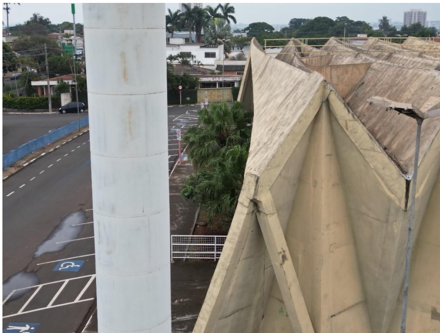
Figura 21 – Deformação construtiva do elemento 1.
