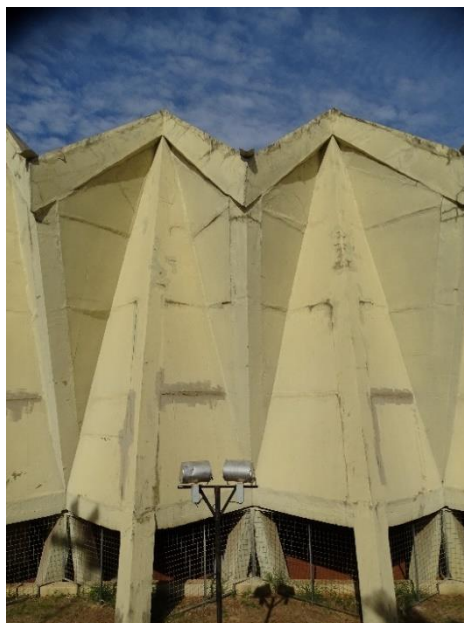
Figura C.32 – Face externa da fachada Oeste na região do Elemento 17 – Junta de concretagem com fissuras reparadas e manchas de umidade.
