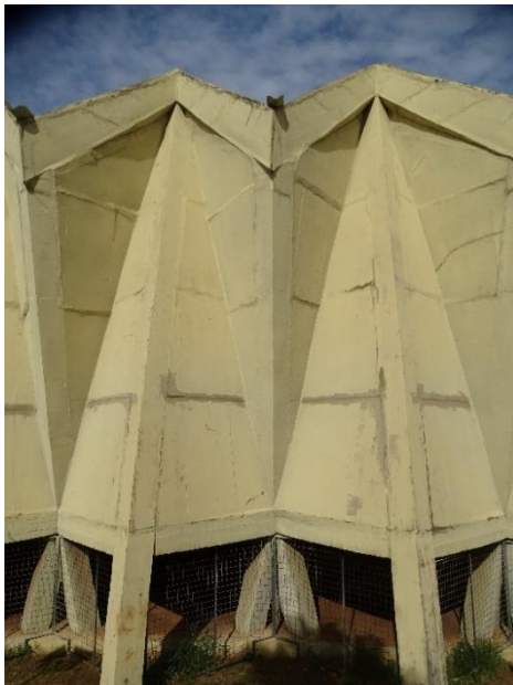
Figura C.15 – Face externa da fachada Oeste na região do Elemento 7 – Junta de concretagem com fissuras reparadas e manchas de umidade.
