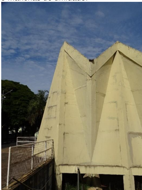
Figura C.42 – Face externa da fachada Oeste na região do Elemento 22 – Junta de concretagem com fissuras reparadas e manchas de umidade.
