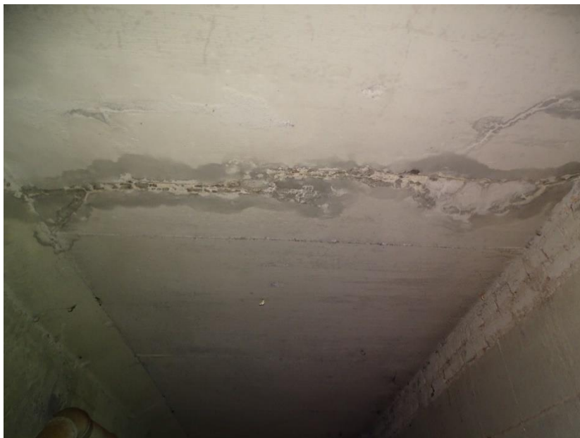
Figura C.110 – Fachada Leste – Fissura com manchas de umidade em laje região próxima ao pilar P114.
