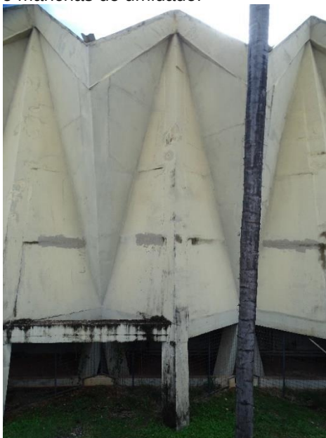
Figura C.52 – Face externa da fachada Leste na região do Elemento 3 – Junta de concretagem com fissuras reparadas e manchas de umidade.
