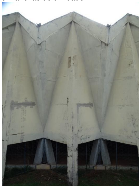
Figura C.66 – Face externa da fachada Leste na região do Elemento 10 – Junta de concretagem com fissuras reparadas e manchas de umidade.
