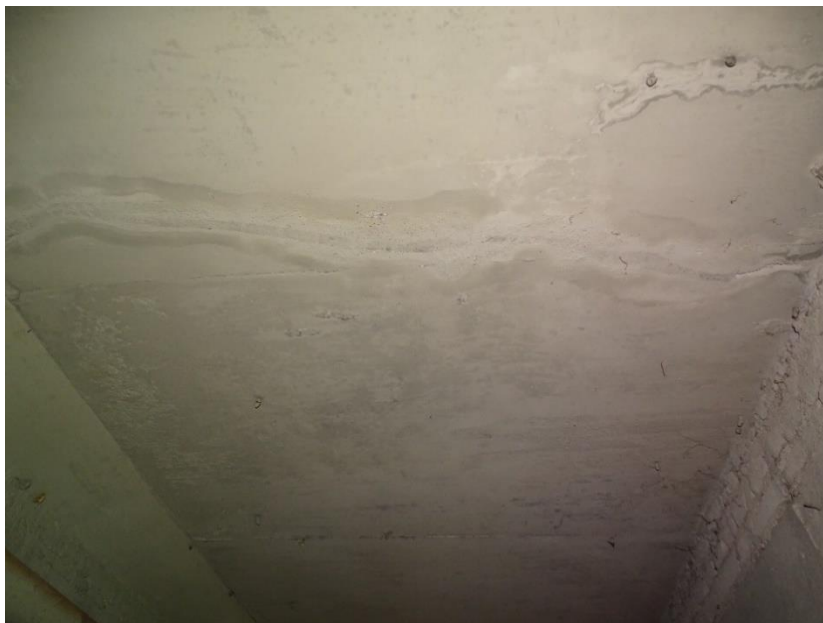
Figura C.111 – Fachada Leste – Fissura com manchas de umidade em laje região próxima ao pilar P118.
