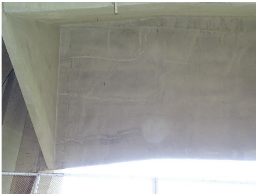
Figura C.141 – Elemento 22 - Face 2 – Fissuras reparadas sem indícios de evolução.
