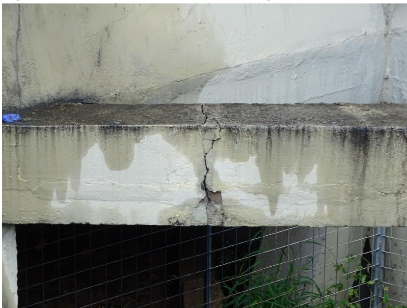
Figura 30 – Detalhe da trinca mostrada na Figura 29.
