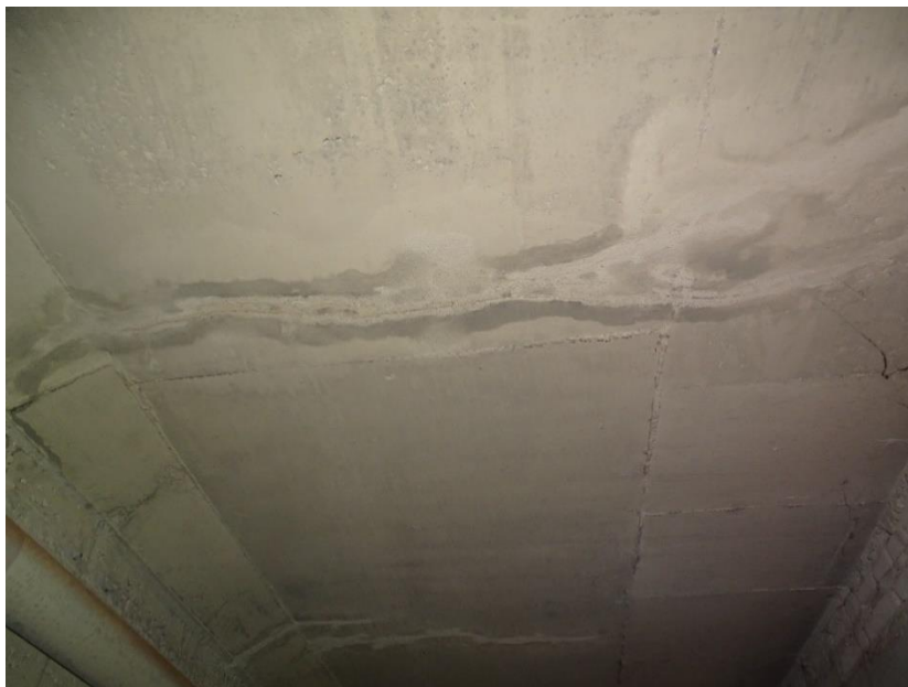
Figura C.115 – Fachada Leste – Fissura com manchas de umidade em laje região próxima ao pilar P134.
