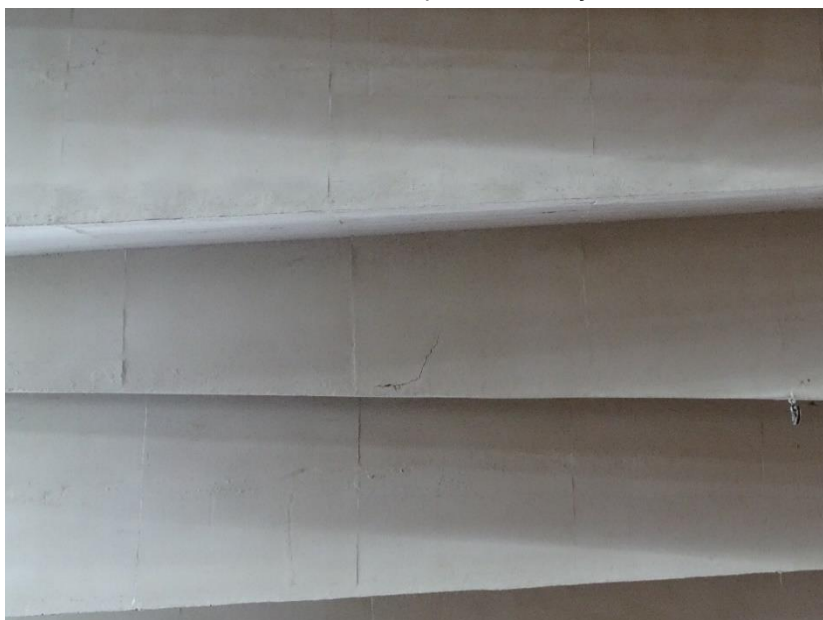
Figura C.134 – Elemento 14 - Face 4 – Fissura com mancha de umidade devido à deficiência na impermeabilização.
