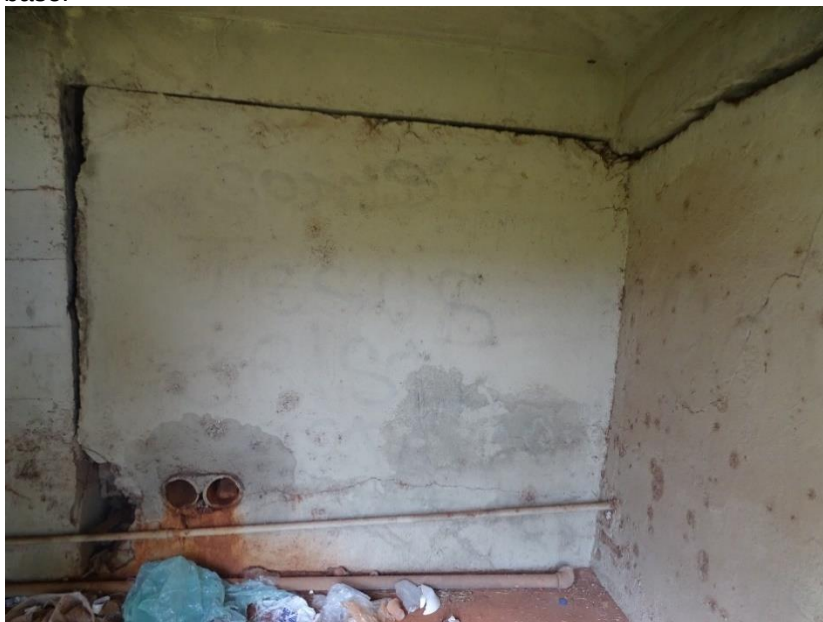
Figura C.95 – Fachada Oeste – Outro trecho do muro de contenção do terreno com indício de recalque, devido a empoçamento d’água na base.
