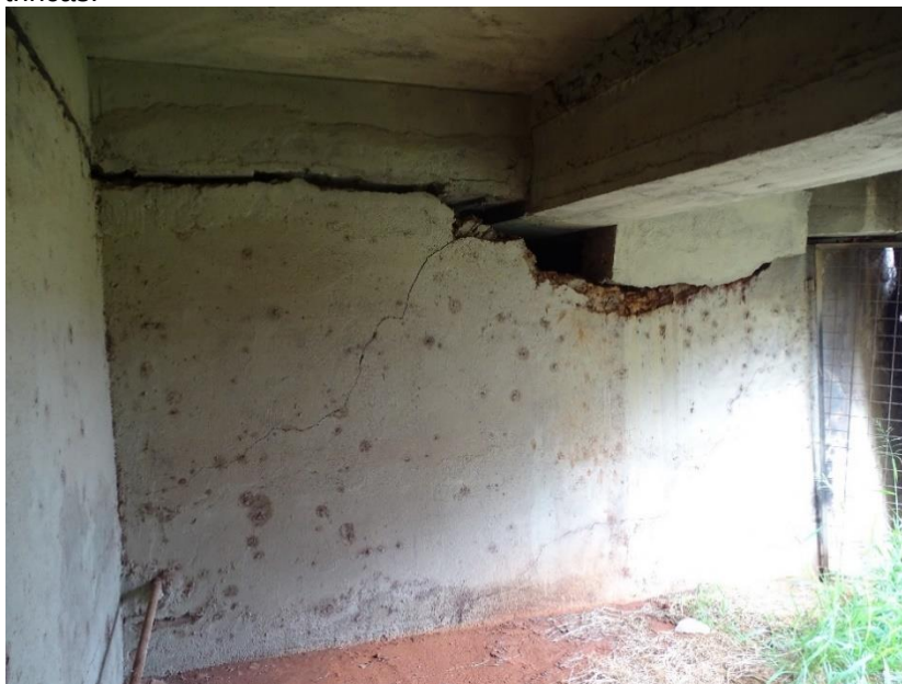
Figura C.93 – Fachada Oeste – Muro de contenção do terreno com indício de recalque, parcialmente desmoronado e apresentando trincas.
