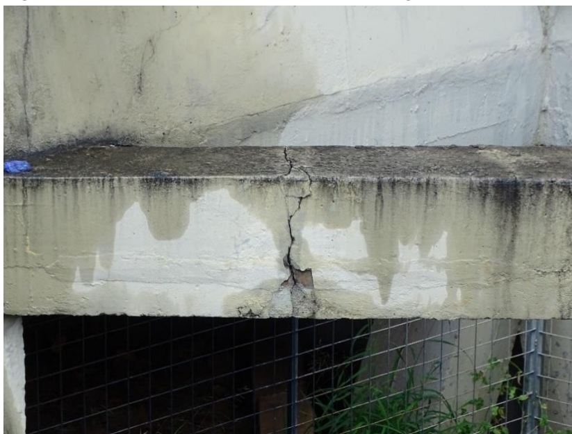
Figura C.106 – Detalhe da trinca mostrada na Figura C.105.
