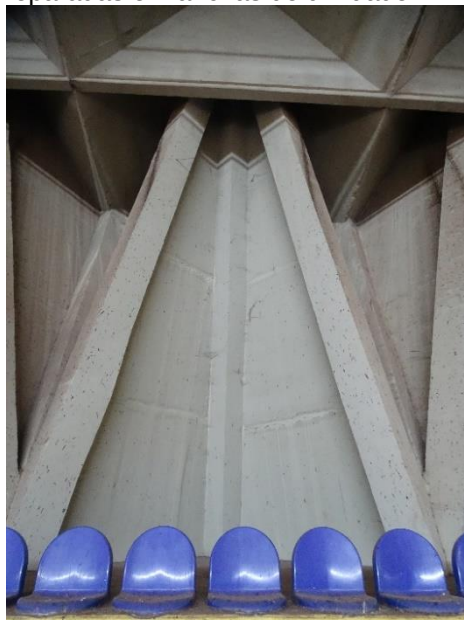
Figura C.29 – Face interna da fachada oeste na região entre os Elementos 14 e 15 – Junta de concretagem com fissuras reparadas e manchas de umidade.
