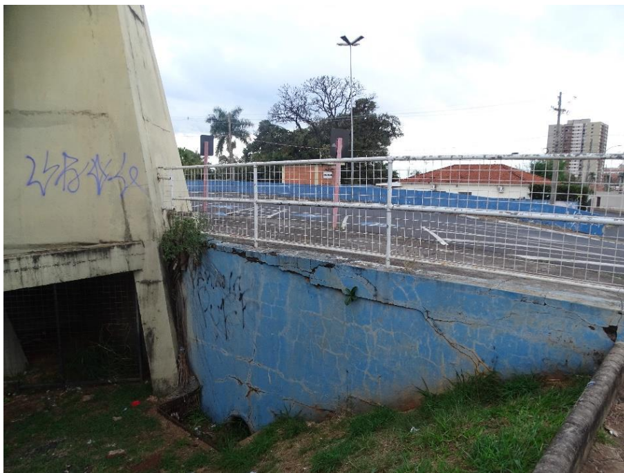
Figura 28 – Fachada Oeste – Outro trecho do muro de contenção do terreno com deslocamentos e trincas.
