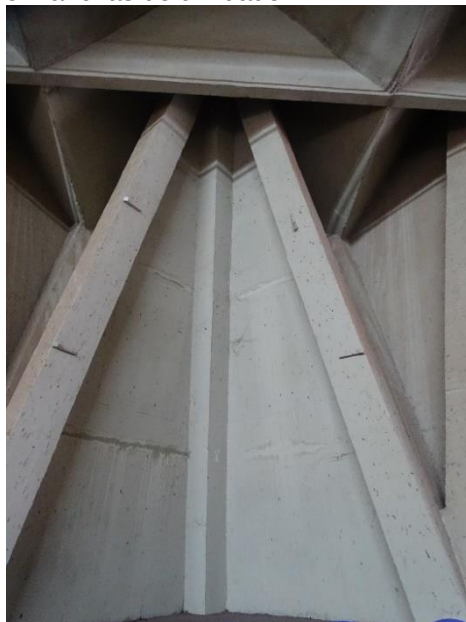
Figura C.63 – Face interna da fachada Leste na região do Elemento 8 – Junta de concretagem com fissuras reparadas e manchas de umidade.
