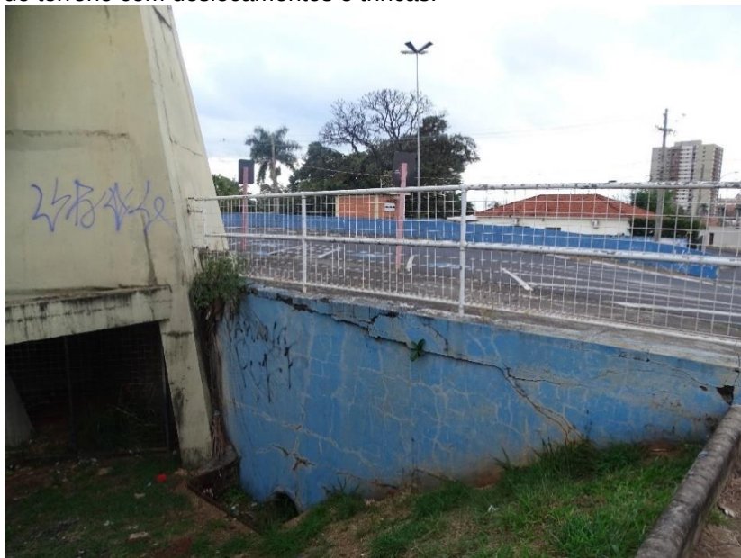
Figura C.96 – Fachada Oeste – Outro trecho do muro de contenção do terreno com deslocamentos e trincas.
