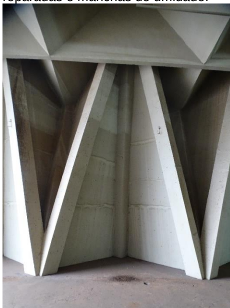
Figura C.18 – Face interna da fachada oeste na região entre os Elementos 8 e 9 – Junta de concretagem com fissuras reparadas e manchas de umidade.
