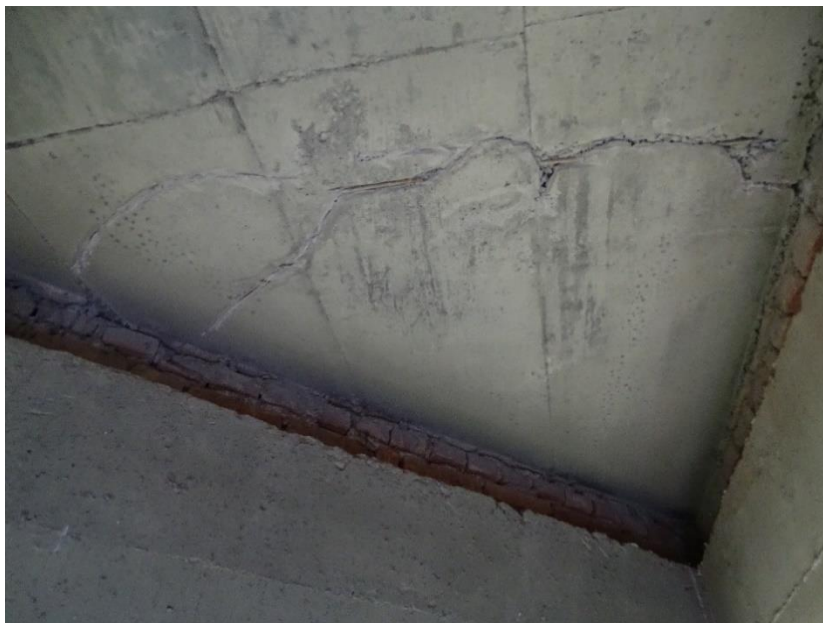
Figura C.117 – Fachada Leste – Fissuras não reparadas com manchas de umidade em laje região próxima ao pilar P146.
