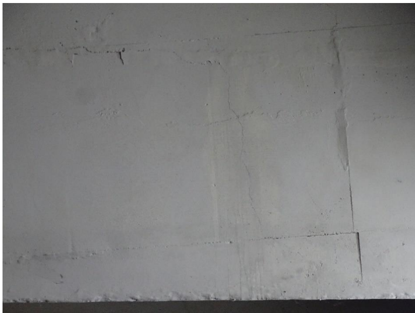
Figura C.132 – Elemento 12 - Face 3 – Fissura não reparada, em junta de concretagem.
