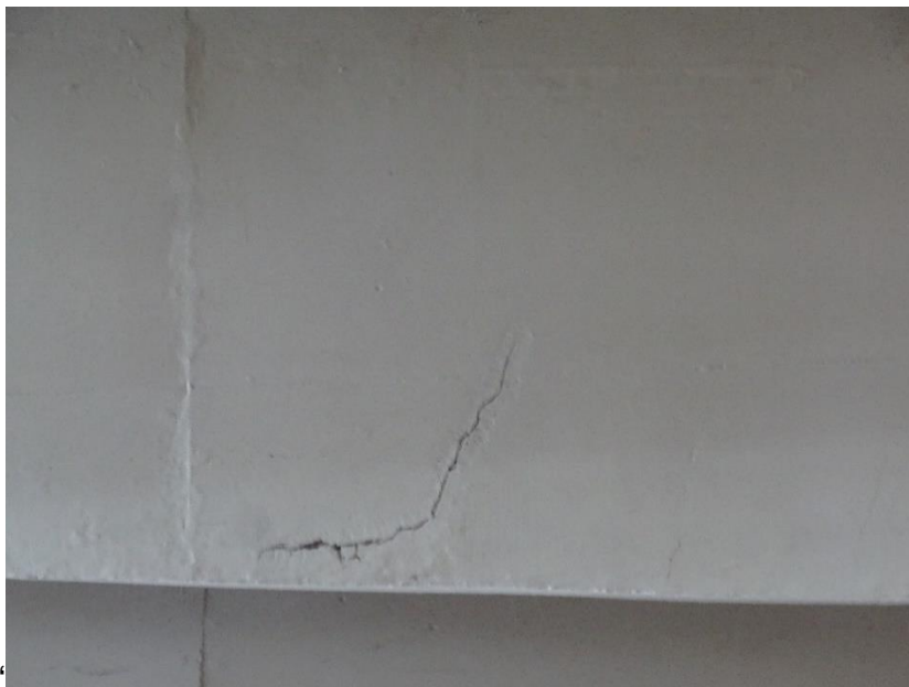
Figura C.135 – Elemento 14 - Face 4 – Detalhe da fissura mostrada na Figura C.134.
