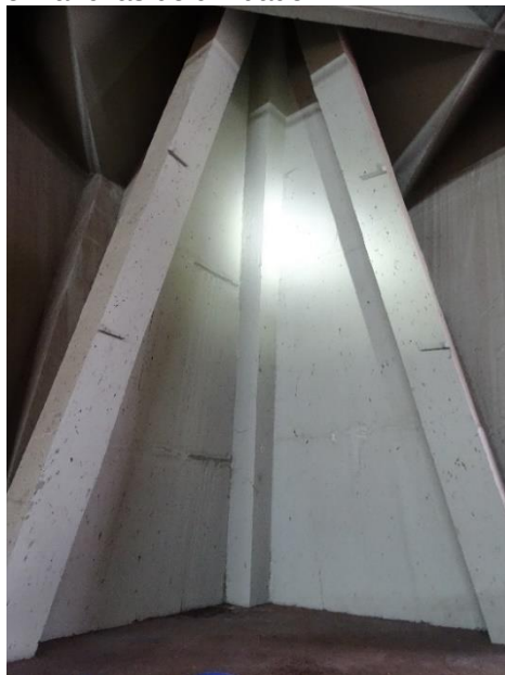
Figura C.59 – Face interna da fachada Leste na região do Elemento 6 – Junta de concretagem com fissuras reparadas e manchas de umidade.
