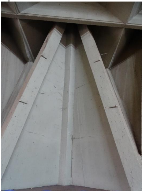
Figura C.81 – Face interna da fachada Leste na região do Elemento 17 – Junta de concretagem com fissuras reparadas e manchas de umidade.
