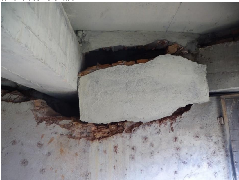
Figura C.94 – Fachada Oeste – Detalhe do muro de contenção do terreno desmoronado.
