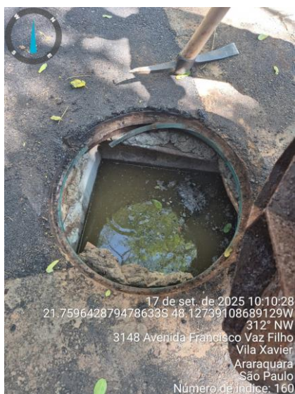
Figura 01 – Poço de Visitação entupido
