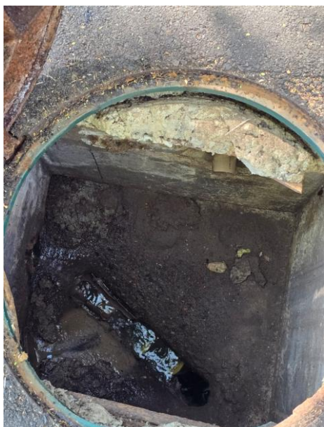
Figura 03 – Diâmetro de 100 mm e havia vazamento da tubulação sanado pelo DAAE
