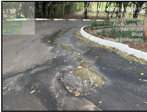
Figura 32 – Vazamento do PV (esgoto) na saída da Zoonoses/Bem-Estar Animal que, segundo servidores do parque, recebe manutenção semanal do DAAE. Neste ponto, há estrangulamento da rede coletora.
