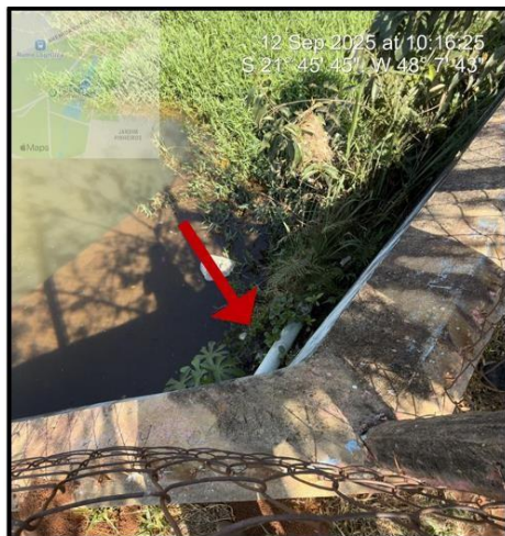
Figura 34 – Tubulação de esgoto ou de drenagem, na direção do PV de esgoto, que adentra na represa para banho.
