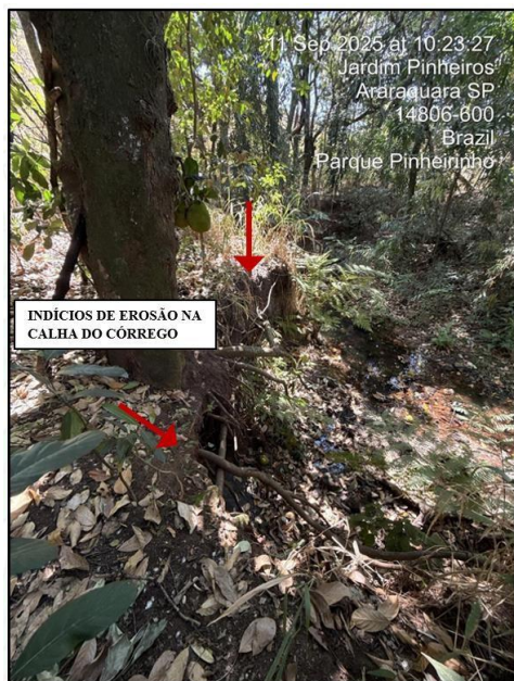
Figura 22 - Erosão no leito do Córrego em trecho anterior aos reservatórios, onde antigamente era efetuada captação de água para abastecimento do Município.
