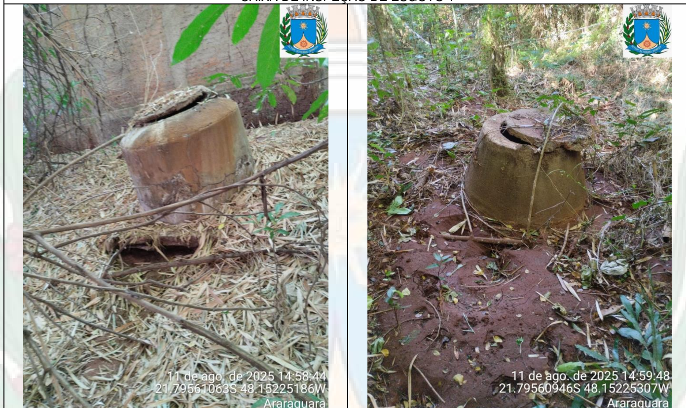
CAIXA DE INSPEÇÃO DE ESGOTO 1
