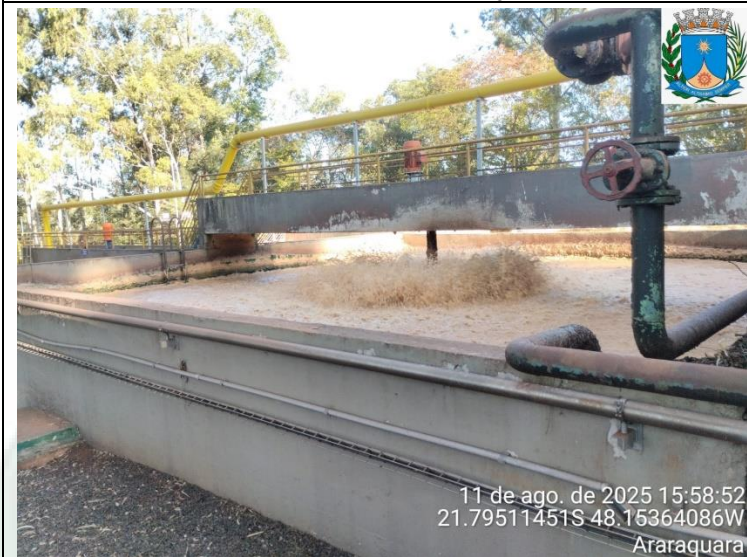
TANQUE DE FLOCULAÇÃO
