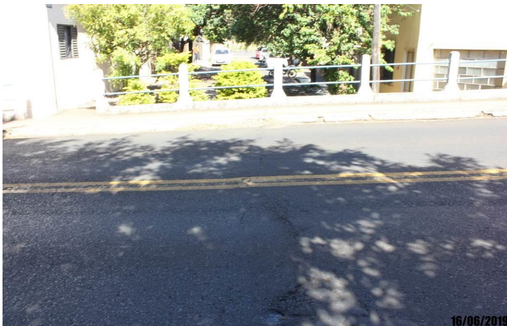
Foto 03: Face superior do tabuleiro apresentando fissuras.
