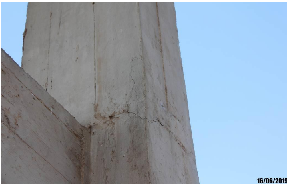
Foto 71: Detalhe de deslocamento de concreto.
