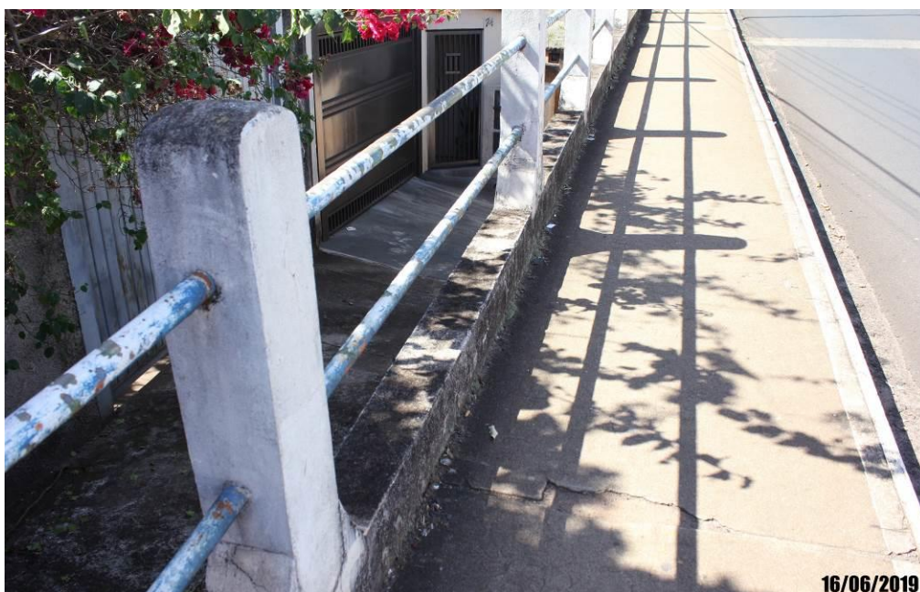
Foto 14: Detalhe da pintura do guarda corpo descascado.
