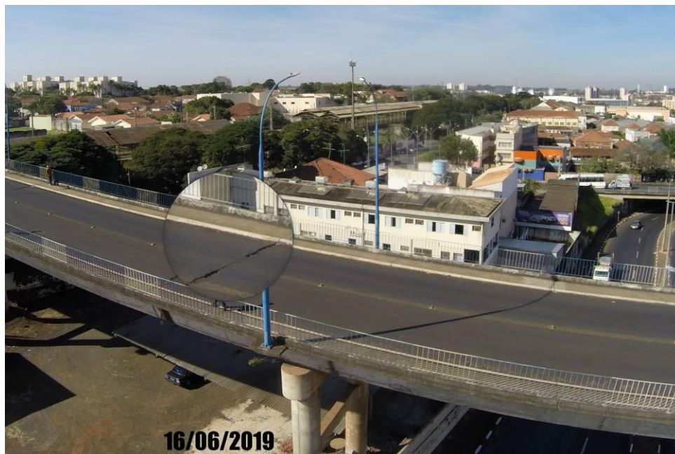
Foto 06: Vista da junta de dilatação deteriorada.
