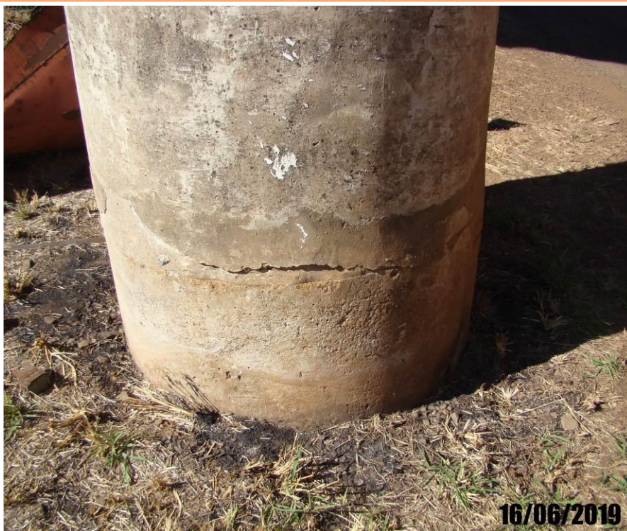
Foto 60: Detalhe de deslocamento de concreto.
