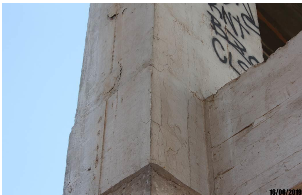
Foto 72: Detalhe de deslocamento de concreto.
