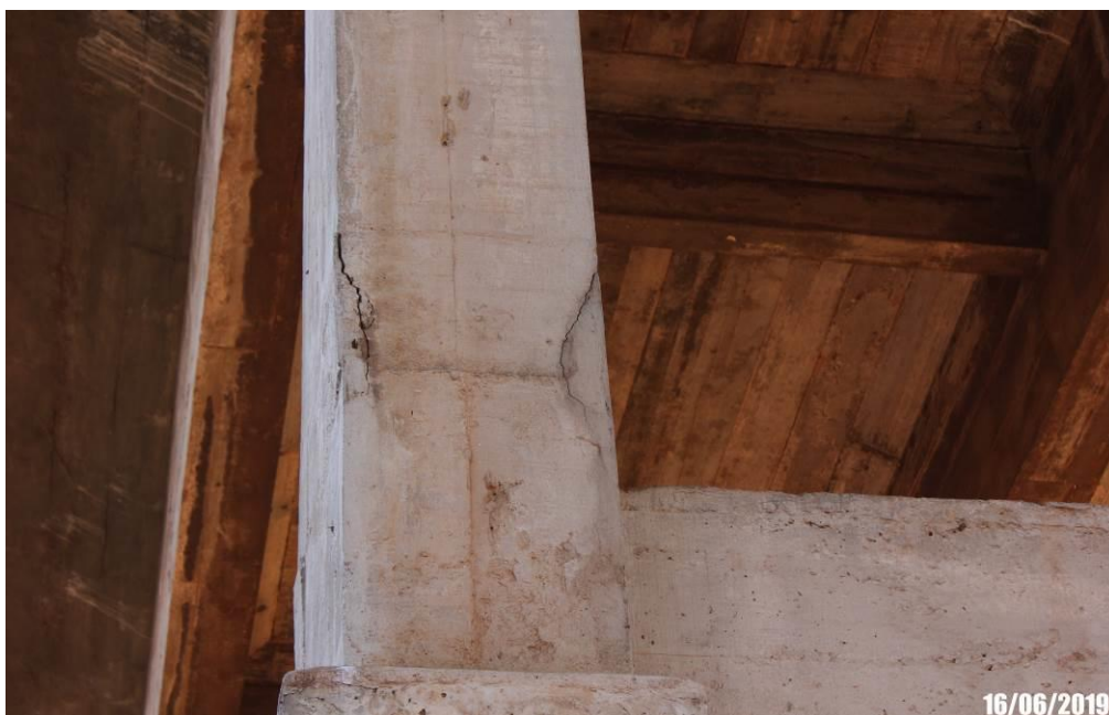
Foto 68: Detalhe de deslocamento de concreto em pilar.
