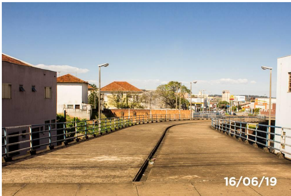
Foto 12- Vista do piso de concreto deteriorado.
