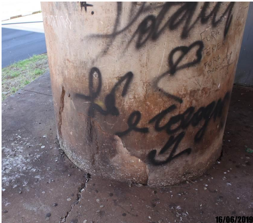
Foto 58: Detalhe de deslocamento de concreto.
