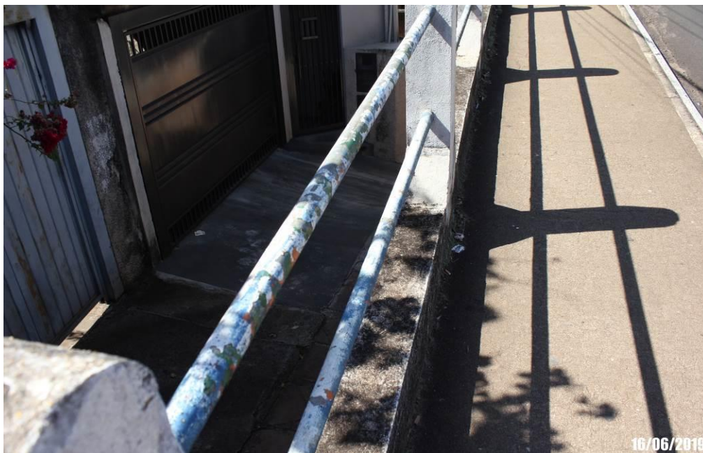
Foto 13: Detalhe da pintura do guarda corpo descascado.
