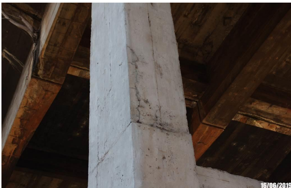
Foto 70: Detalhe de deslocamento de concreto.
