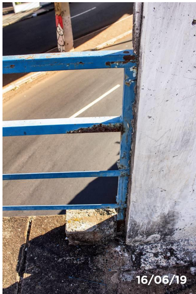
Foto 20: Detalhe do guarda corpo com corrosão.
