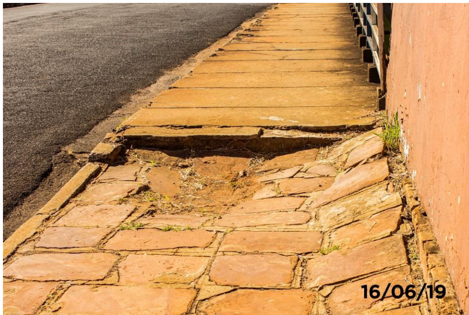
Foto 08: Detalhe da depressão no acesso ao passeio.
