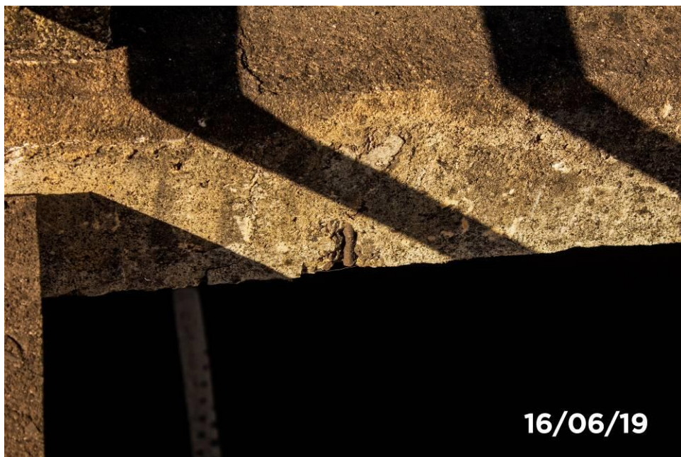
Foto 18: Detalhe armadura exposta laje do tabuleiro.
