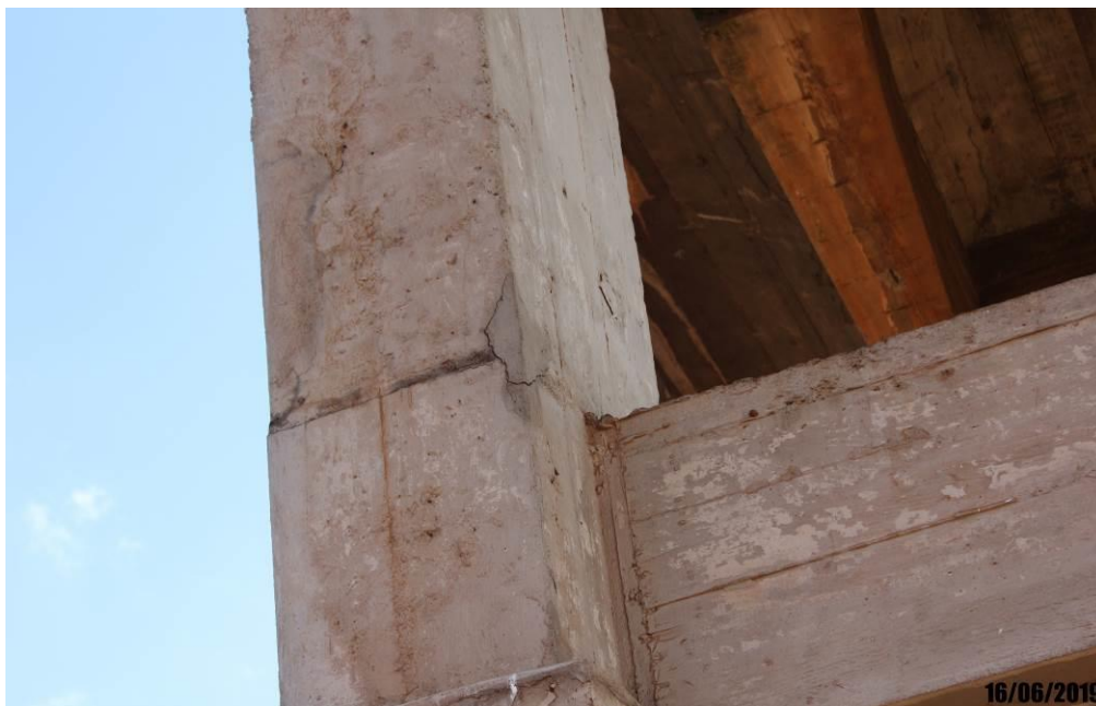
Foto 69: Detalhe de deslocamento de concreto em pilar.
