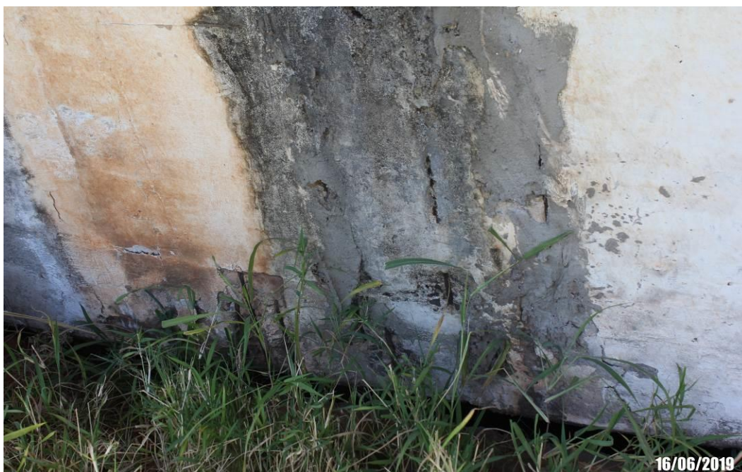
Foto 64: Detalhe de armadura exposta no muro ala.
