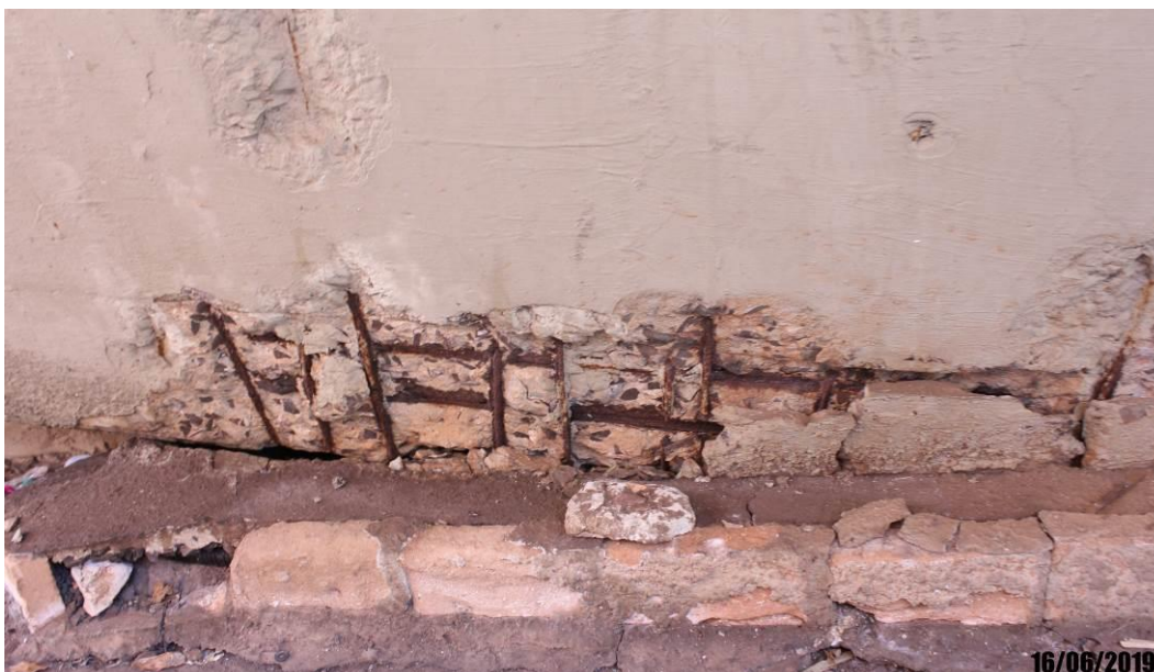
Foto 65: Detalhe de armadura exposta no muro ala.
