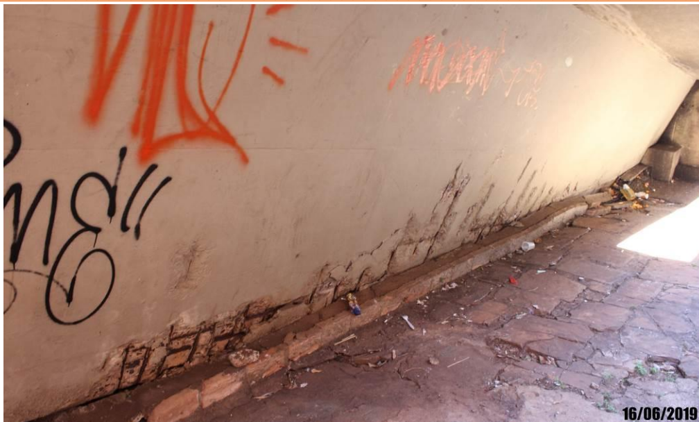
Foto 66: Detalhe de armadura exposta no muro ala.
