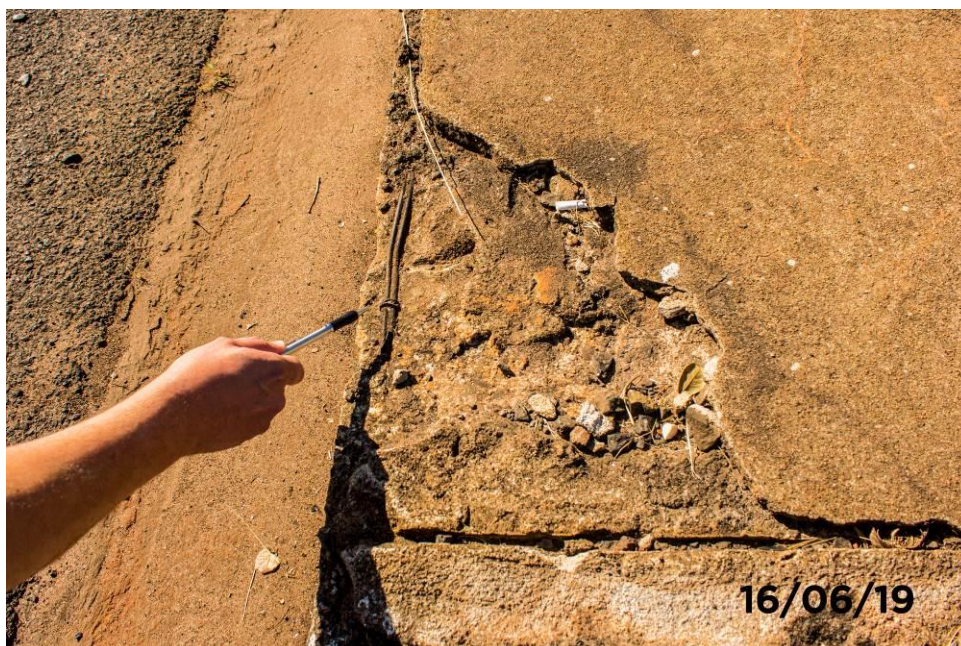
Foto 09: Detalhe da armadura exposta no passeio.
