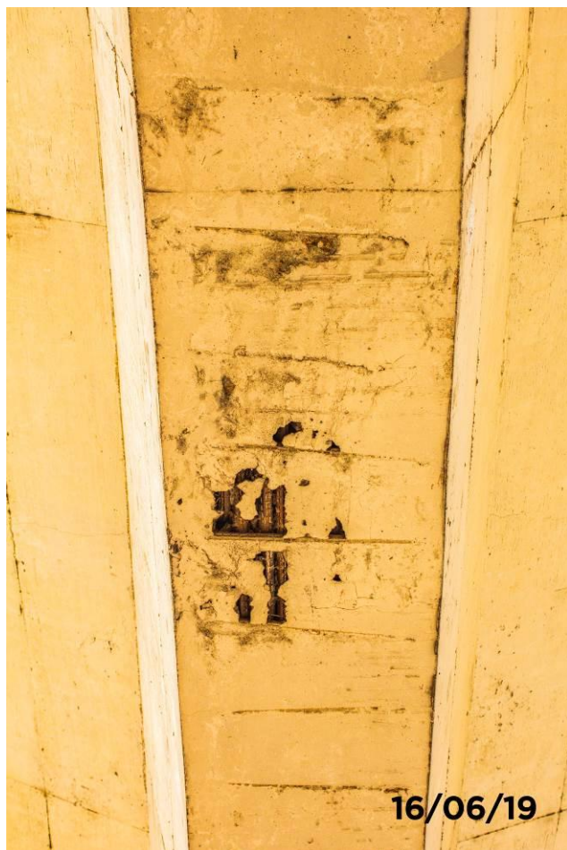
Foto 34 - Detalhe de armadura exposta na viga principal
