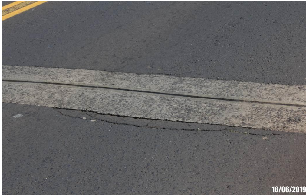
Foto 05: Face superior do tabuleiro apresentando fissuras.
