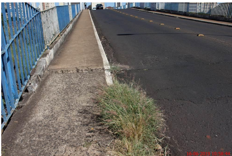
Foto 15: Detalhe do acesso ao passeio contendo desnível.
