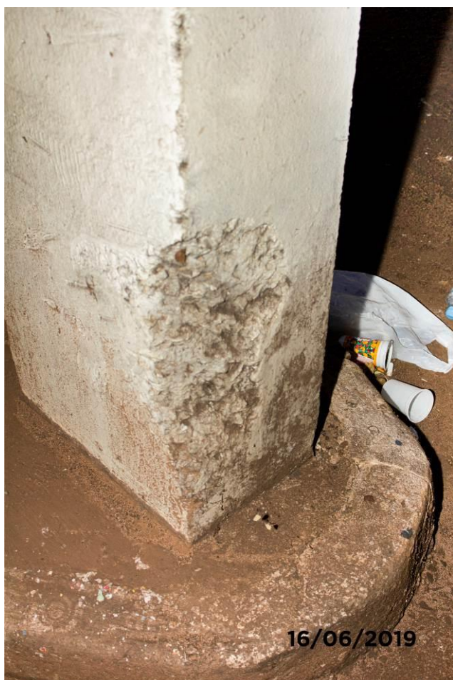
Foto 36: Deslocamento de concreto no pé do pilar.
