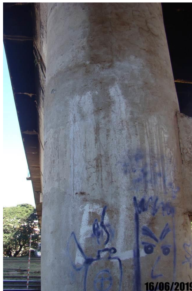
Foto 63: Detalhe de pequenas fissuras e eflorescência.
