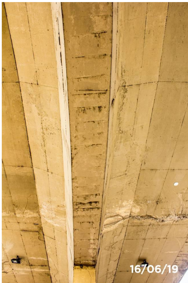
Foto 30 - Detalhe de eflorescência e armadura exposta.
