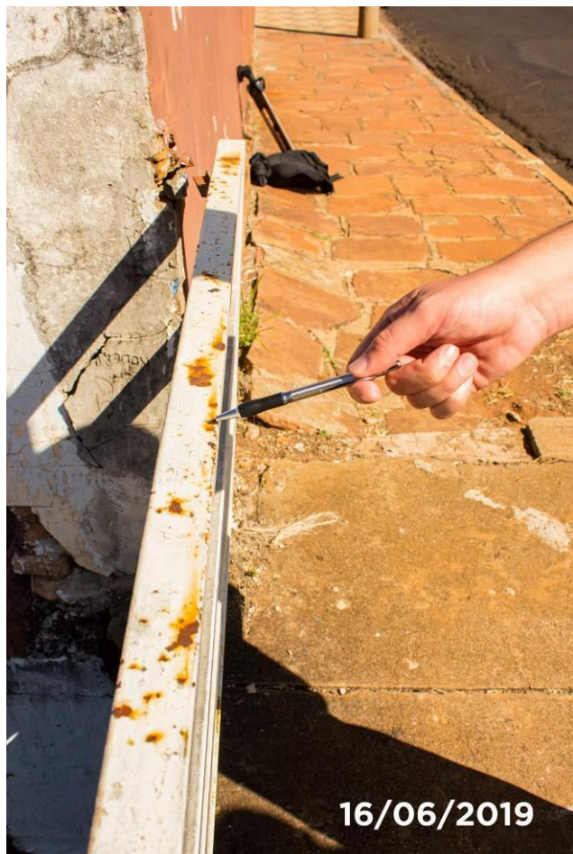
Foto 15: Detalhe do guarda corpo com corrosão.
