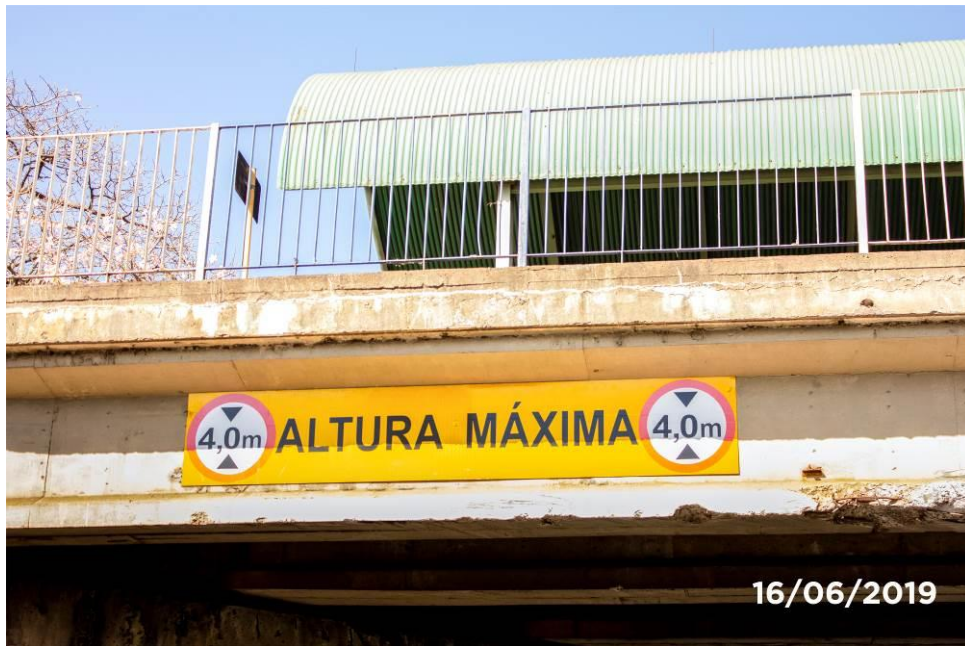
Foto 42: Sinalização de altura máxima.
