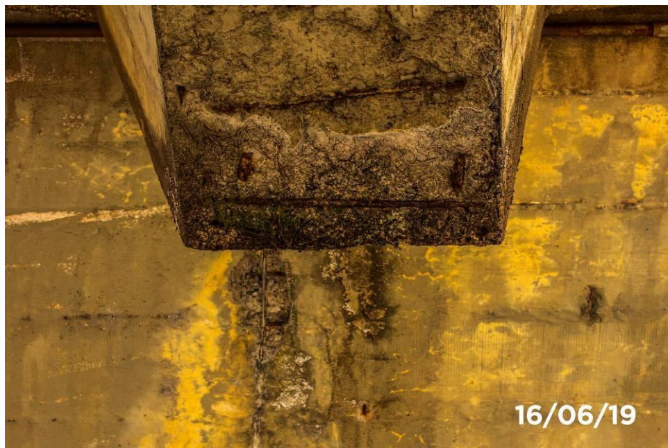
Foto 32- Detalhe de eflorescência e armadura exposta.
