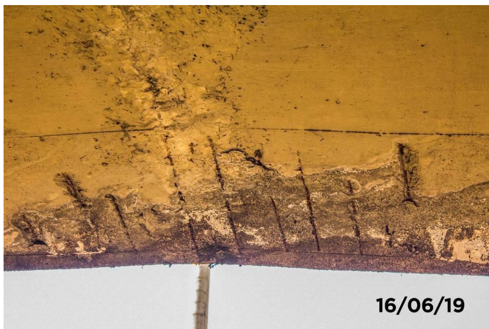
Foto 33- Detalhe de florescência e armadura exposta.
