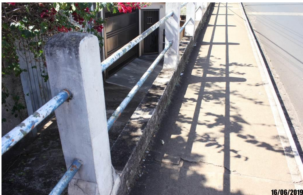
Foto 14: Detalhe da pintura do guarda corpo descascado.
