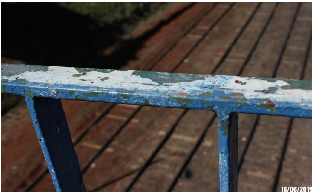
Foto 28: Detalhe da corrosão no guarda corpo.
