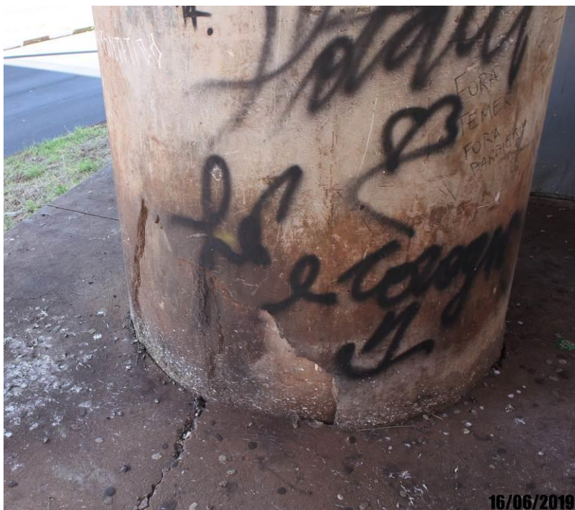
Foto 58: Detalhe de deslocamento de concreto.
