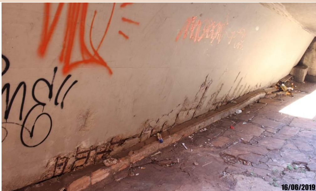
Foto 66: Detalhe de armadura exposta no muro ala.
