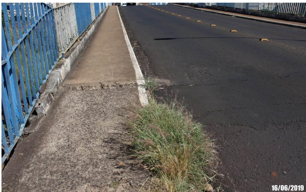
Foto 20: Detalhe da pintura do guarda corpo descolando.
