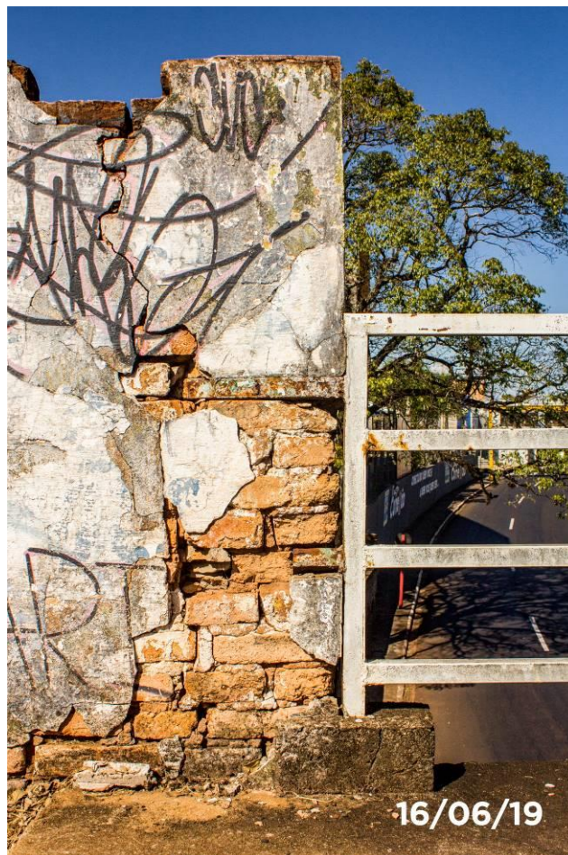
Foto 16: Detalhe do guarda corpo com corrosão.
