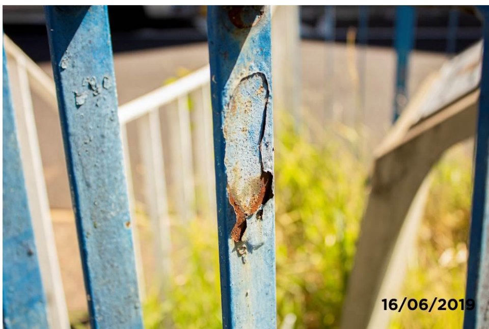
Foto 16: Detalhe da corrosão no guarda corpo.
