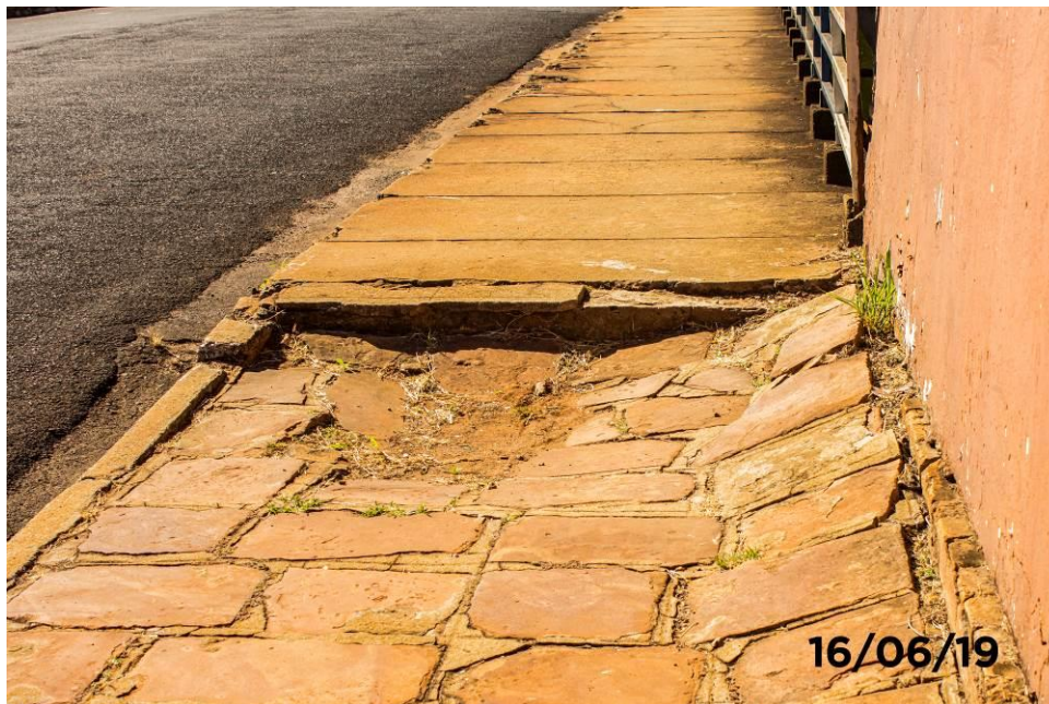
Foto 08: Detalhe da depressão no acesso ao passeio.
