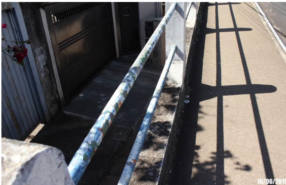
Foto 13: Detalhe da pintura do guarda corpo descascado.
