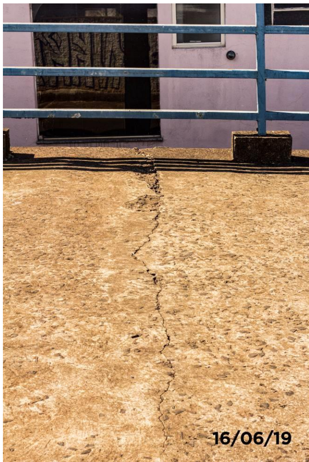
Foto 02 - Detalhe da rachadura e trincas no Tabuleiro.
