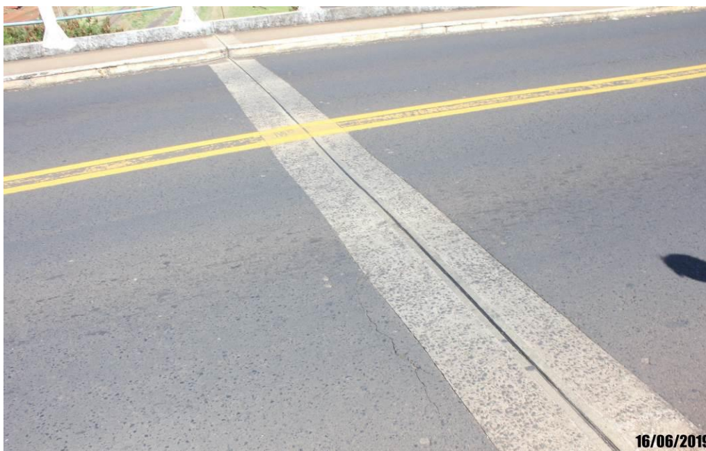
Foto 10: Detalhe do lábio polimérico do pavimento danificado.
