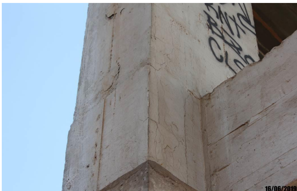
Foto 72: Detalhe de deslocamento de concreto.
