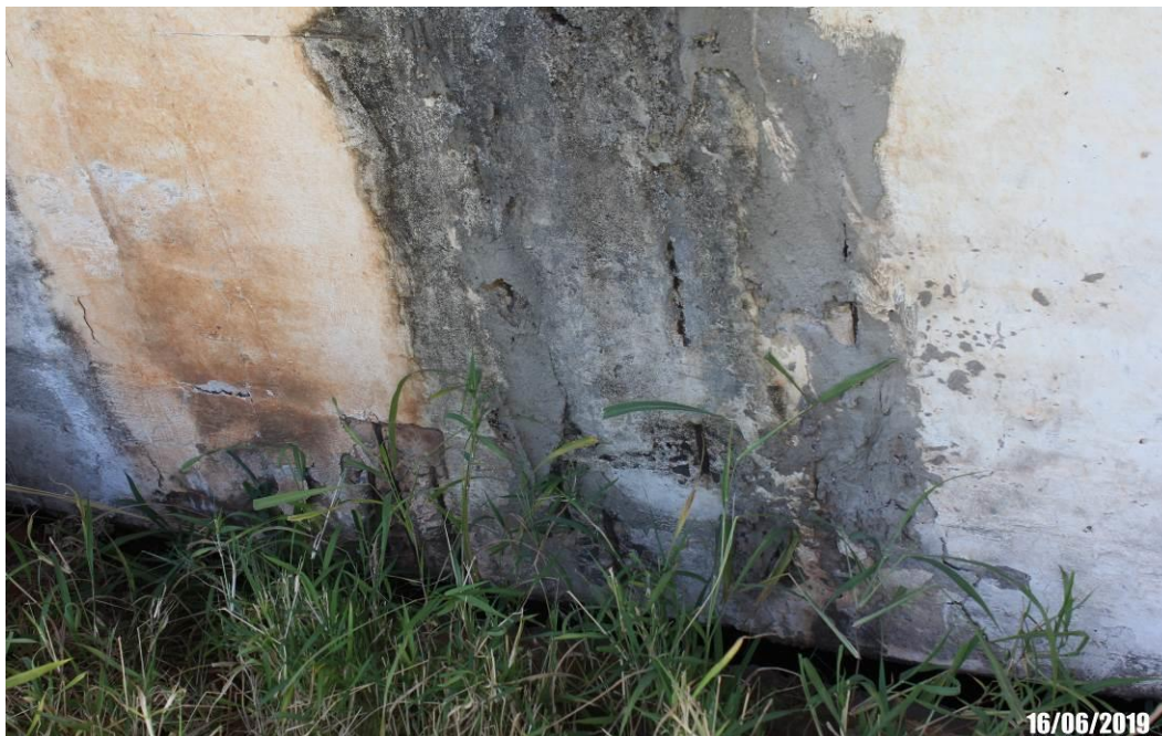
Foto 64: Detalhe de armadura exposta no muro ala.
