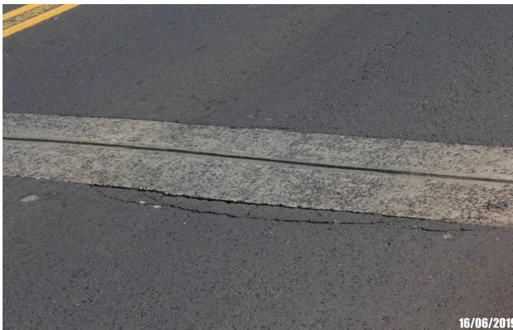
Foto 05: Face superior do tabuleiro apresentando fissuras.
