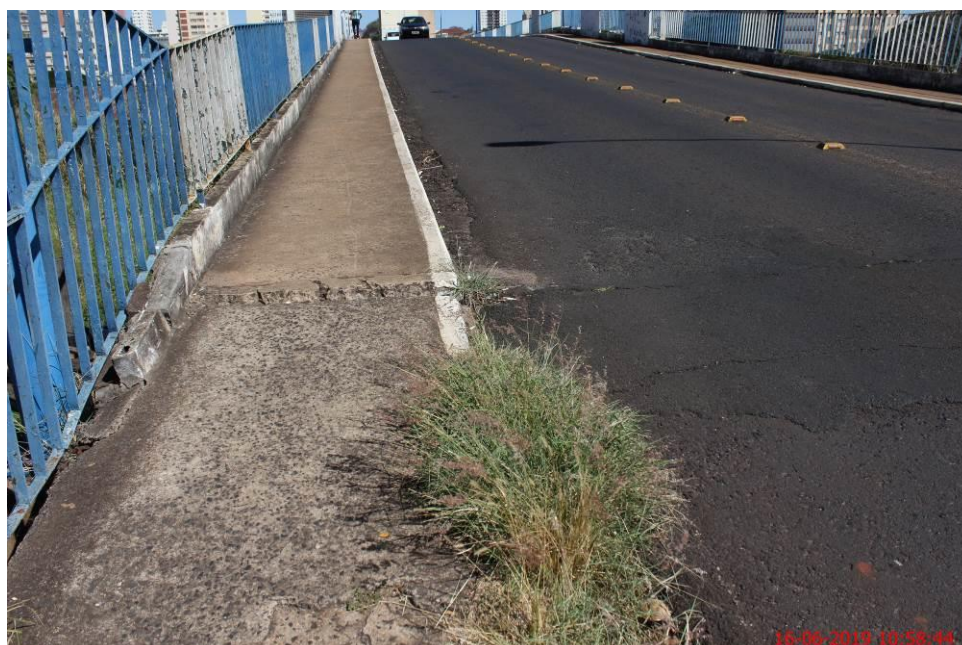
Foto 15: Detalhe do acesso ao passeio contendo desnível.
