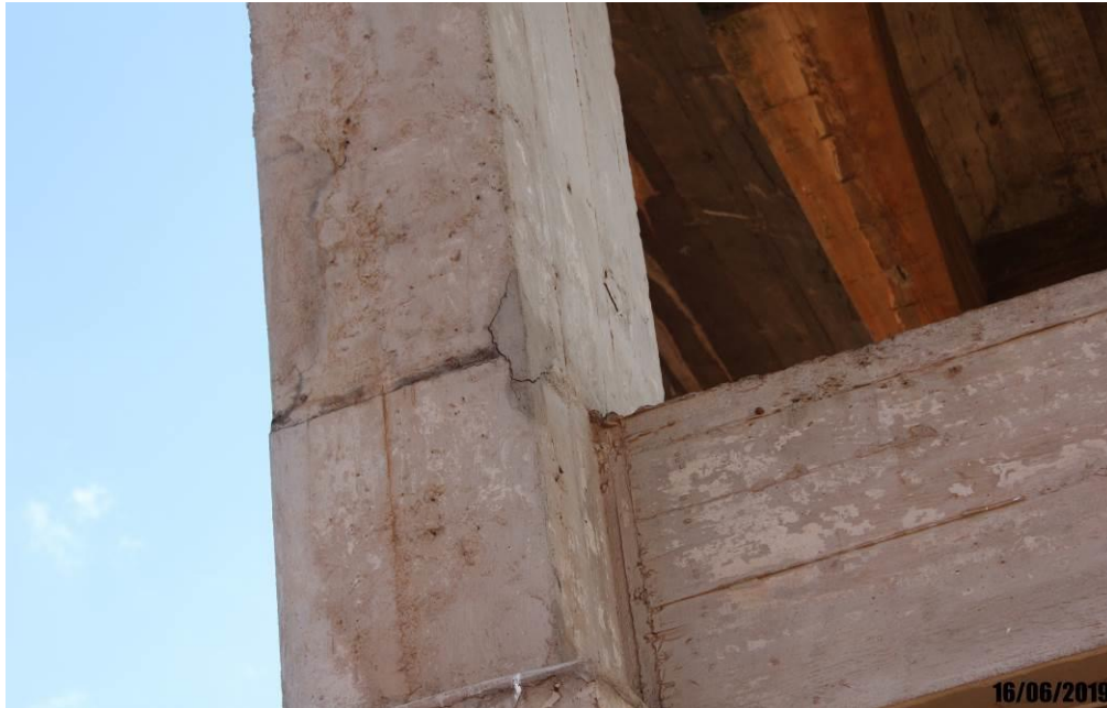
Foto 69: Detalhe de deslocamento de concreto em pilar.
