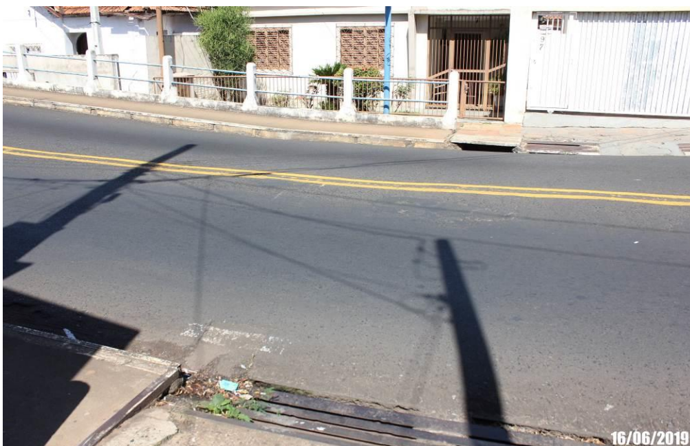
Foto 04: Detalhe dos calombos no pavimento flexível.
