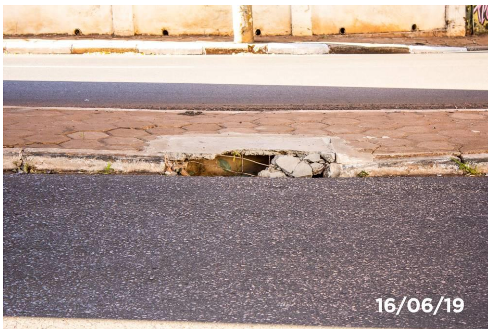
Foto 48- Detalhe boca de lobo danificada e obstruída.
