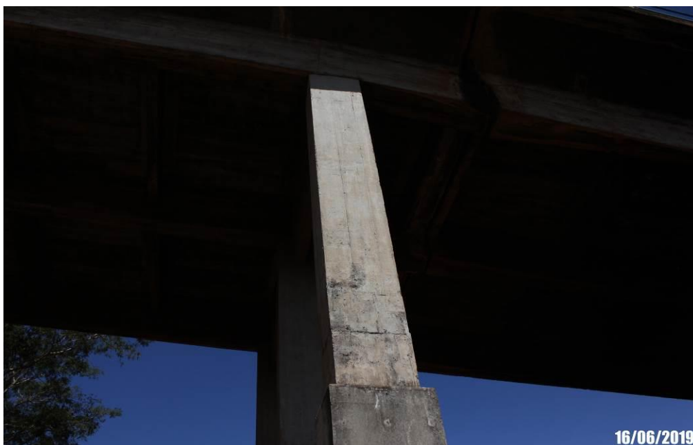
Foto 67: Detalhe de deslocamento de concreto em pilar.
