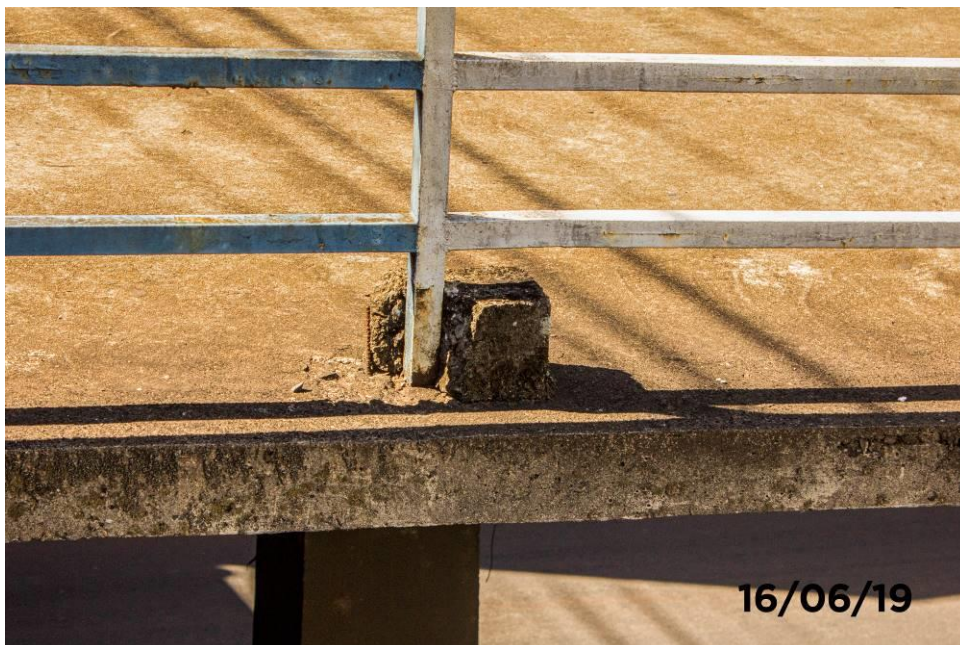
Foto 04- Ponto de fixação da guarda corpo Danificado.
