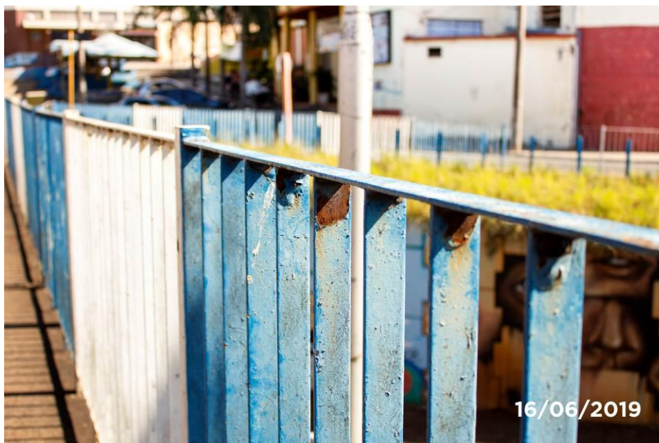
Foto 14: Detalhe da corrosão no guarda corpo.
