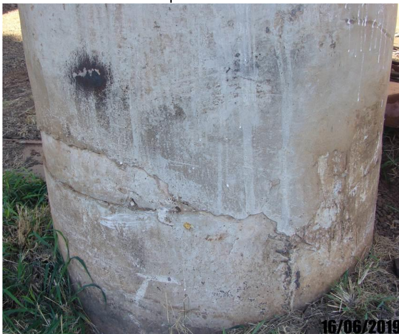
Foto 59: Detalhe de deslocamento de concreto.
