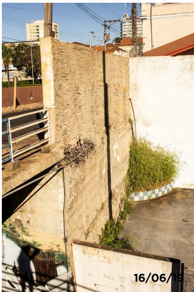
Foto 45: Detalhe da vegetação no muro de arrimo.
