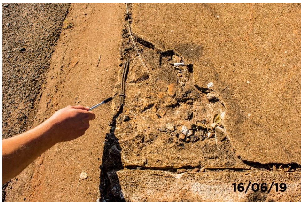
Foto 09: Detalhe da armadura exposta no passeio.
