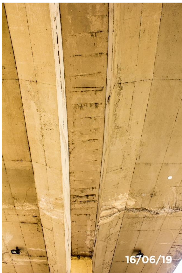
Foto 30 - Detalhe de eflorescência e armadura exposta.
