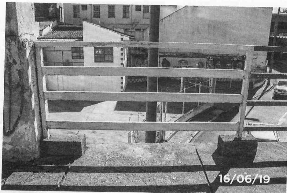
Foto 17: Detalhe guarda corpo com corrosão.
