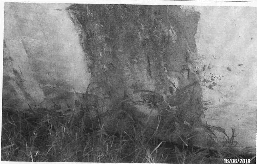
Foto 64: Detalhe de armadura exposta no muro ala.
