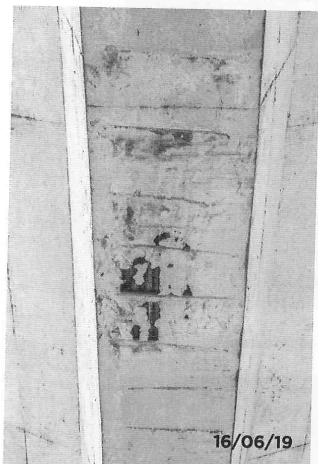
Foto 34 - Detalhe de armadura exposta na viga principal
