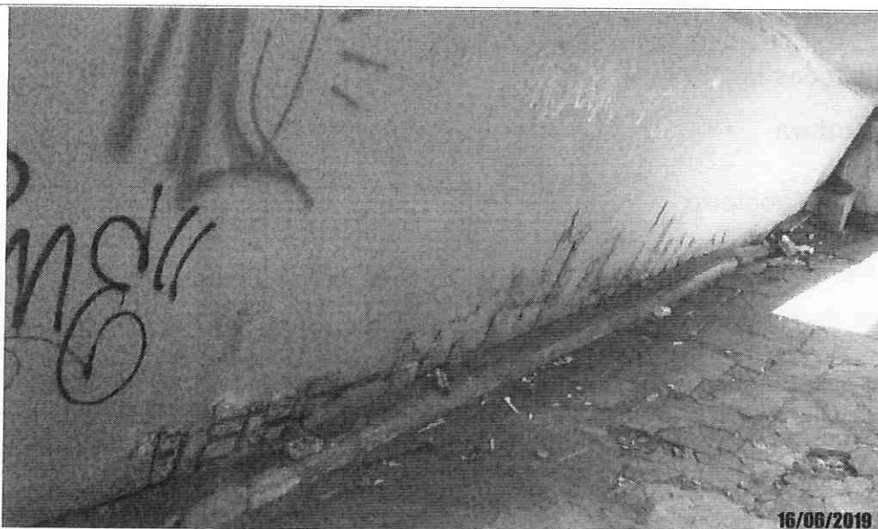
Foto 66: Detalhe de armadura exposta no muro ala.
