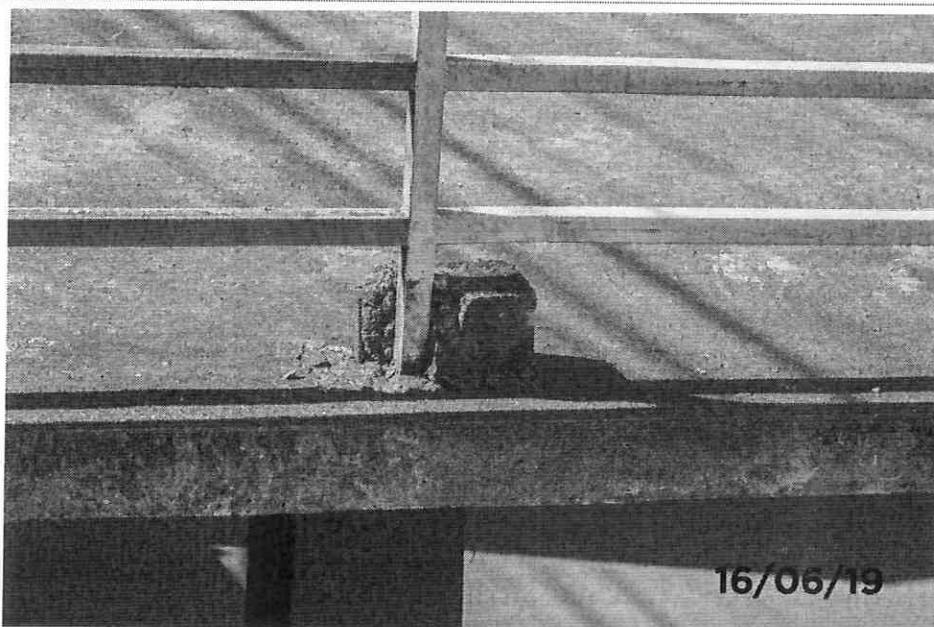
Foto 04- Ponto de fixação da guarda corpo Danificado.
