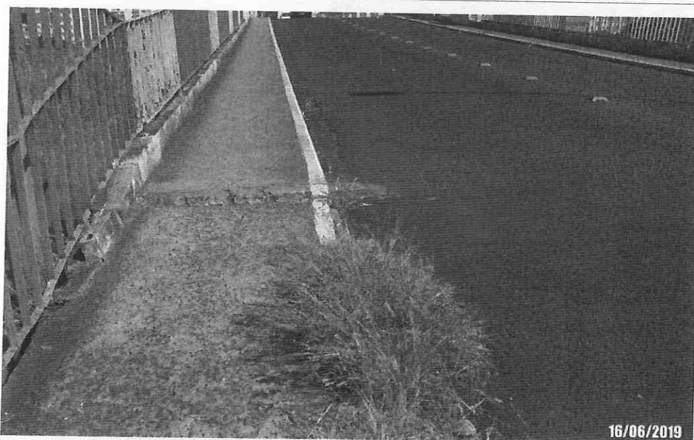
Foto 20: Detalhe da pintura do guarda corpo descolando.
