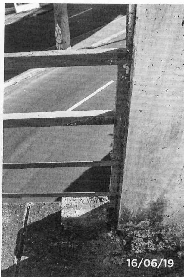
Foto 20: Detalhe do guarda corpo com corrosão.
