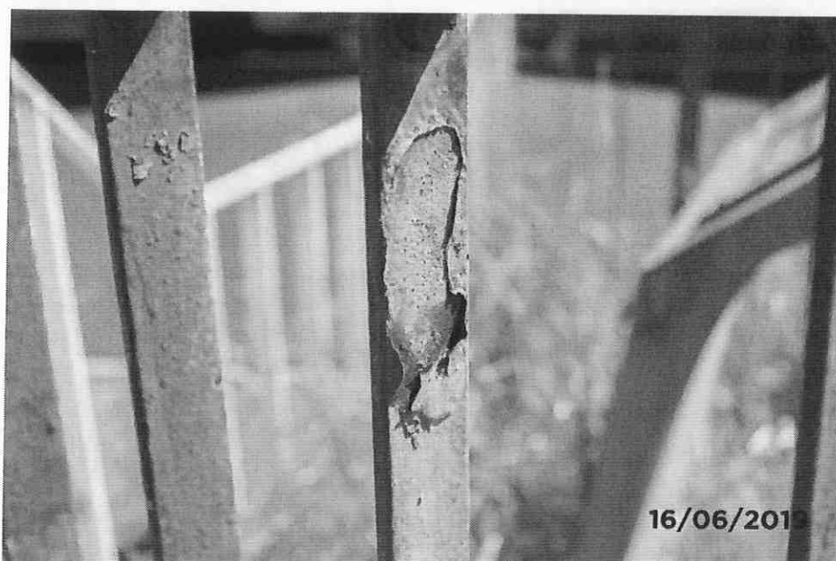
Foto 16: Detalhe da corrosão no guarda corpo.
