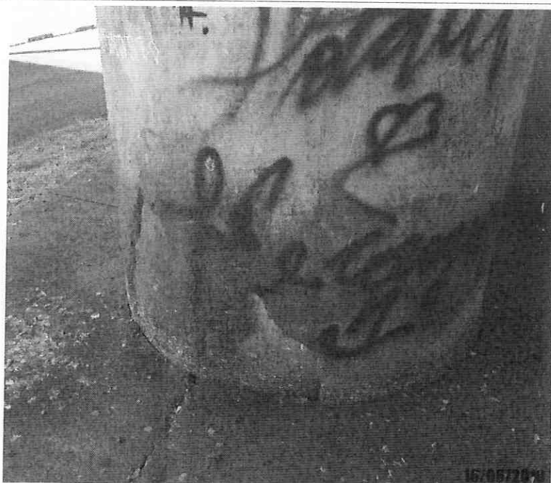
Foto 58: Detalhe de deslocamento de concreto.
