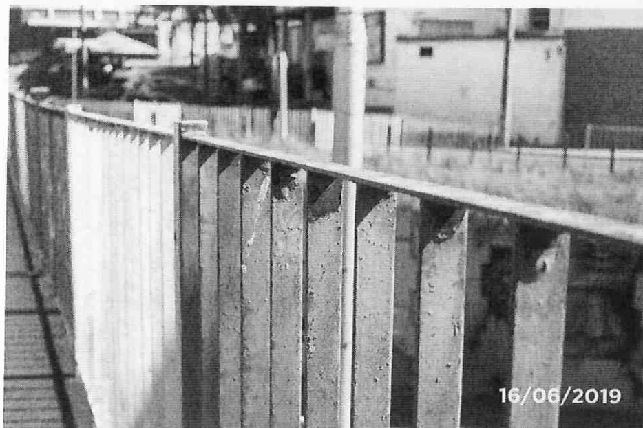
Foto 14: Detalhe da corrosão no guarda corpo.
