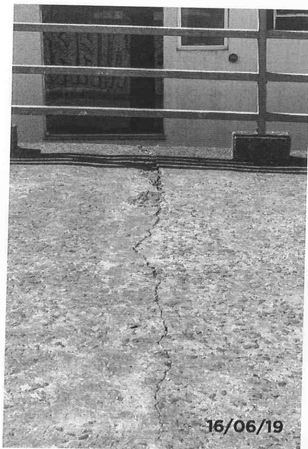
Foto 02 - Detalhe da rachadura e trincas no Tabuleiro.
