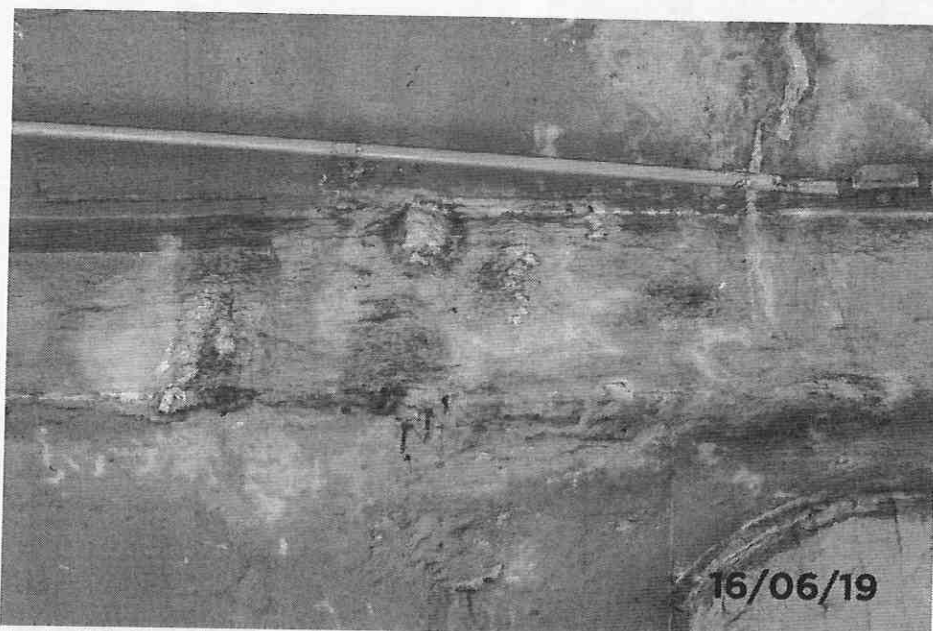
Foto 32: Detalhe de eflorescência.
