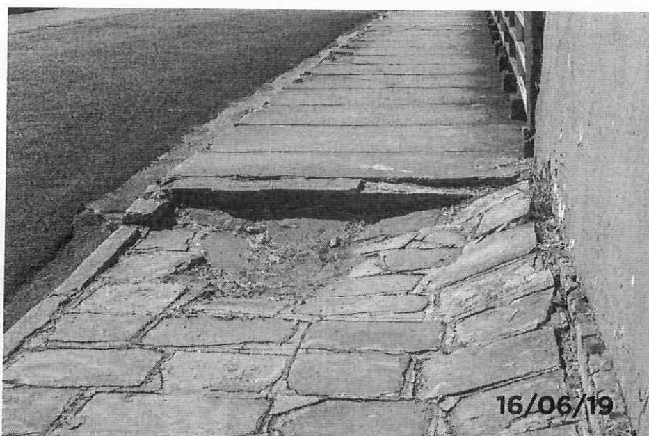
Foto 08: Detalhe da depressão no acesso ao passeio.
