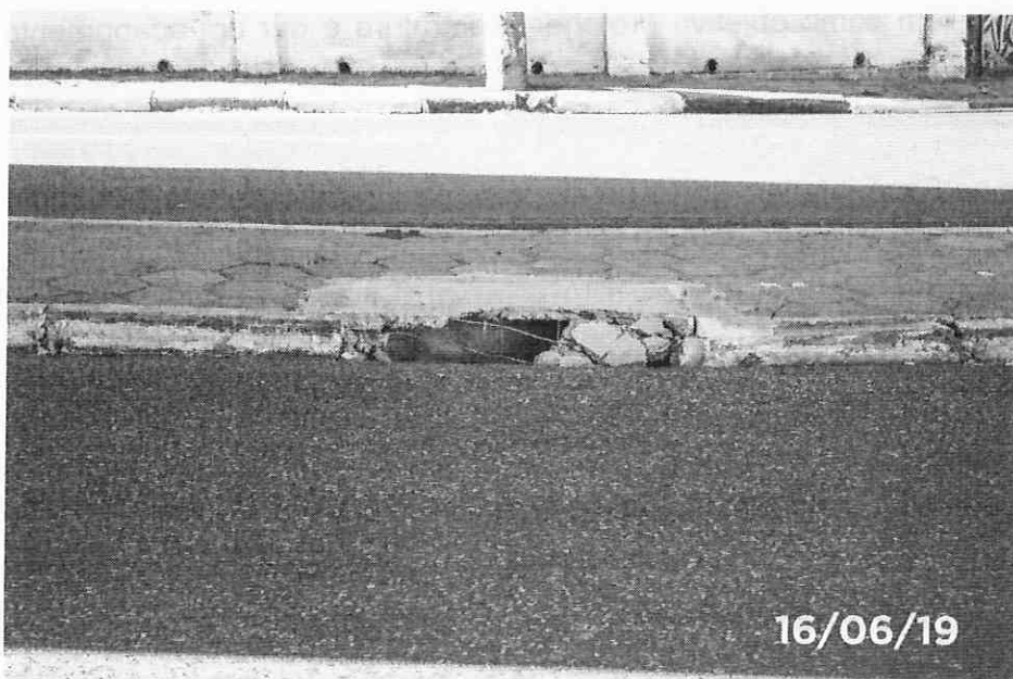
Foto 48- Detalhe boca de lobo danificada e obstruída.
