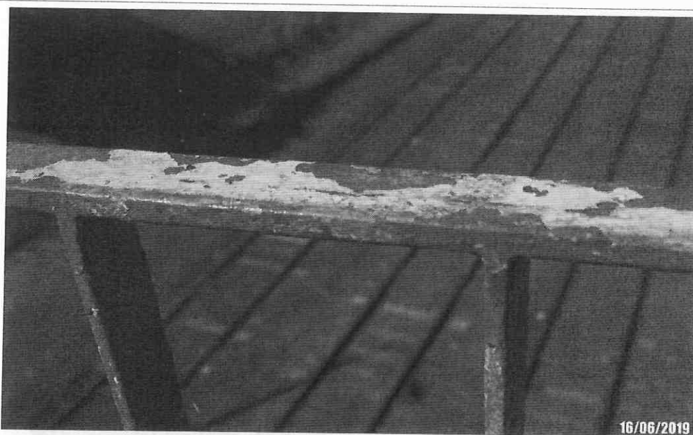
Foto 28: Detalhe da corrosão no guarda corpo.
