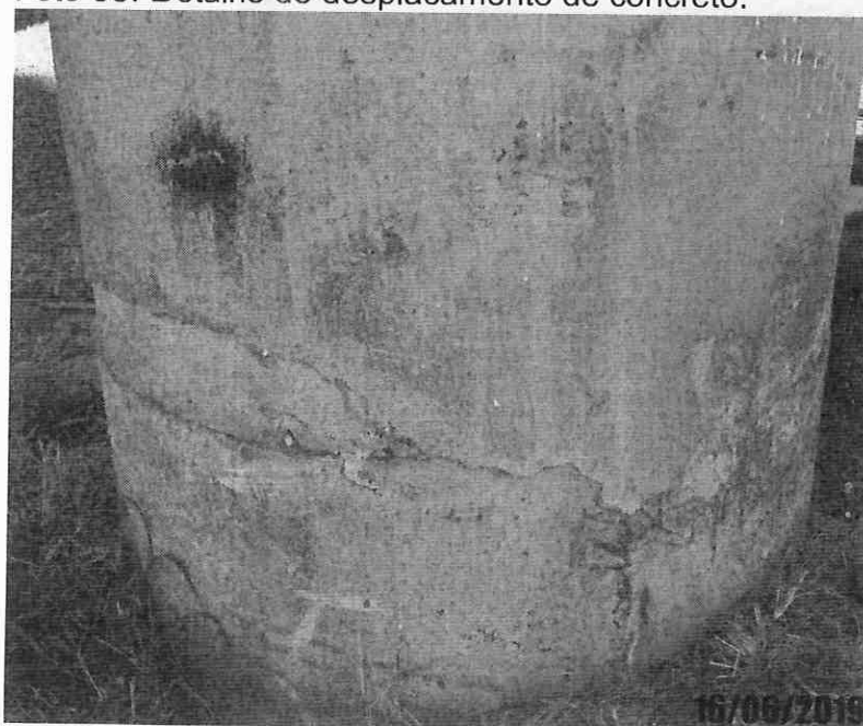
Foto 59: Detalhe de deslocamento de concreto.
