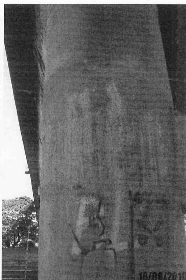
Foto 63: Detalhe de pequenas fissuras e eflorescência.
