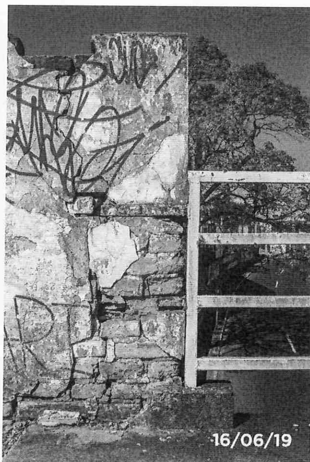
Foto 16: Detalhe do guarda corpo com corrosão.
