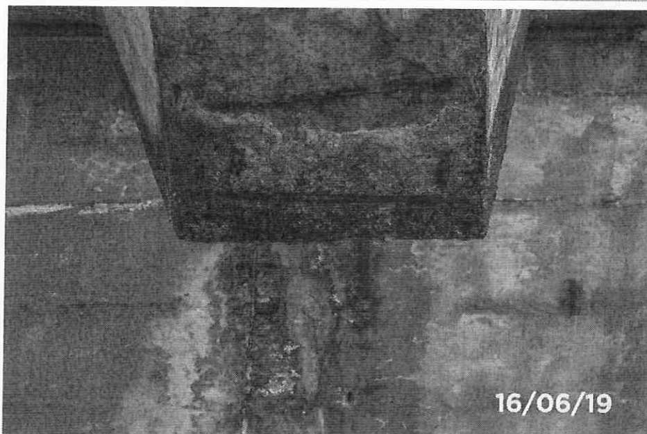
Foto 32- Detalhe de eflorescência e armadura exposta.
