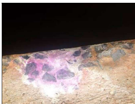
Vista da aspersão da solução de fenolftaleína em parede
