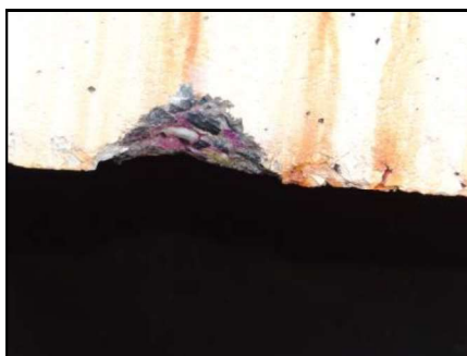
Vista da aspersão da solução de fenolftaleína na face interna da laje de cobertura
