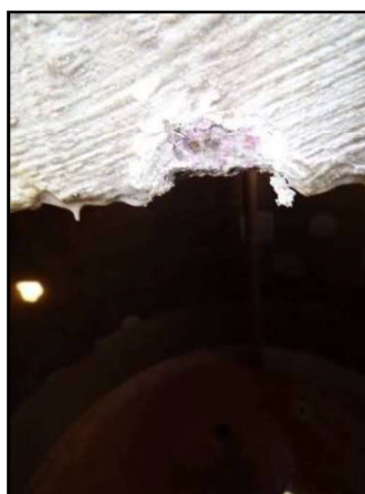
Vista da aspersão da solução de fenolftaleína em parede
