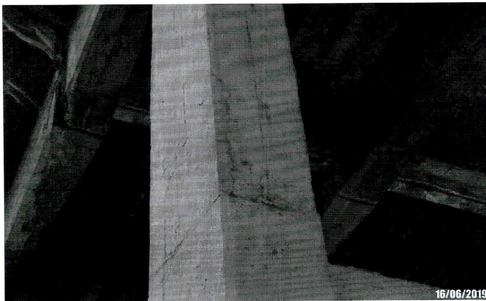
Foto 70: Detalhe de deslocamento de concreto.
