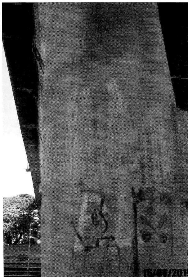
Foto 63: Detalhe de pequenas fissuras e eflorescência.
