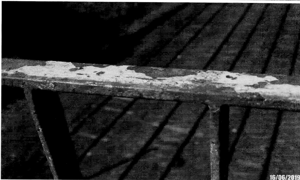
Foto 28: Detalhe da corrosão no guarda corpo.
