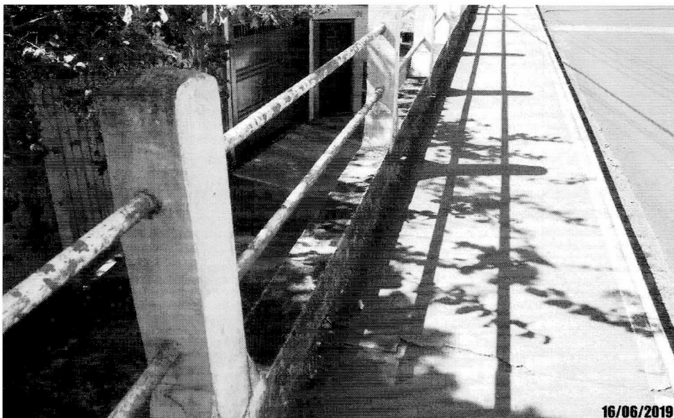
Foto 14: Detalhe da pintura do guarda corpo descascado.
