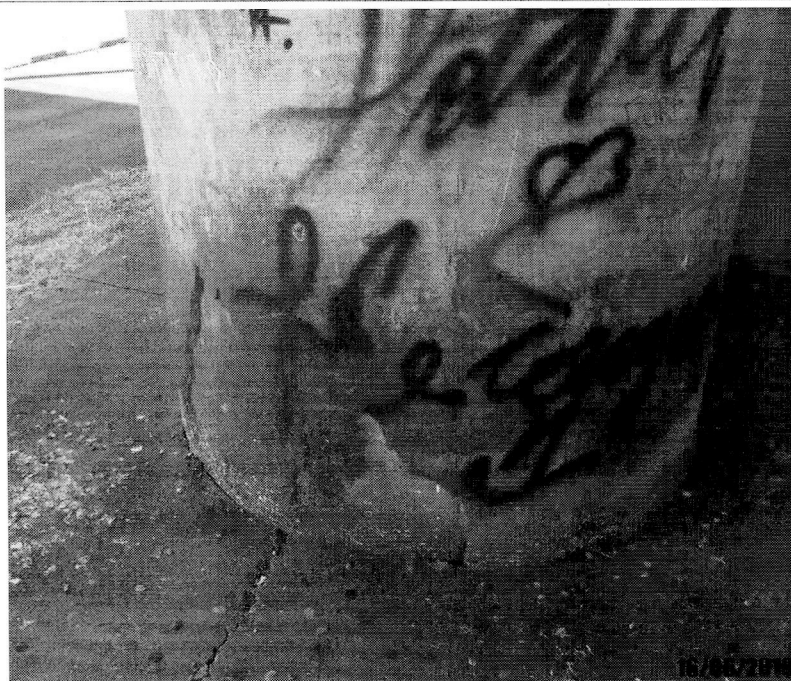
Foto 58: Detalhe de deslocamento de concreto.
