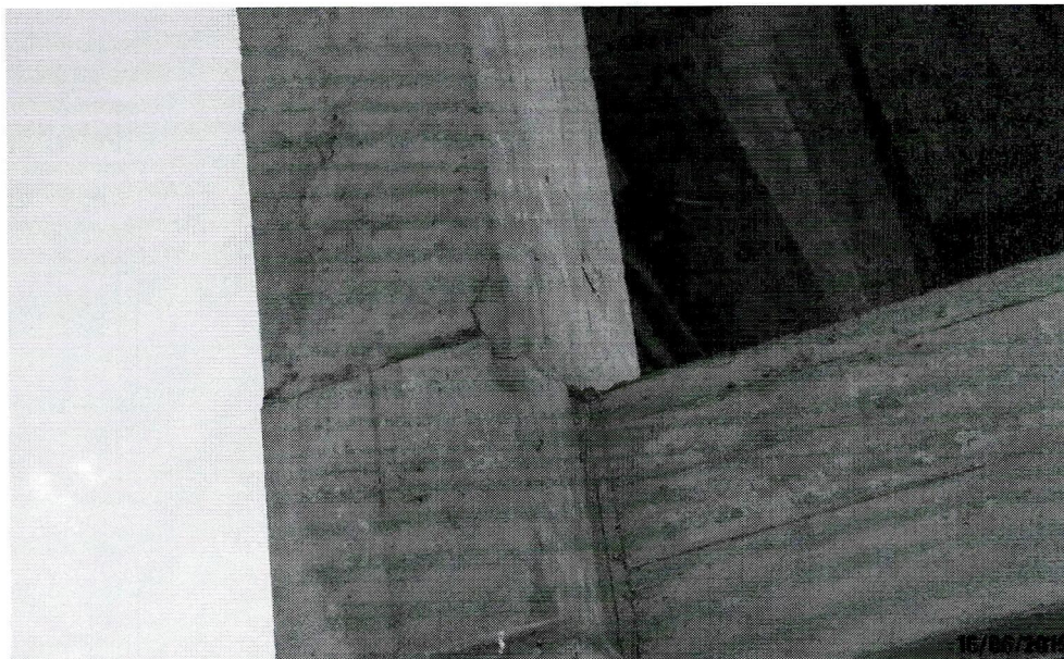
Foto 69: Detalhe de deslocamento de concreto em pilar.
