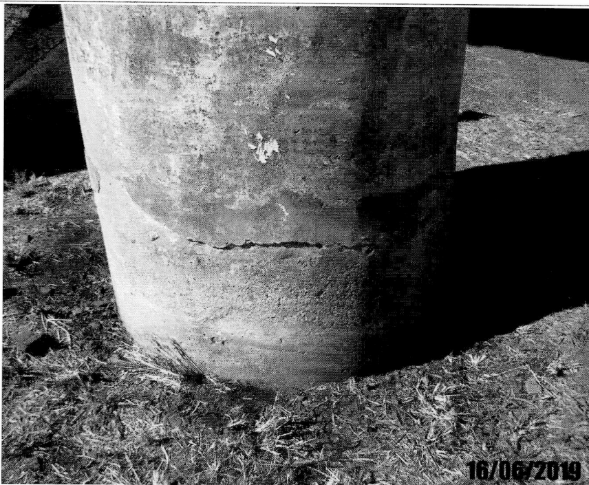
Foto 60: Detalhe de deslocamento de concreto.
