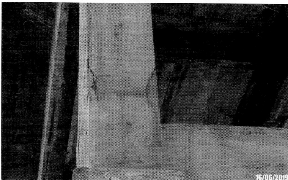
Foto 68: Detalhe de deslocamento de concreto em pilar.
