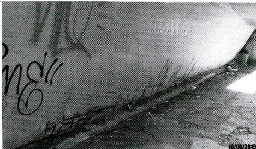
Foto 66: Detalhe de armadura exposta no muro ala.
