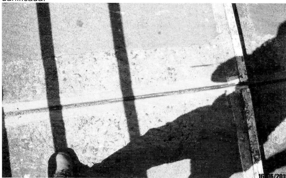
Foto 12: Detalhe de armadura exposta nos lábios poliméricos.
