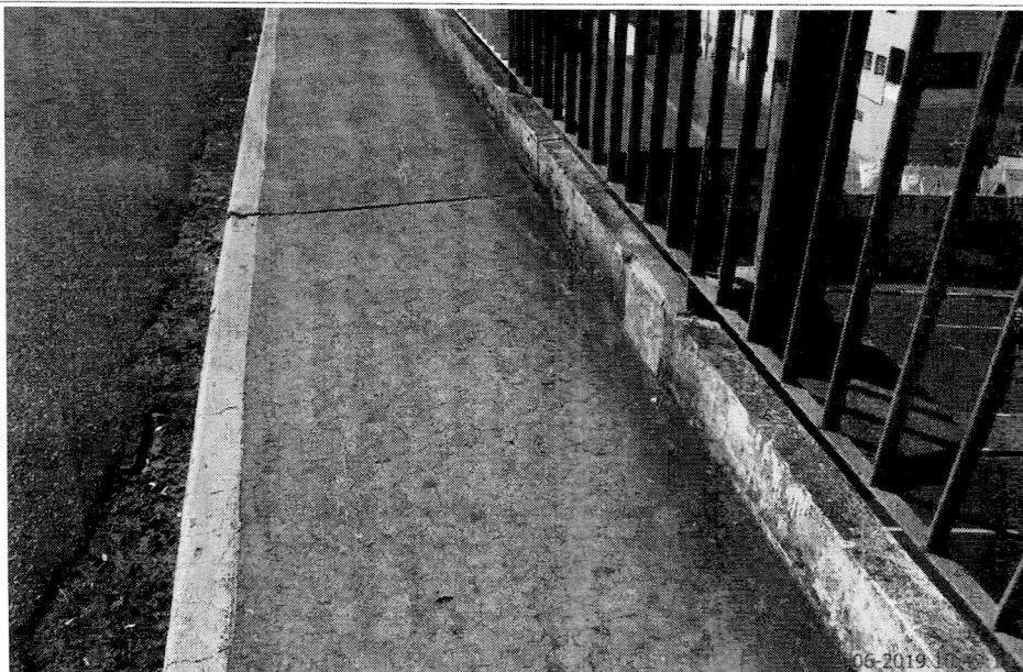
Foto 14: Detalhe das fissuras no passeio.
