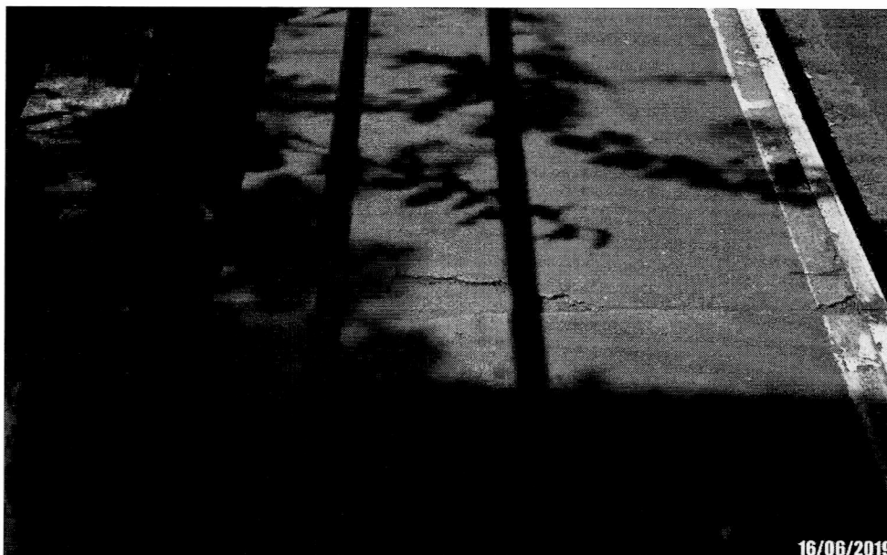
Foto 21: Detalhe de deslocamento de concreto no passeio.
