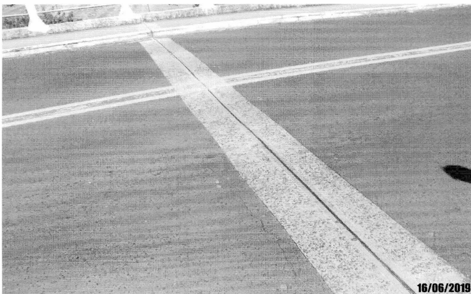
Foto 06: Face superior do tabuleiro apresentando fissuras.
