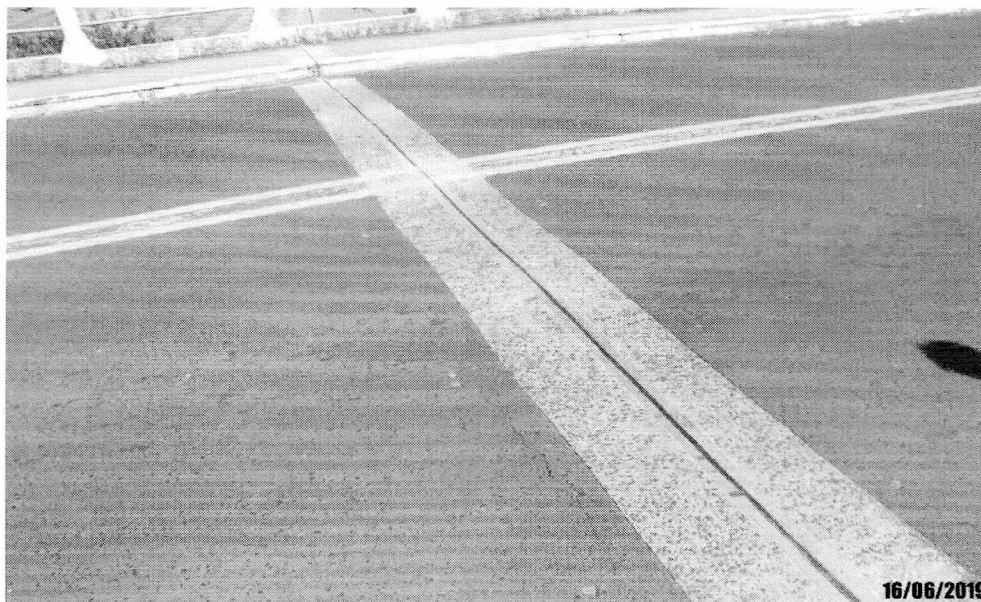
Foto 10: Detalhe do lábio polimérico do pavimento danificado.
