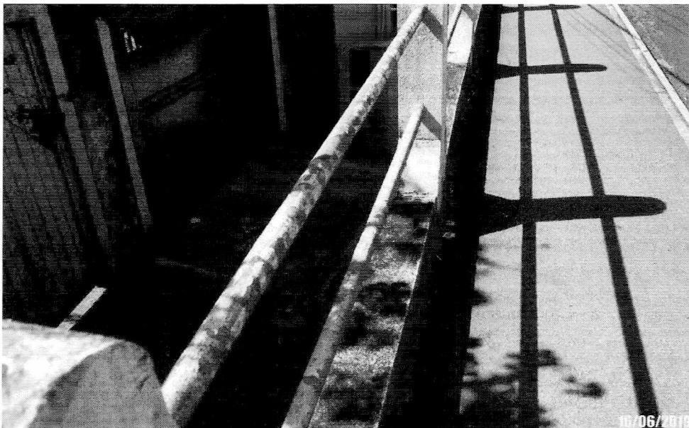
Foto 13: Detalhe da pintura do guarda corpo descascado.
