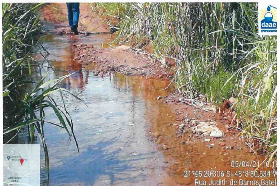
Foto 14: Vista da estrada de terra sobre o córrego do Serralhal e Área de Preservação – APP a montante da Travessia executada (vide PONTO 2 na imagem 1), e obstrução da tubulação de drenagem fluvial naquele ponto.
