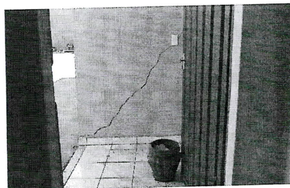
Trinca parede do refeitório
