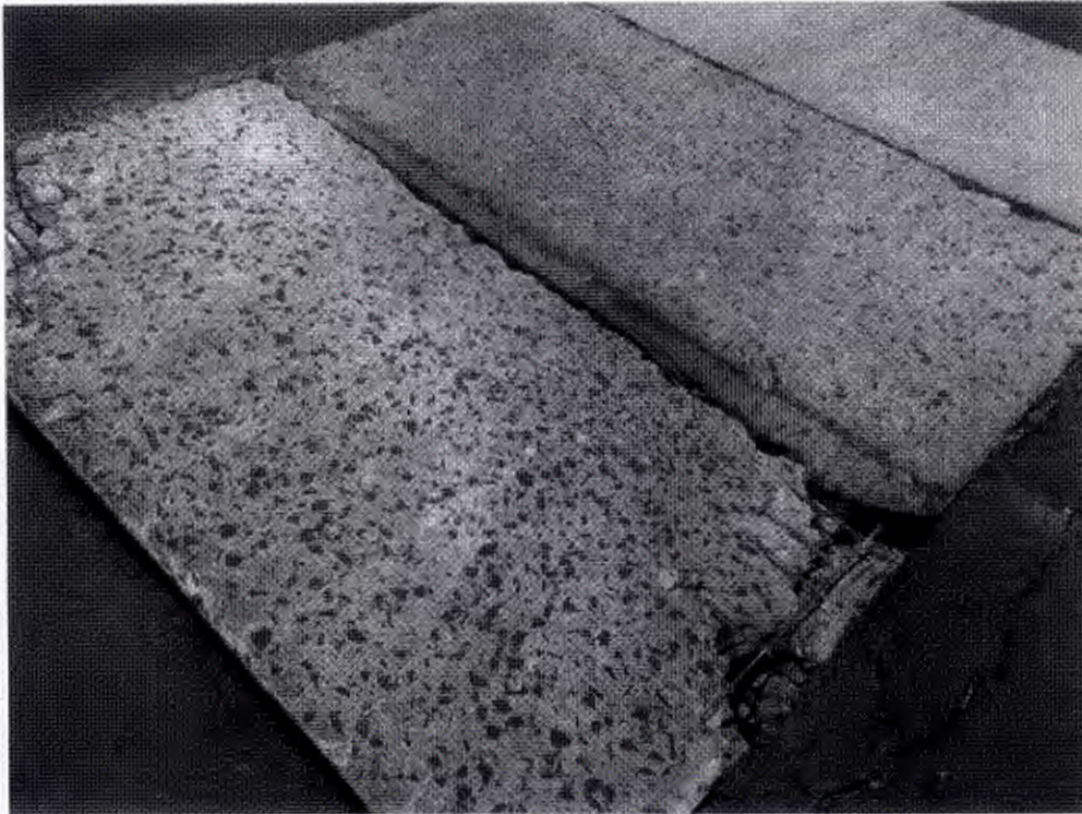
Tampa de concreto no pátio quebrada, risco de acidente.
