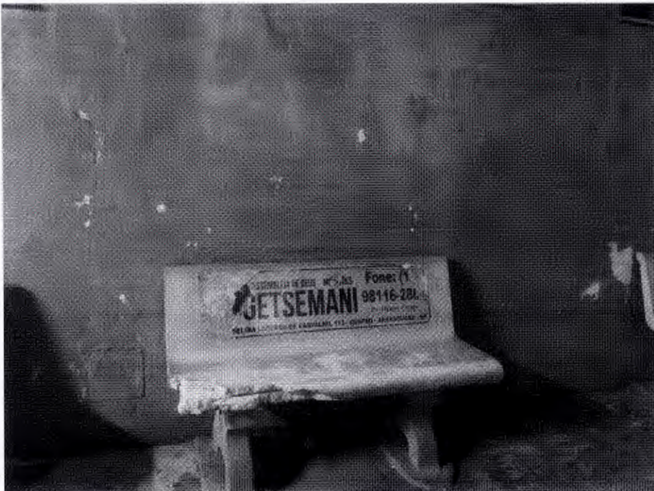
Banco de concreto danificado, risco de acidentes.
