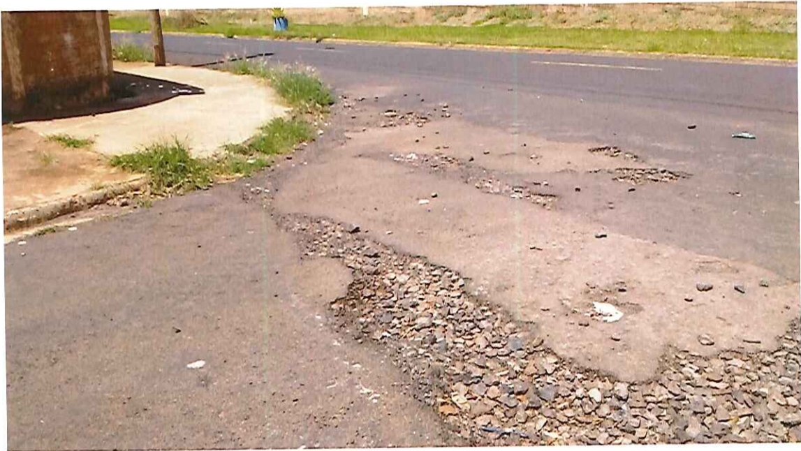
210 05112015 Tapa buraco Avenida Maia Moralles- Jd. Imperador
